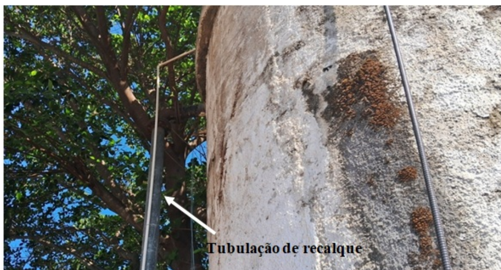
Foto 1 – Tubulação de recalque DN 100 mm F°F°
