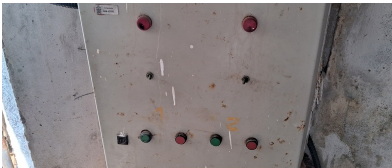
Foto 14 – Vista externa do painel de controle
