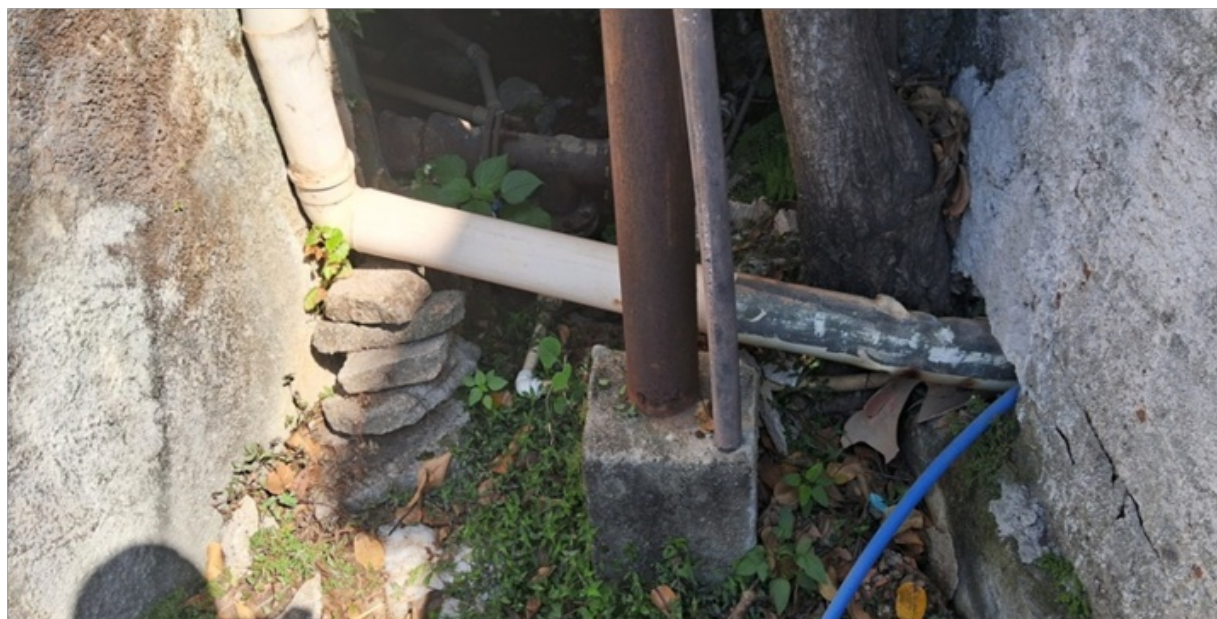
Foto 3 – Tubulação extravasora DN 100 mm de PVC
