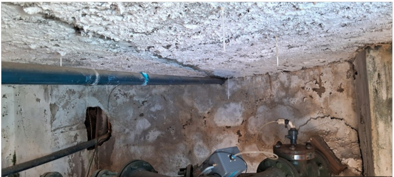
Foto 20 – Interior do abrigo da elevatória
