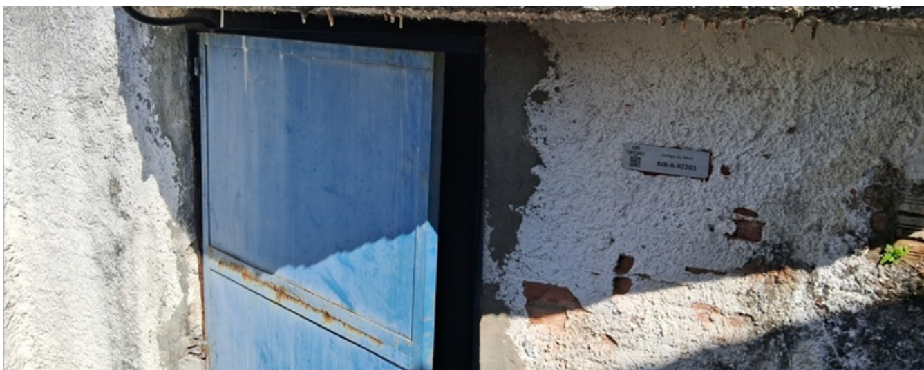
Foto 17 – Ferrugem no meio da porta
