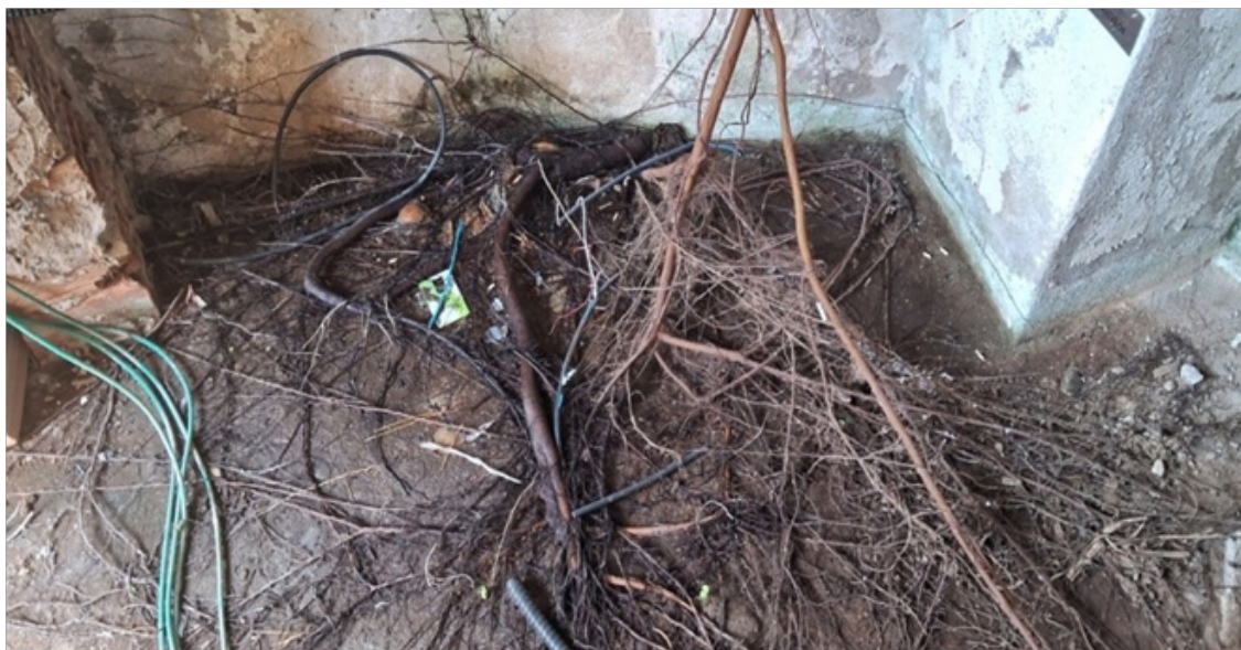
Foto 16 – Vegetação no chão do abrigo da elevatória
