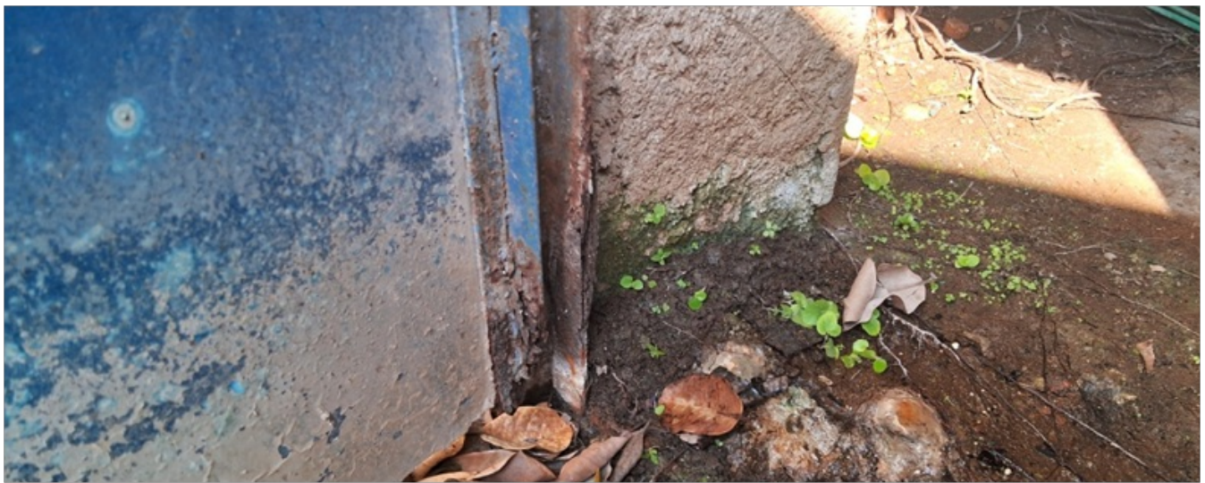
Foto 18 – Ferrugem na base da porta e do caixilho
