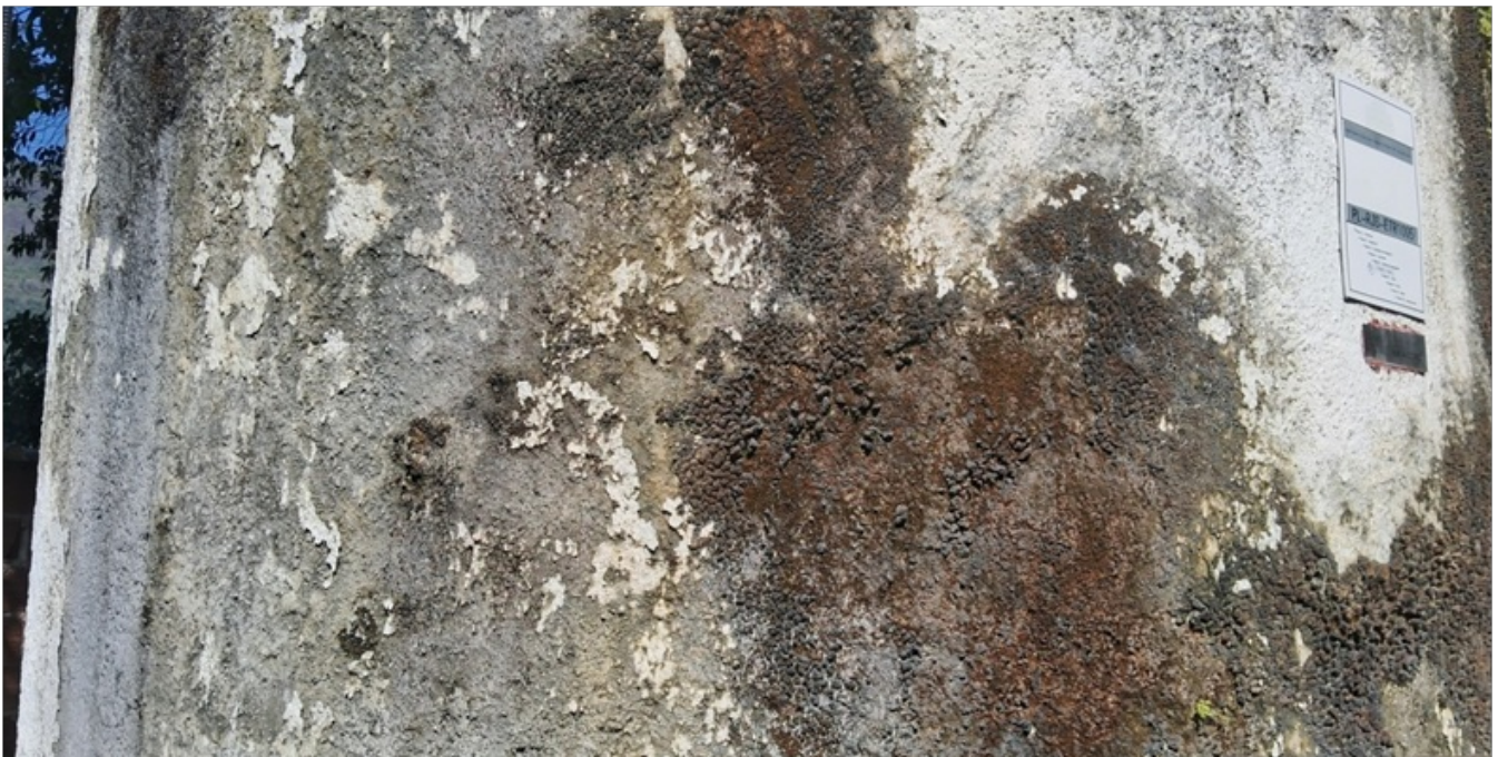
Foto 6 – Vazamento na parede
