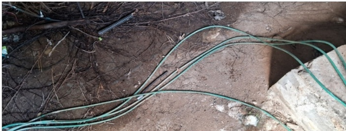
Foto 15 – Fiação exposta no chão do abrigo da elevatória
