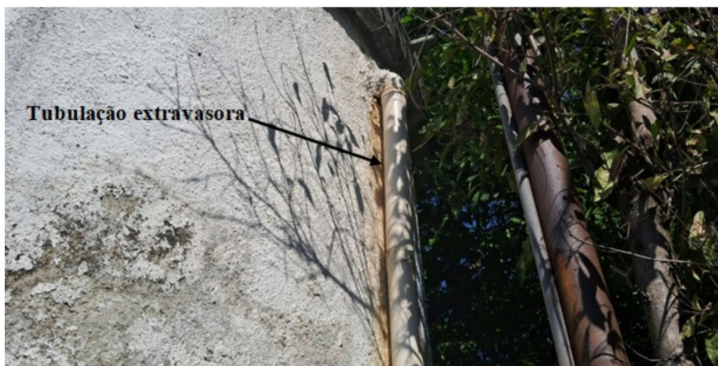
Foto 2 – Tubulação extravasora DN 100 mm de PVC
