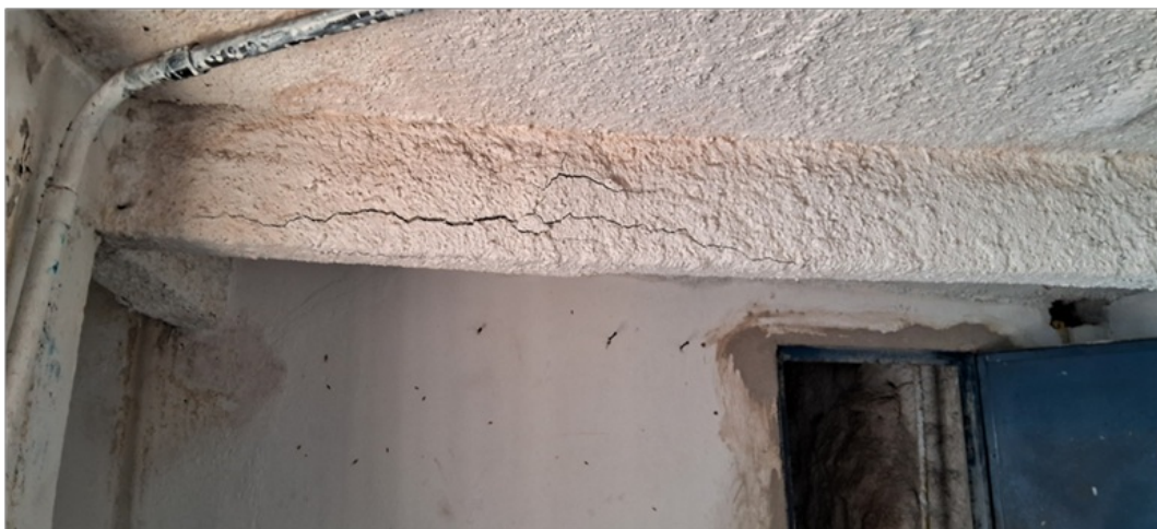
Foto 6 – Rachadura em uma das vigas da casa de bombas.
