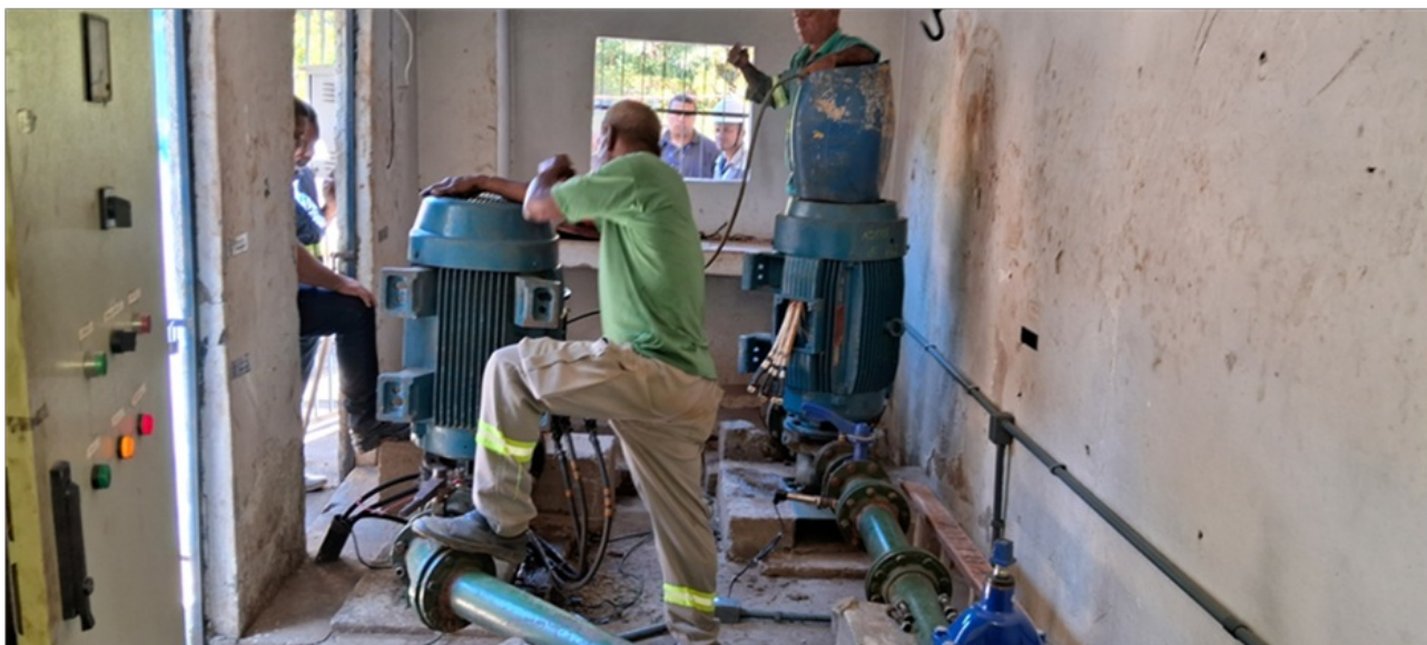
Foto 4 – Vista do interior da casa de bombas.
