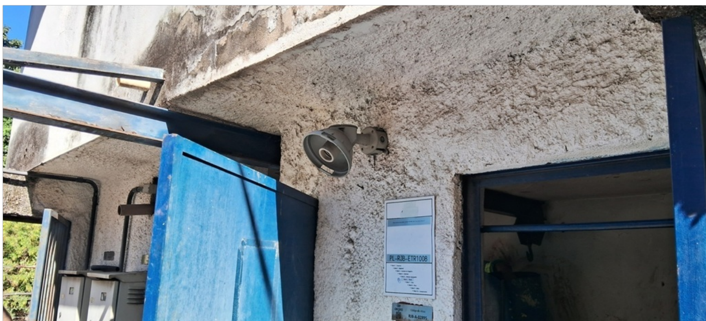
Foto 10 – Luminária sem lâmpada na área de entrada na casa de bombas.
