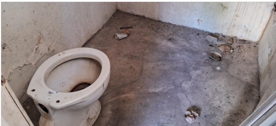
Foto 9 – Banheiro sem condições da uso na estação elevatória.
