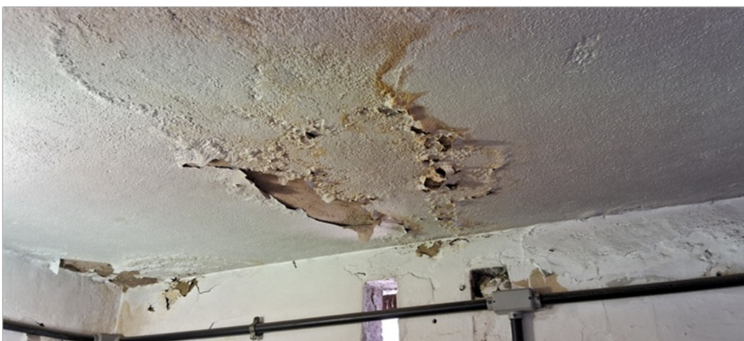
Foto 7 – Marcas de infiltração na laje da casa de bombas.
