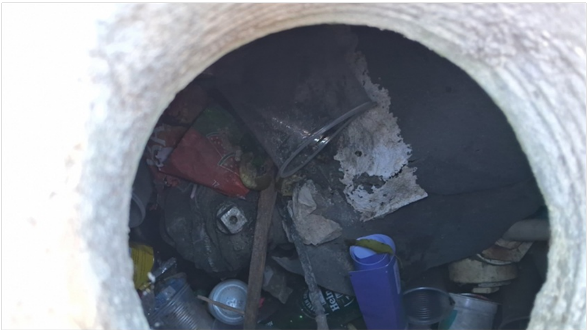
Foto 15 - Vista do interior da caixa do registro da tubulação que alimenta o poço de sucção, onde há acúmulo de resíduos.
