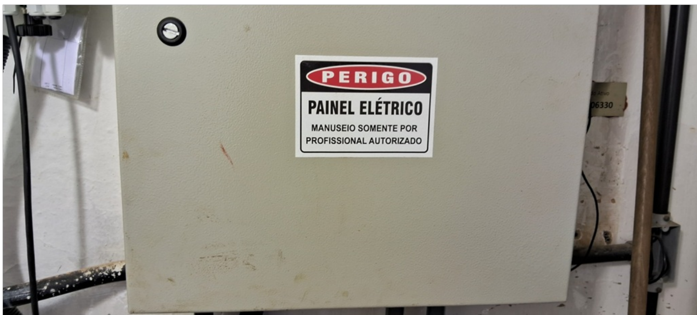
Foto 11 – PAINEL elétrico com aviso de perigo.
