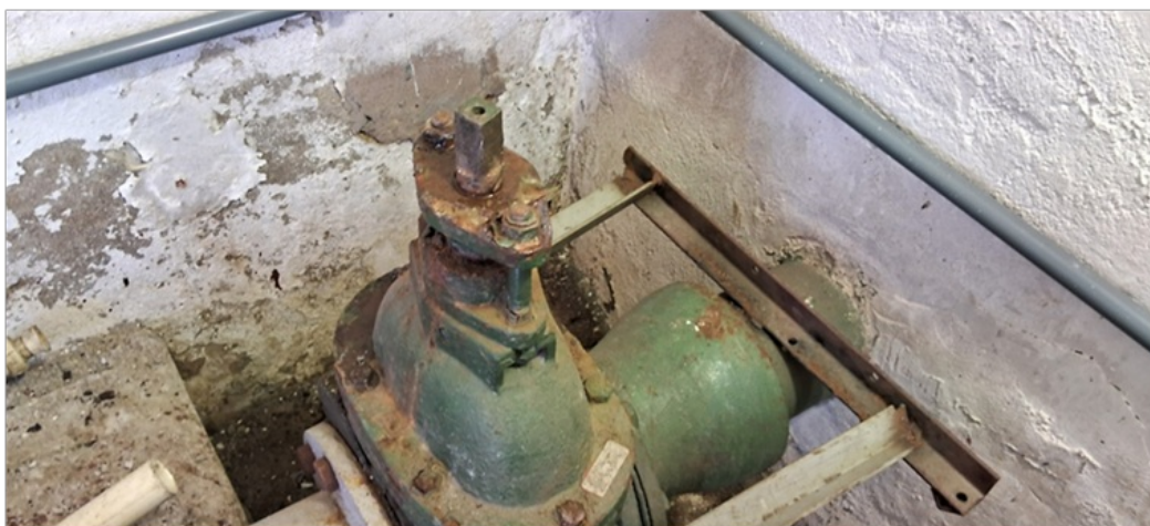
Foto 5 – Válvula de bloqueio com vazamento.
