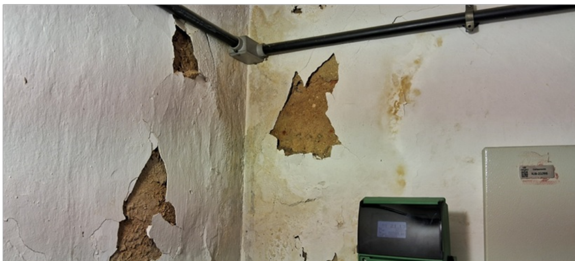
Foto 8 – Parede deterioradas da casa de bombas.
