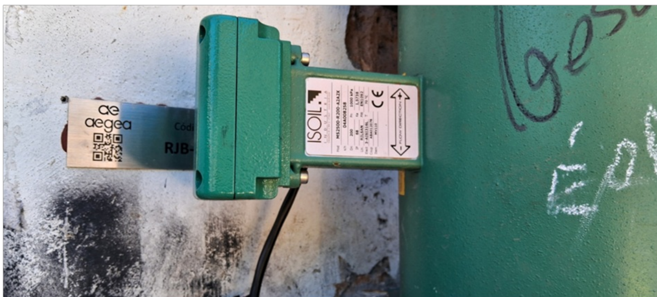
Foto 13 – Dispositivo eletrônico de medição na tubulação.
