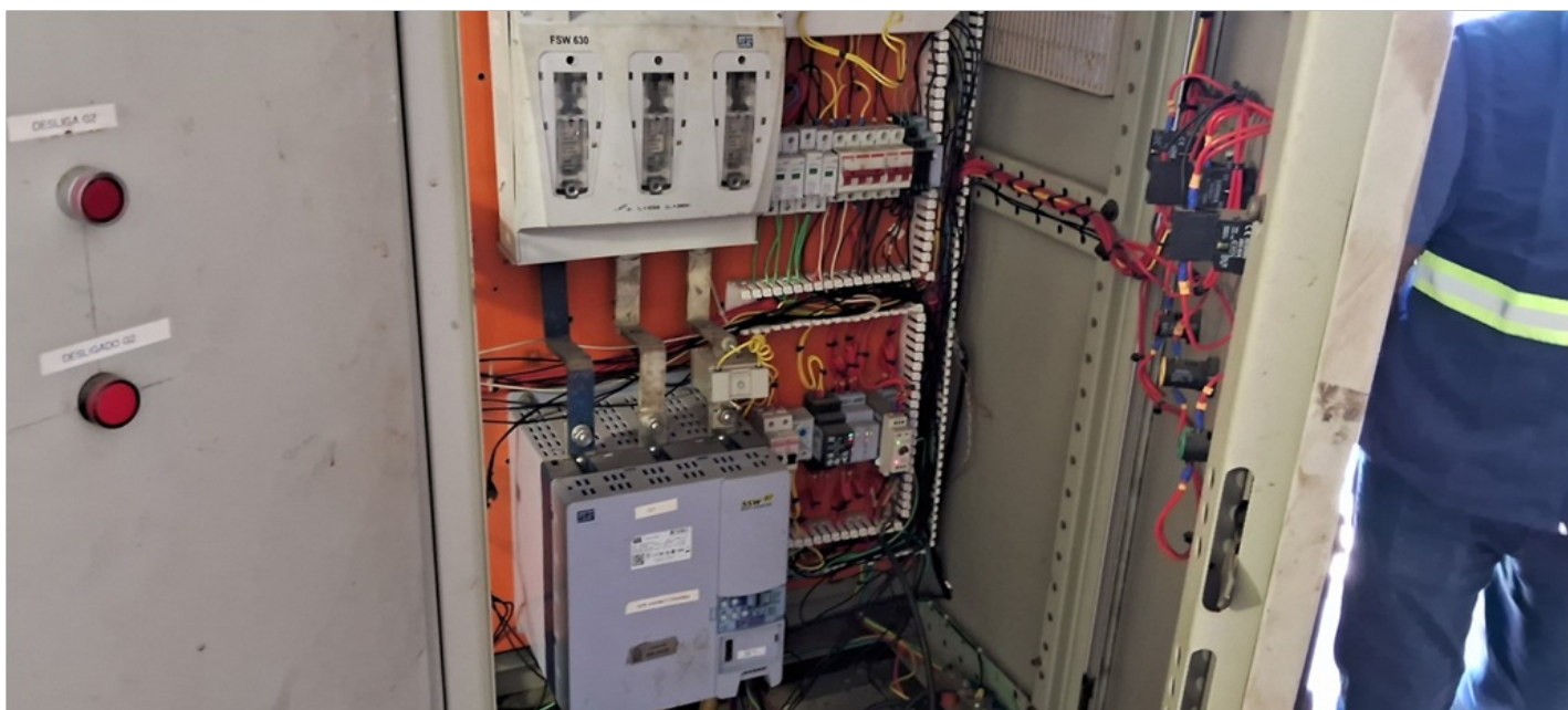
Foto 12 – Vista interna de um dos painéis elétricos.
