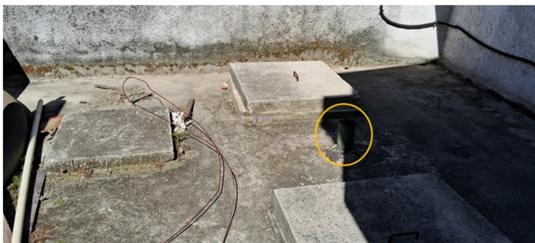
Foto 2 – Vista superior O poço de sucção / reservatório da estação, com destaque para a tubulação de ventilação desprotegida.
