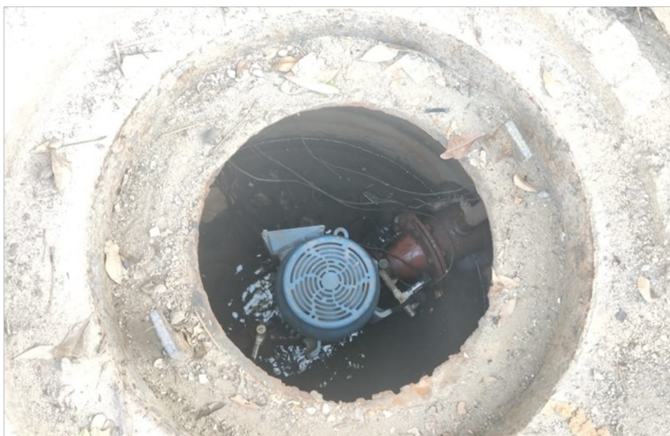
Foto 2 - Motobomba da EEAT com presença de água no poço.
