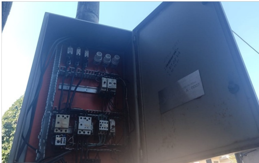
Foto 5 – Abrigo do painel de automação aberto, em bom estado de conservação mas sem sinalização de risco de choque elétrico.
