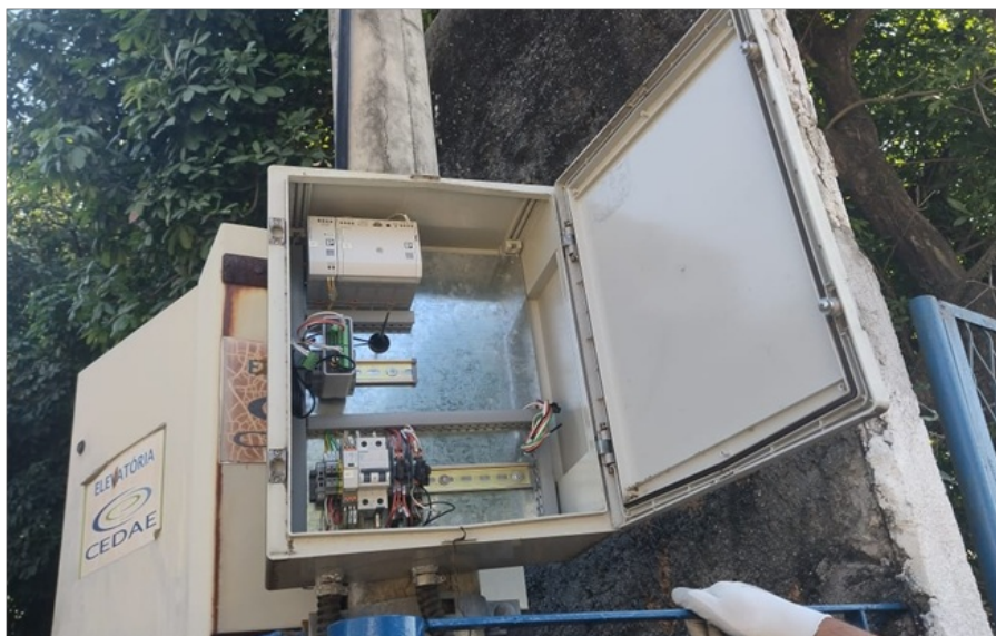
Foto 6 - Painel elétrico aberto sem sinalização de risco de choque elétrico.
