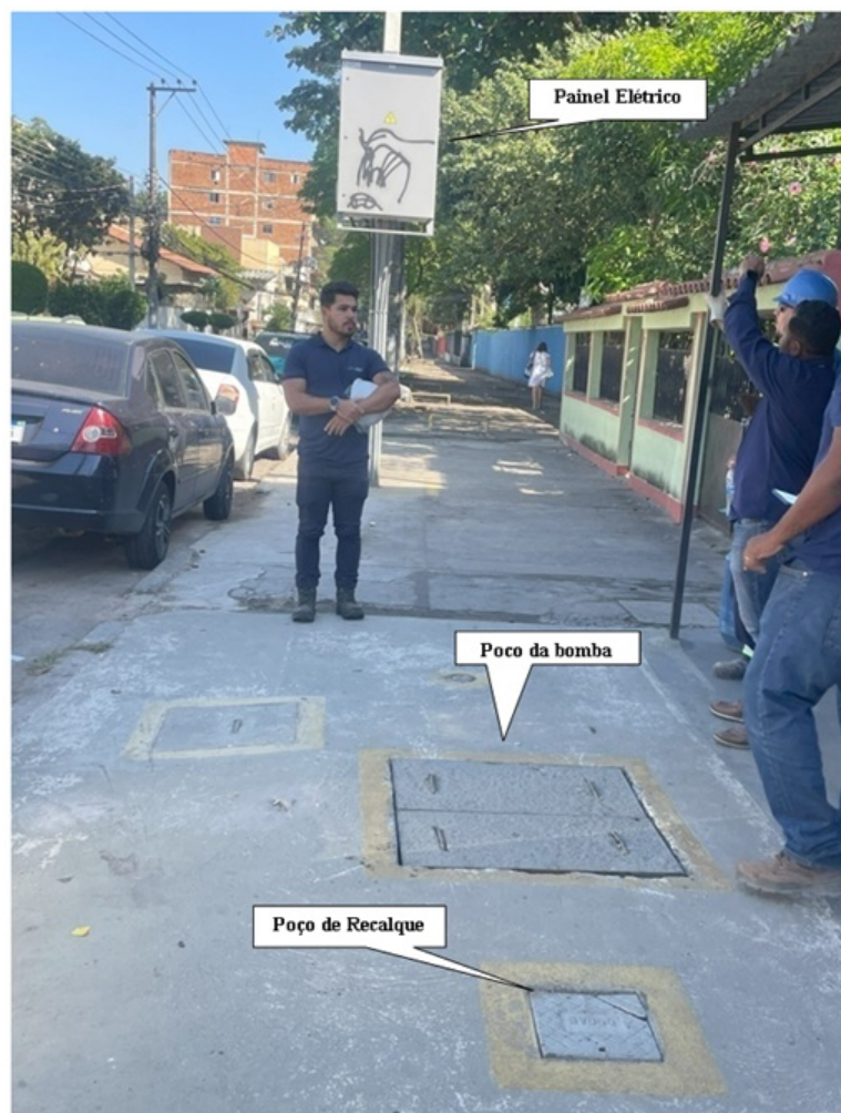
Figura 2 - Localização da EEAT na calçada da via pública
