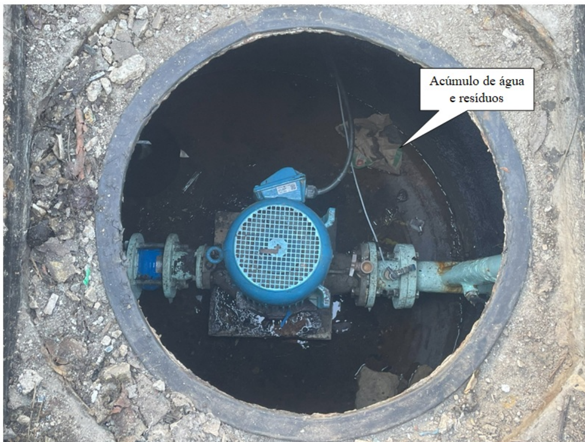
Figura 3 – Abrigo do conjunto motobomba
