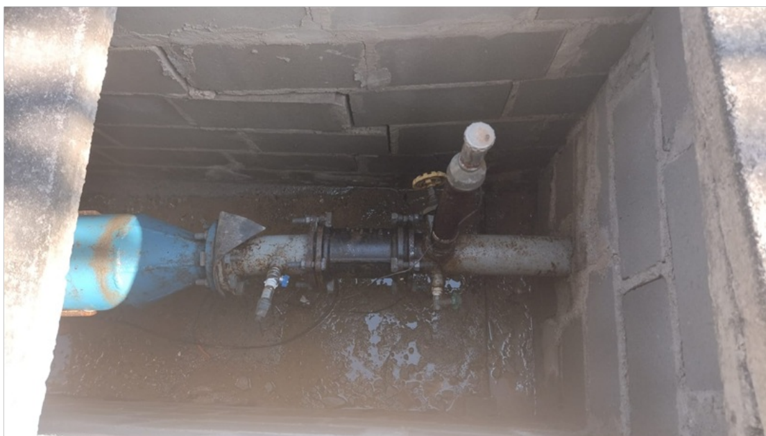
Foto 3 - Conjunto motobomba da EAT.
