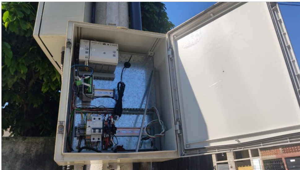
Foto 6 - Abrigo do painel de automação aberto, em bom estado de conservação mas sem sinalização de risco de choque elétrico.
