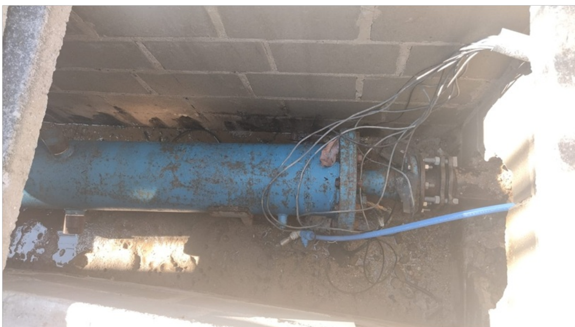
Foto 4 - Poço da tubulação DN 150 do conjunto motobomba.
