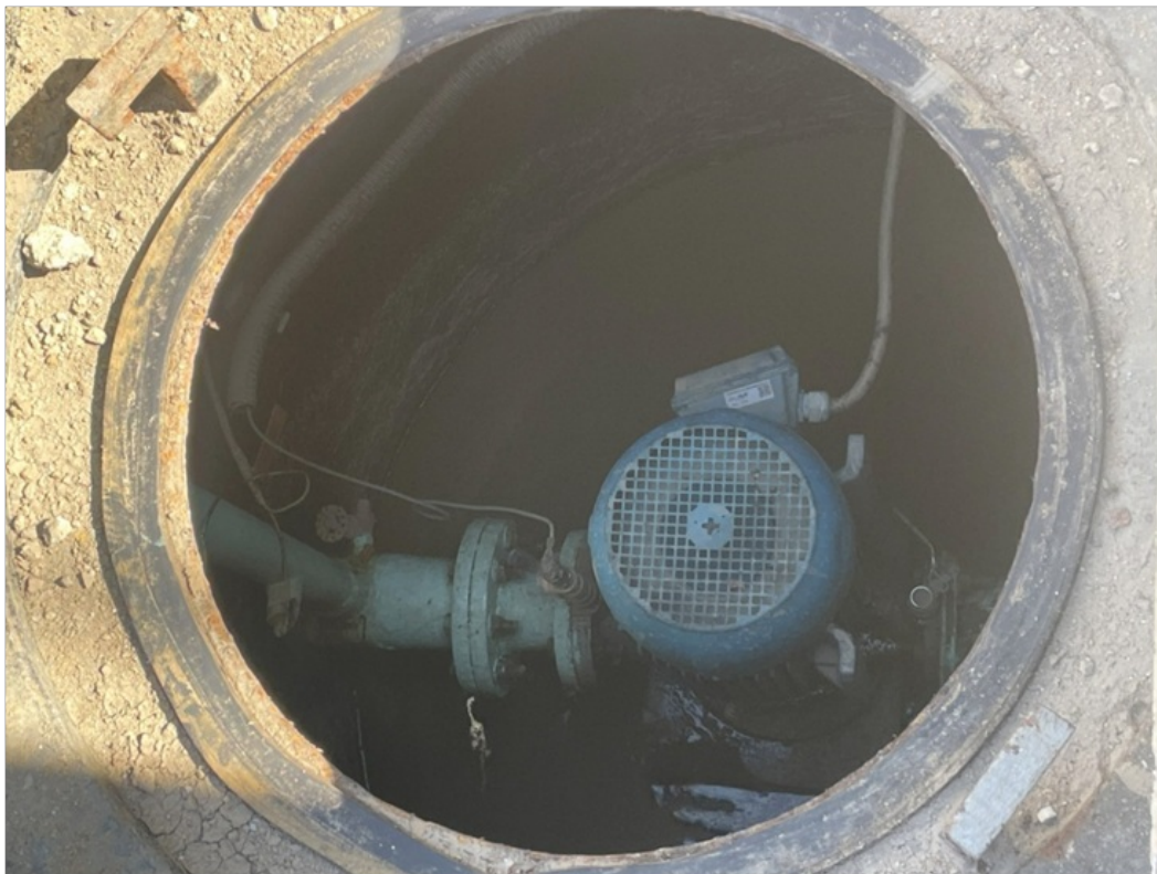
Figura 5 – Conjunto motobomba submersível
