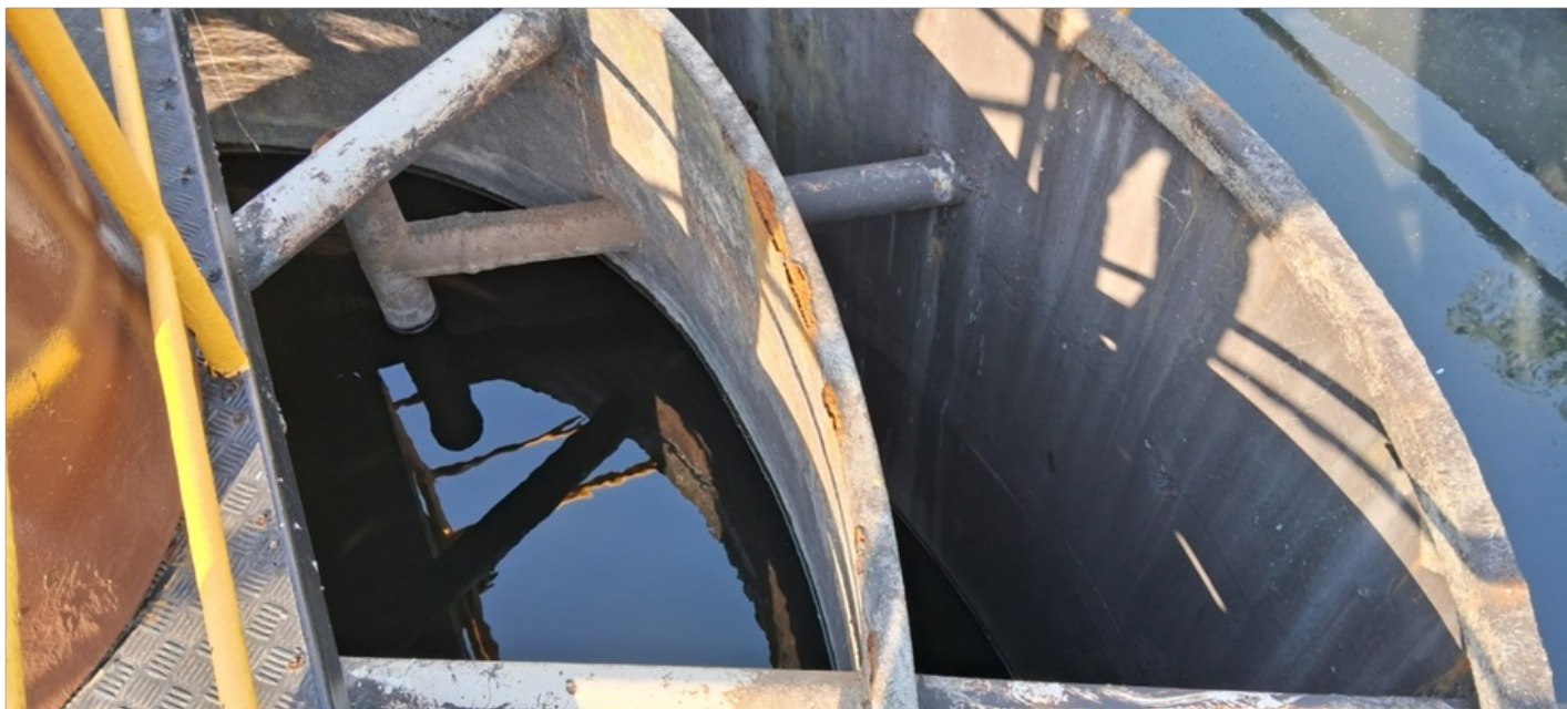
Foto 12 – Ponto oxidação estrutura reator
