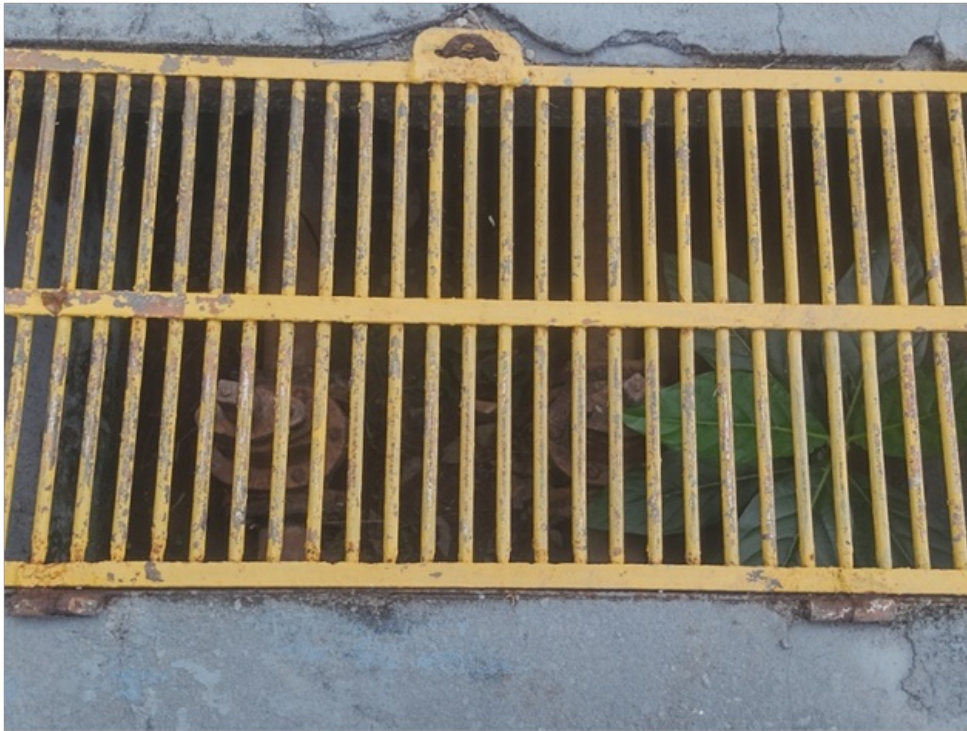
Foto 5 – Barrilete elevatória esgoto bruto
