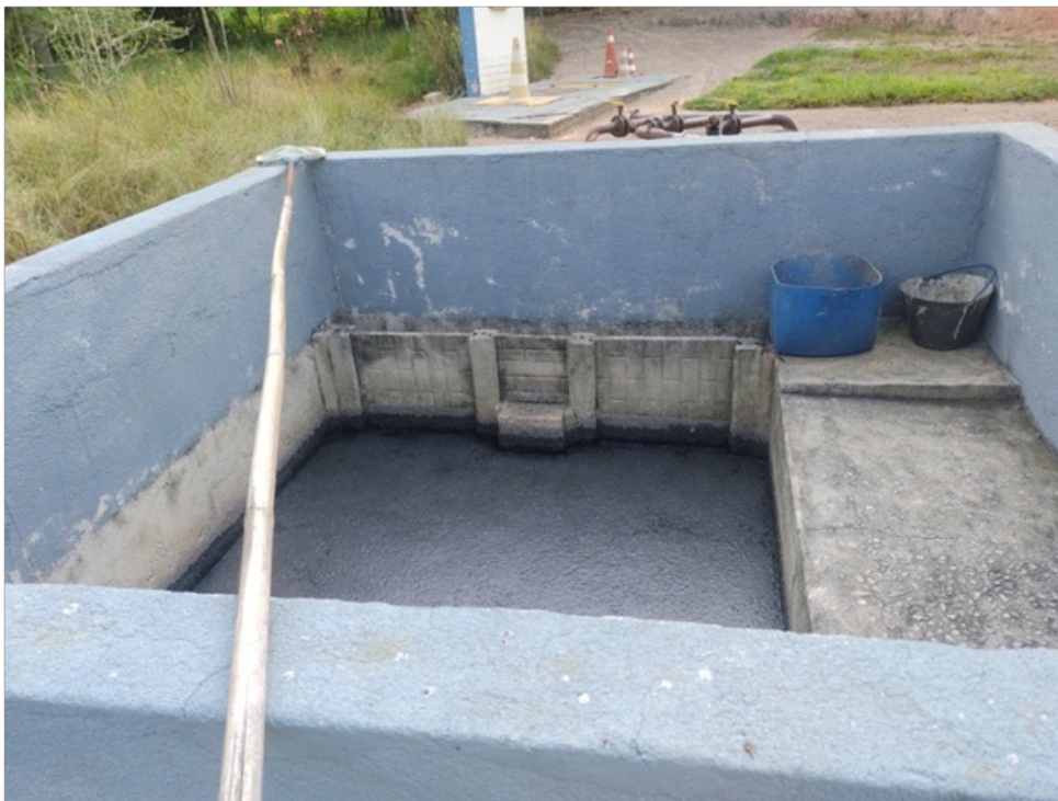
Foto 7 – Caixa de gordura
