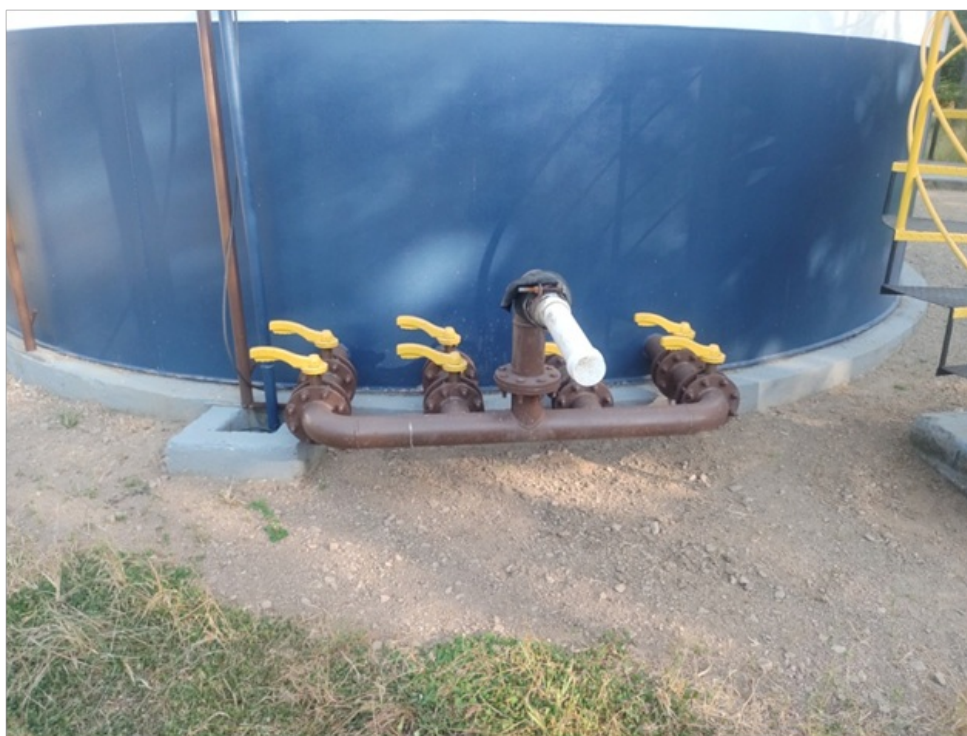
Foto 10 – Barrilete de retirada do lodo
