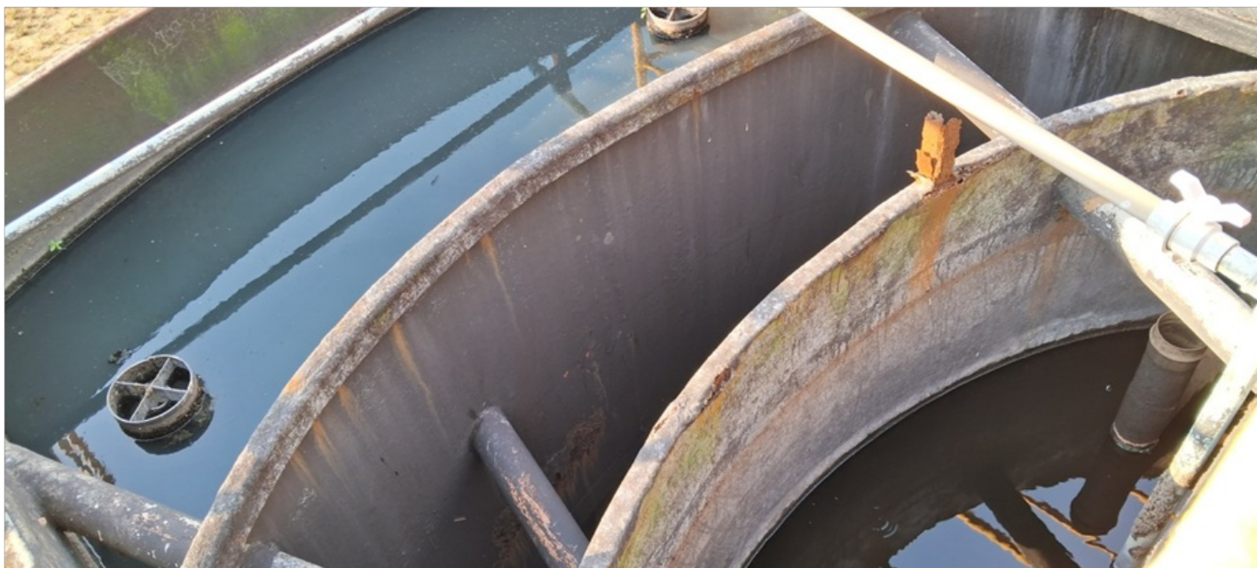
Foto 13 – Ponto oxidação estrutura reator
