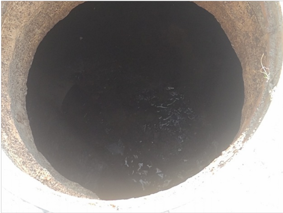
Foto 1 – PV de Chegada
