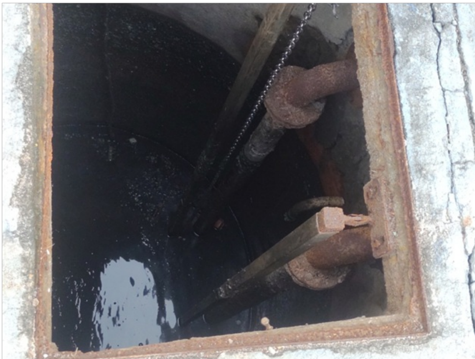
Foto 4 – Bombas submersas elevatória esgoto bruto
