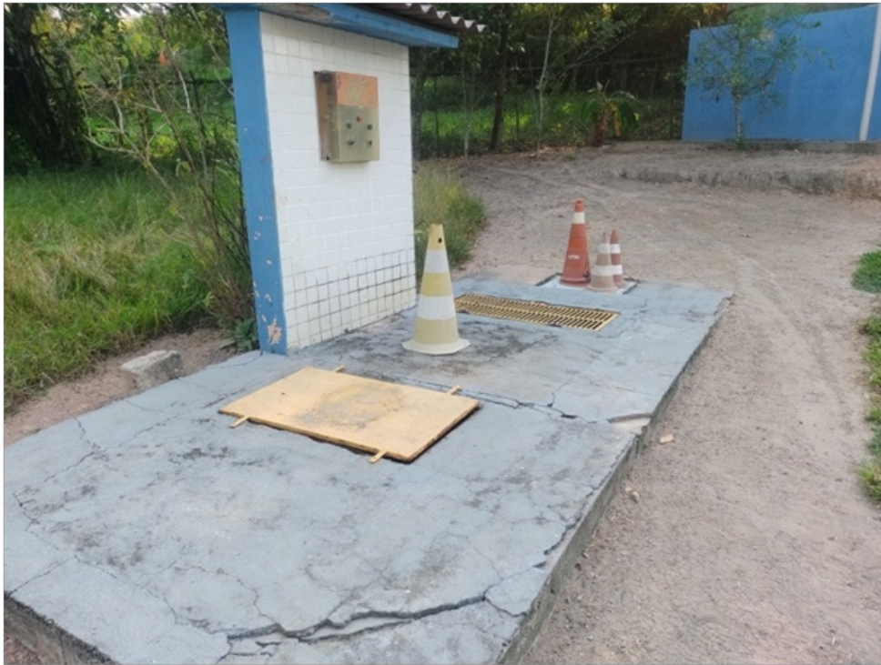
Foto 3 – Elevatória de esgoto bruto
