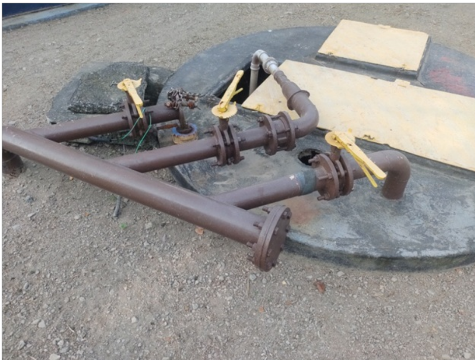
Foto 8 – Elevatória de esgoto pré tratado
