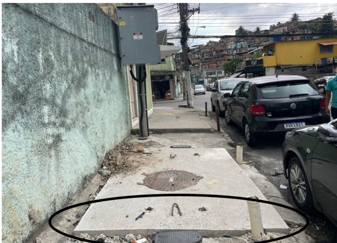
Foto 2 - Vista lateral da Estação elevatória.
