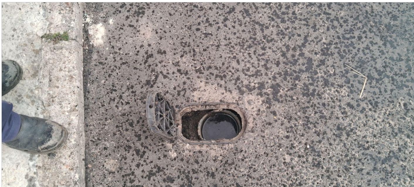
Foto 7 - Registro de manobra com água acumulada no interior da caixa.
