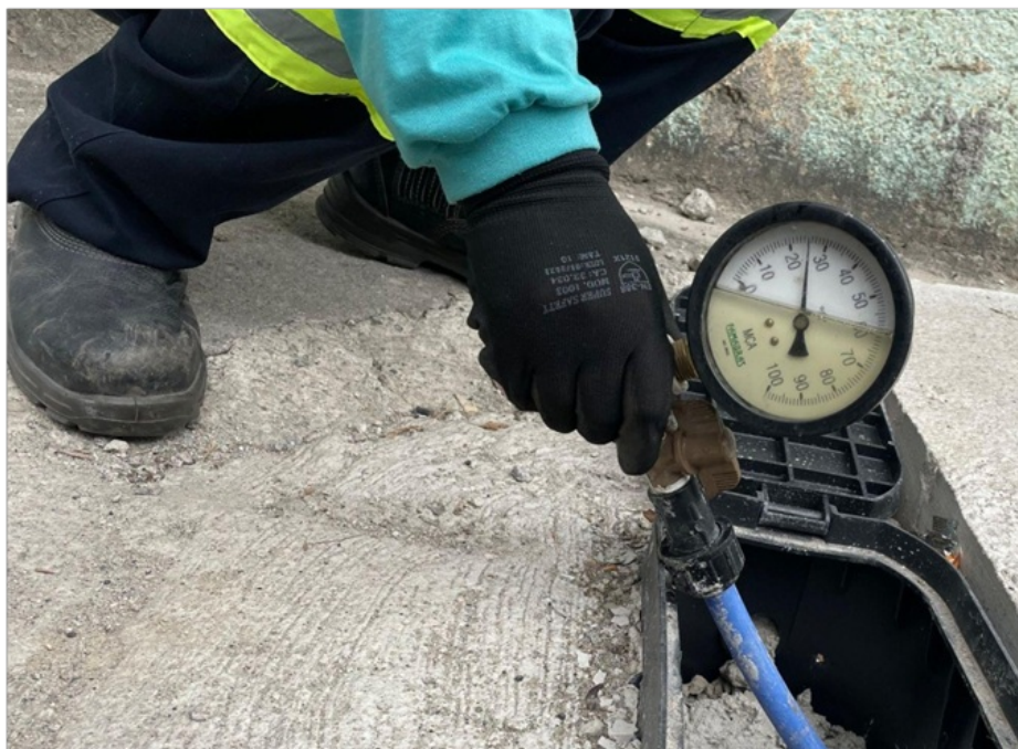
Foto 5 - Manômetro medindo a pressão de recalque.
