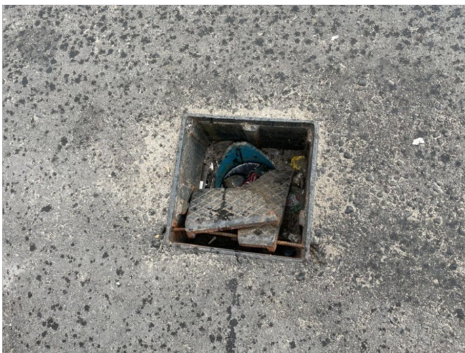
Foto 6 - Tampa quebrada da caixa de um dos registros de manobra..
