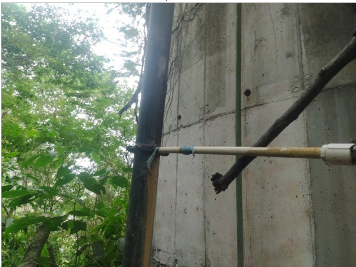
Foto 10 – Tubulação de recalque com ligação indevida
