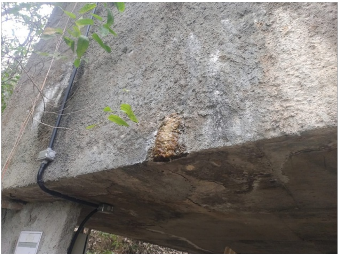
Foto 15 – Fissura estrutura reservatório
