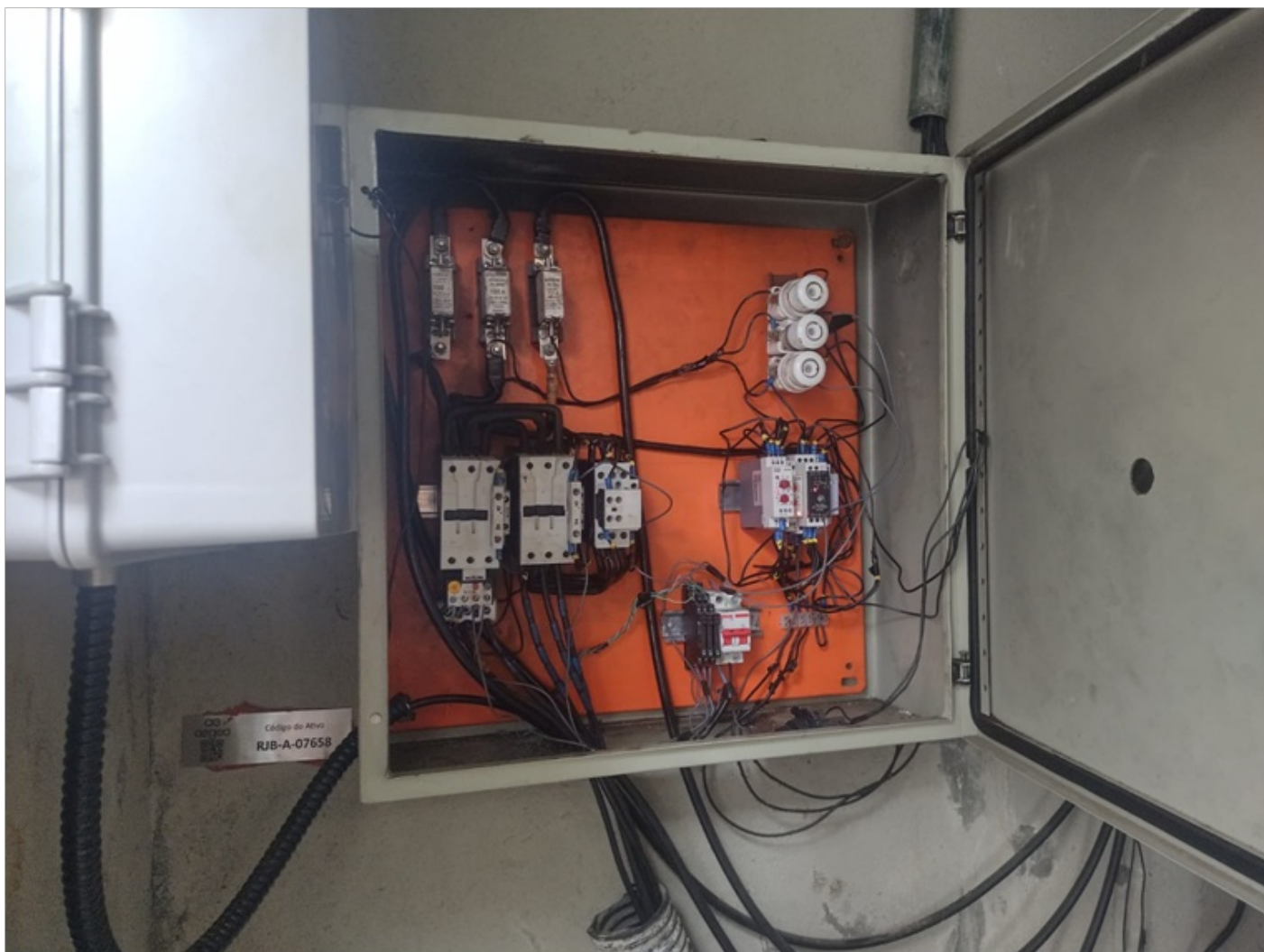
Foto 3 – Quadro elétrico reservatório Nova Divinéia
