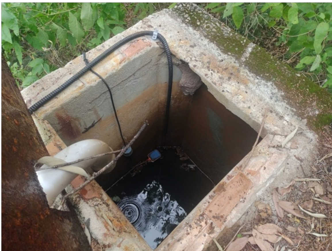
Foto 17 – Tubulações de alimentação do reservatório
