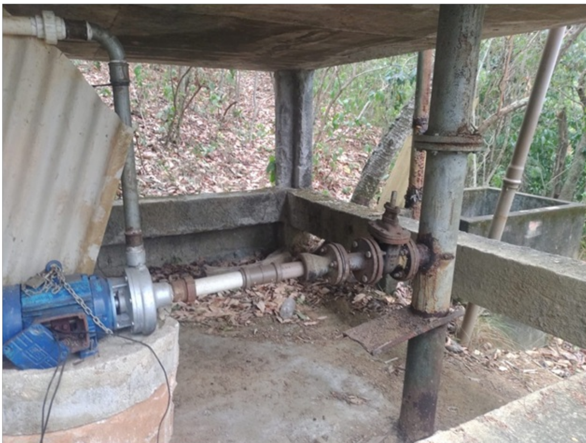
Foto 14 – Conjunto motor bomba
