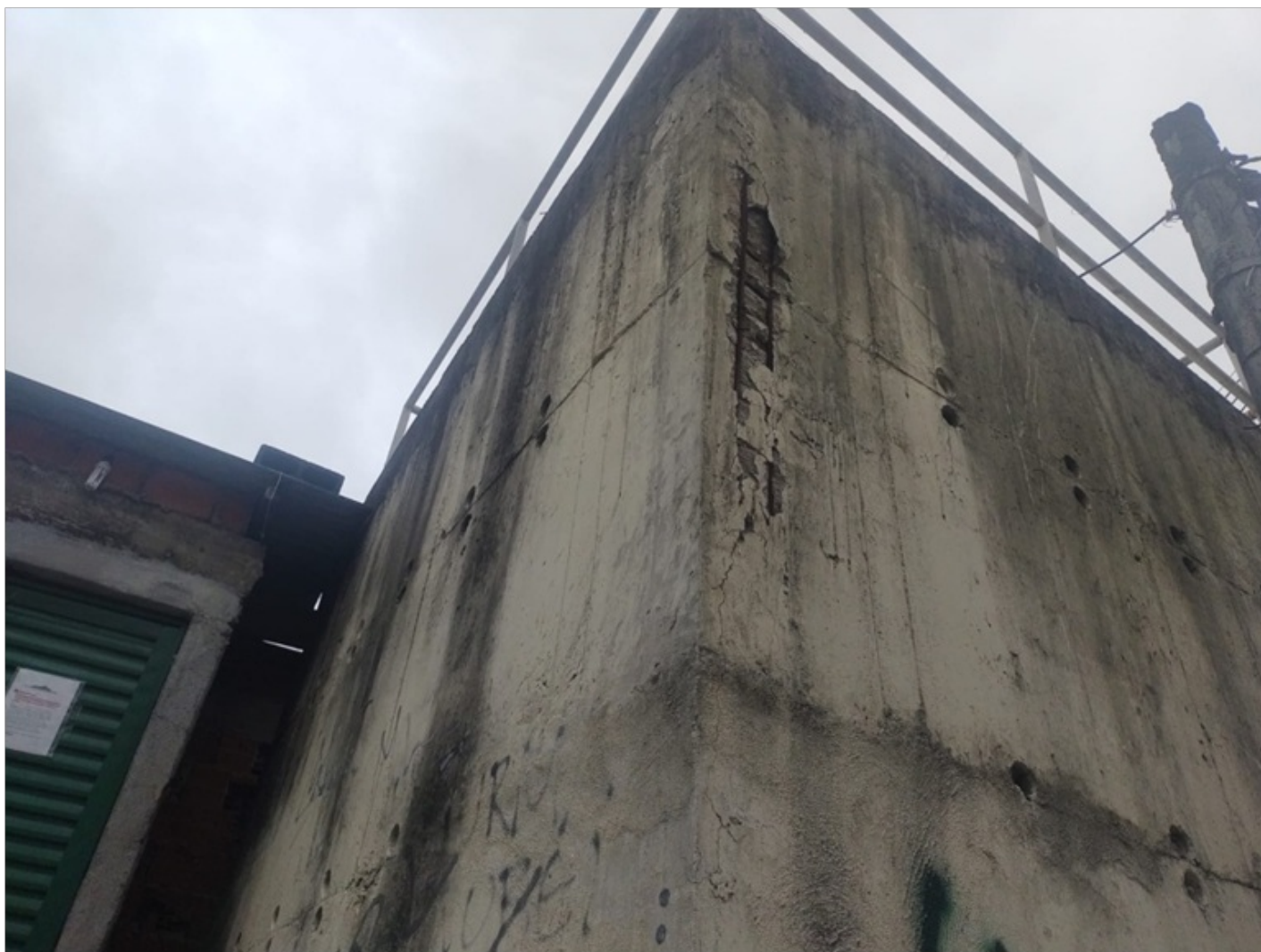
Foto 5 – Ponto com armadura exposta reservatório Nova Divinéia
