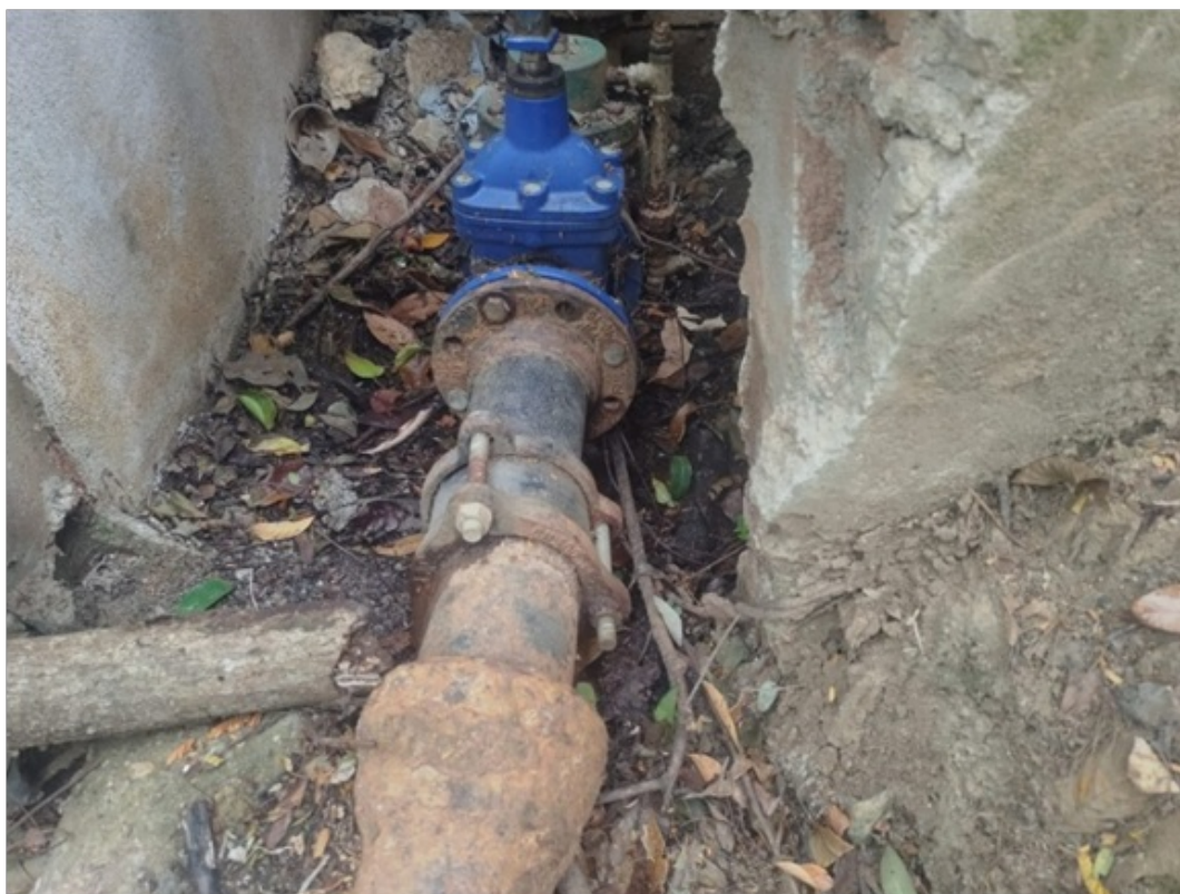
Foto 11 - Tubulações de alimentação do reservatório
