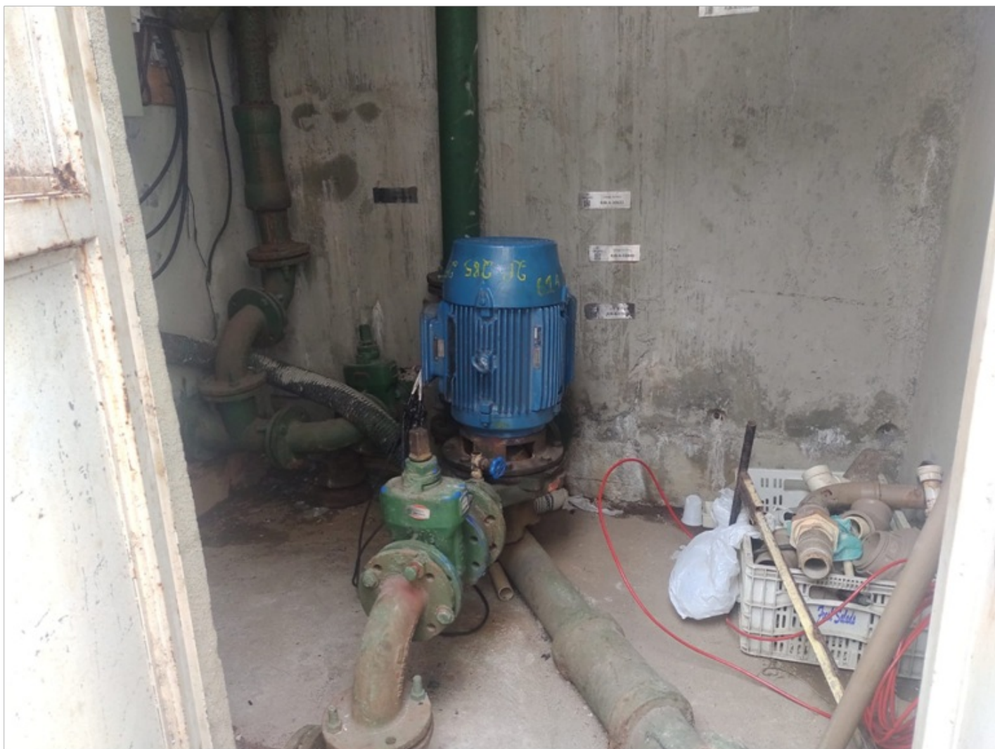
Foto 4 – Conjunto motor bomba reservatório Nova Divinéia
