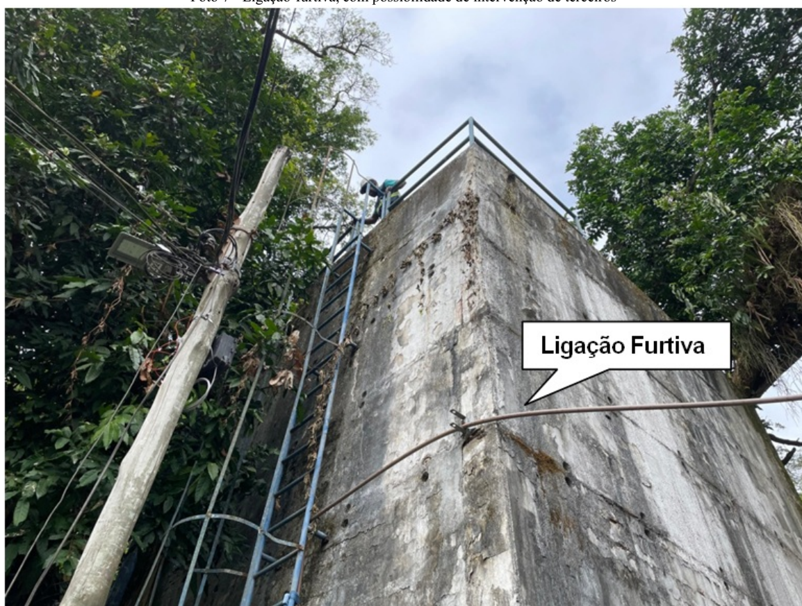
Foto 8 - Ligação furtiva, com possibilidade de intervenção de terceiros, presente no reservatório.
