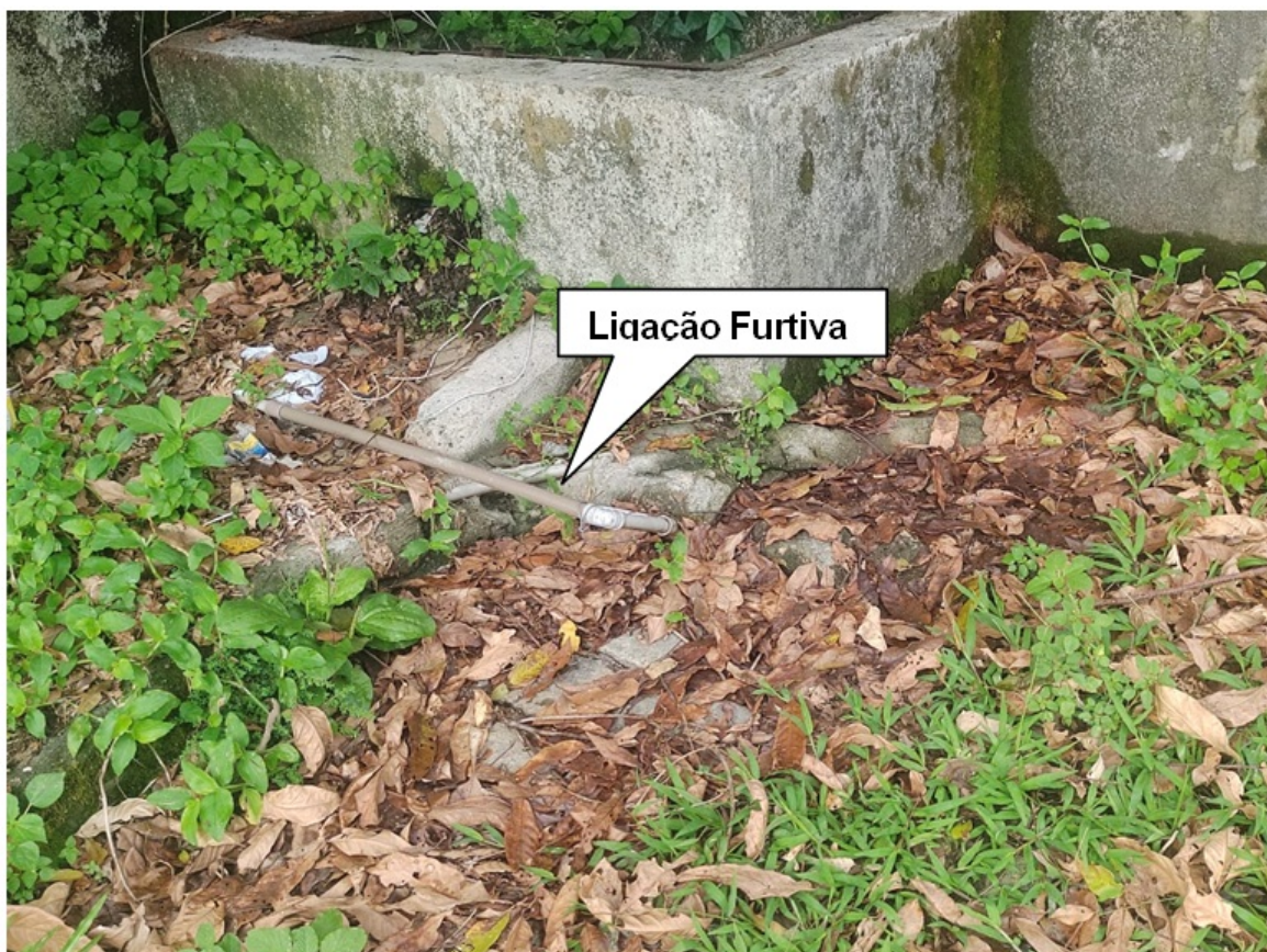
Foto 7 - Ligação furtiva, com possibilidade de intervenção de terceiros
