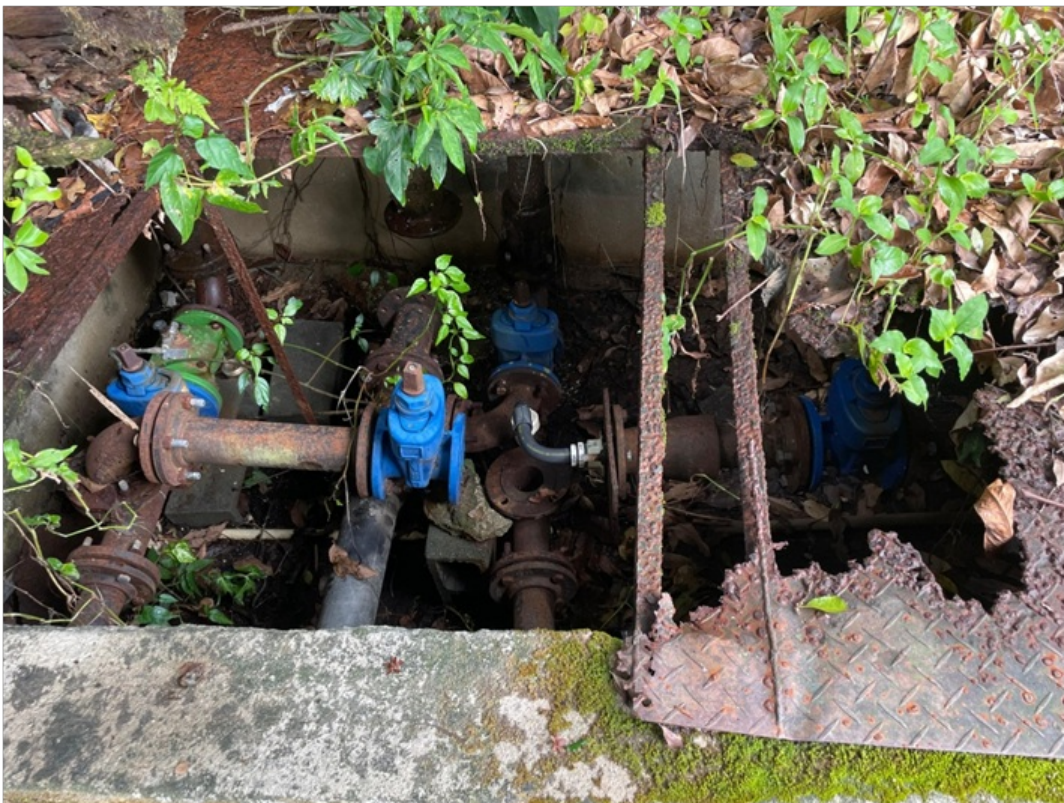
Foto 2 - Poço do barrilete sem tampa adequada e com presença de sujeira e vegetação.
