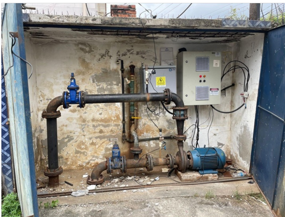
Foto 3 - Vista interna da estação. ü Destaca-se que a estação possui válvulas de bloqueio e de retenção. ü Verificou que o disjuntor elétrico está fixado diretamente na parede.
