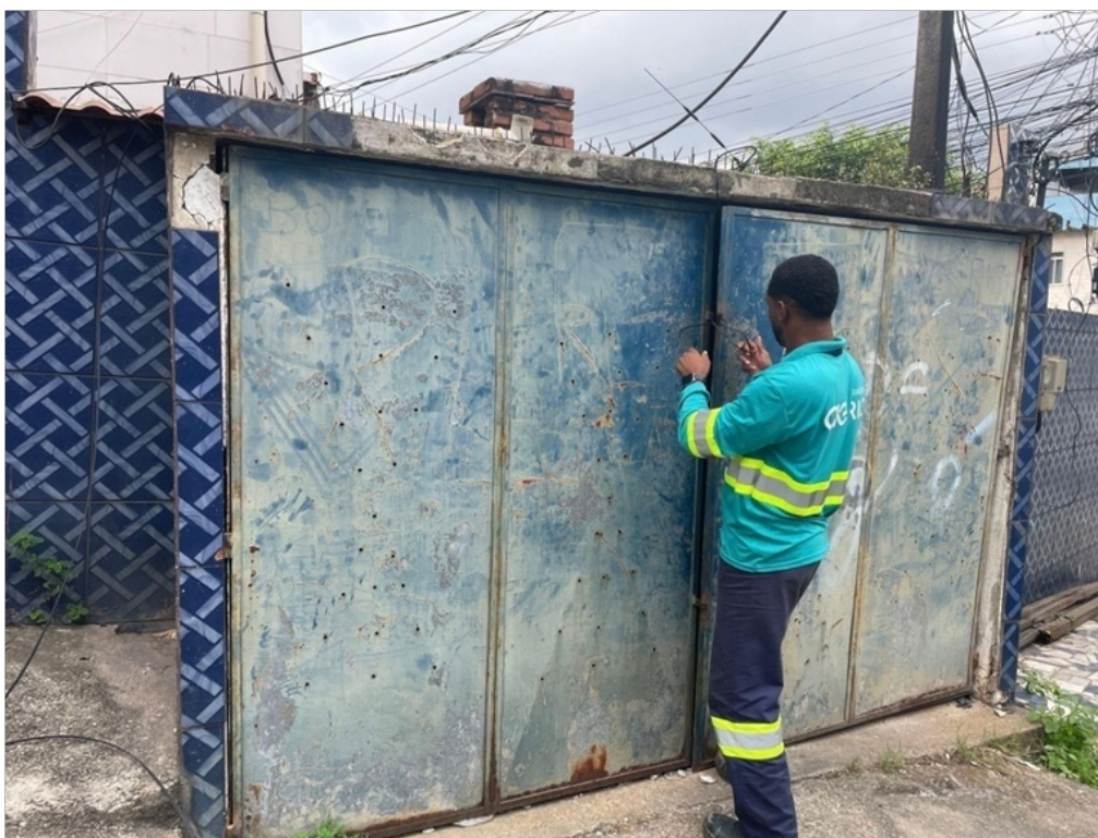
Foto 2 - Portão do abrigo da elevatória. ü Portão não possui bloqueio de segurança.
