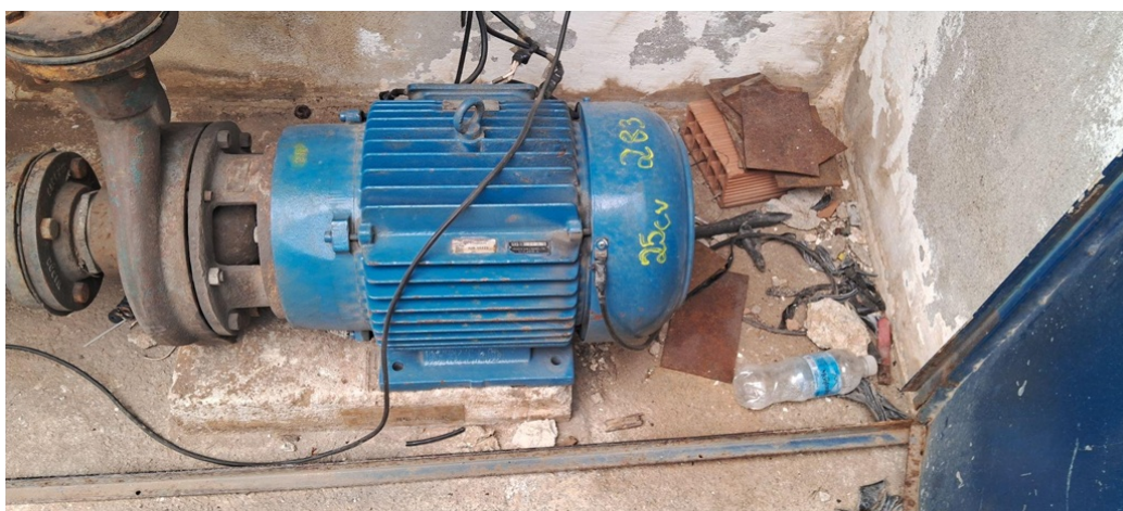
Foto 6 - Vista do conjunto motobomba.
