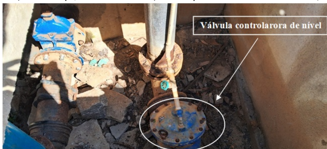
Foto 5 – Válvula controladora de nível
