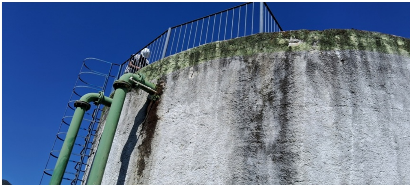
Foto 14 – Reservatório sem identificação e placa de restrição, com pintura deteriorada
