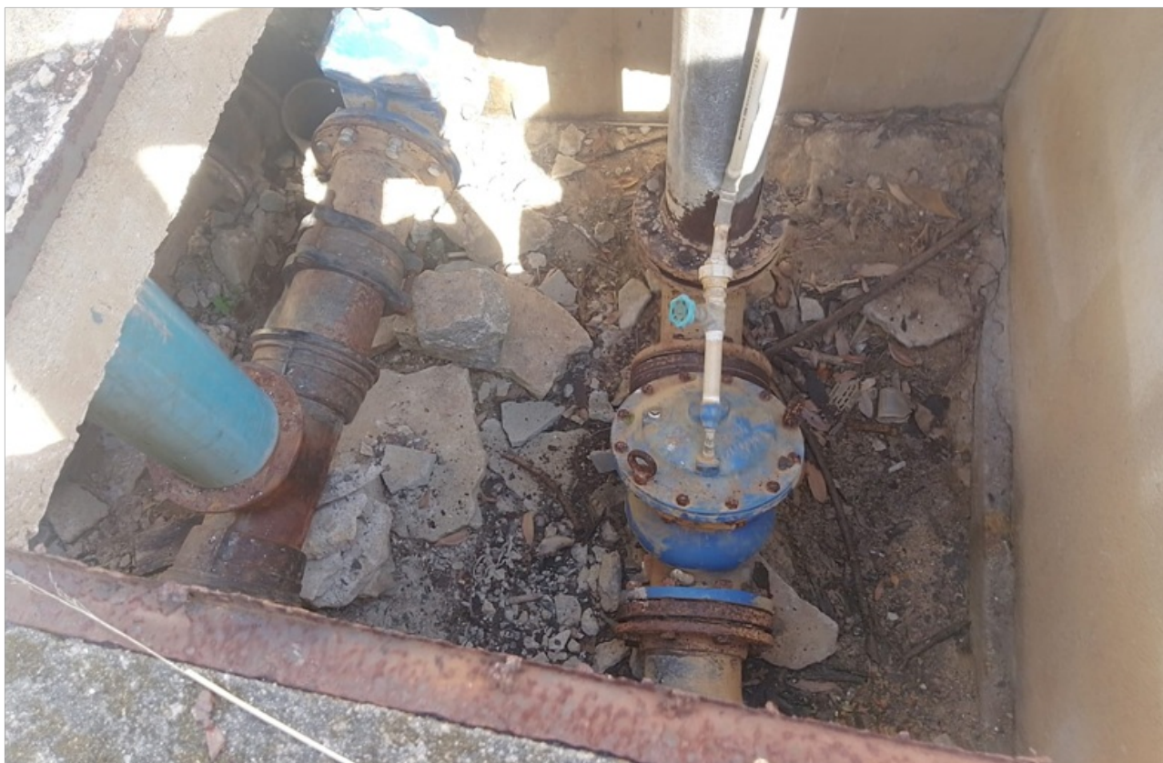
Foto 19 – Tampa solta e com ferrugem
