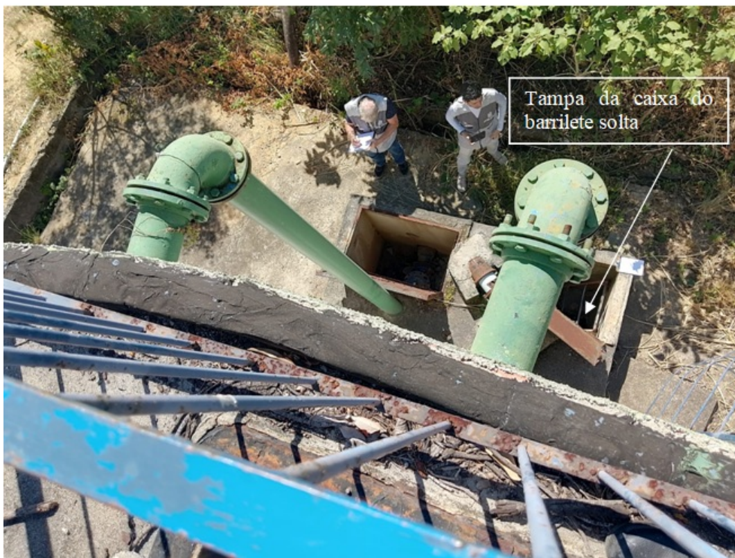
Foto 9 – Uma das tampas da caixa do barrilete solta
