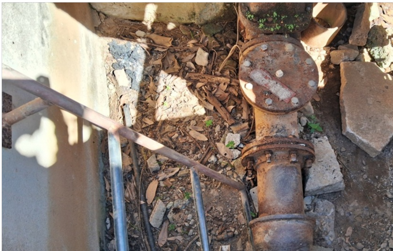
Foto 17 – Tubulação de limpeza no barrilete com partes enferrujadas
