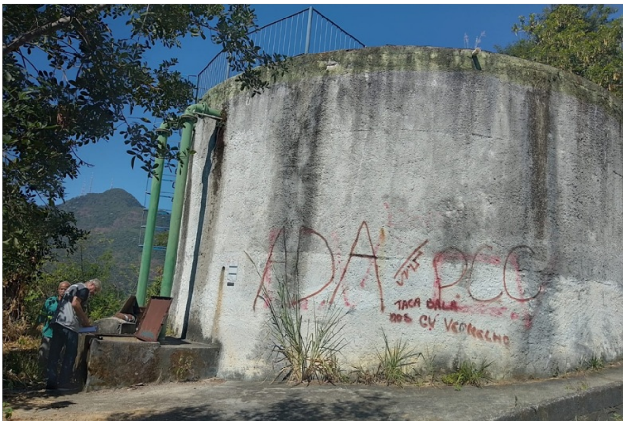
Foto 13 – Reservatório sem identificação e placa de restrição, com pintura deteriorada
