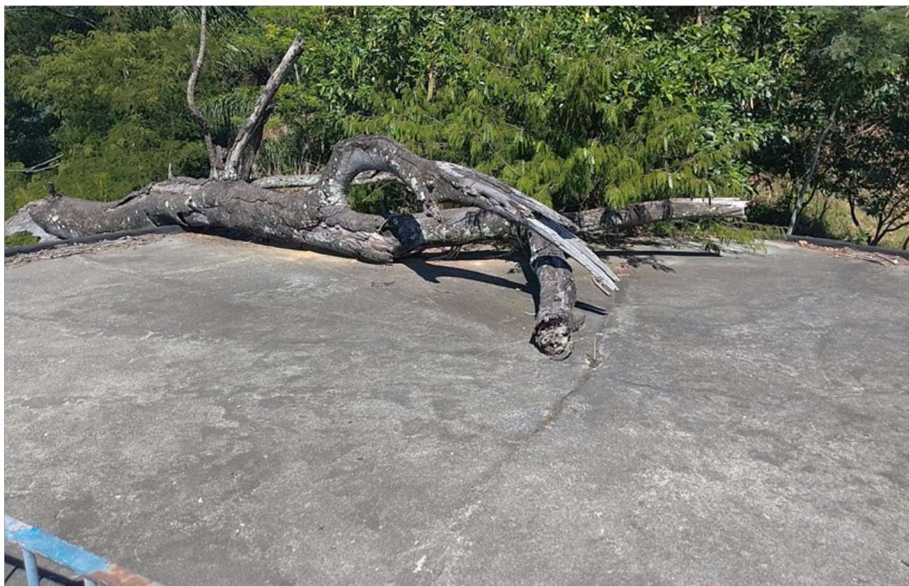
Foto 18 – Árvore que caiu na laje superior
