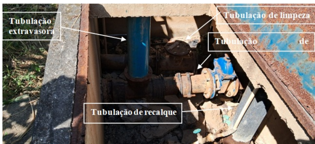
Foto 4 – Tubulação de recalque, extravasora, distribuidora e limpeza ( todas DN 150 mm)
