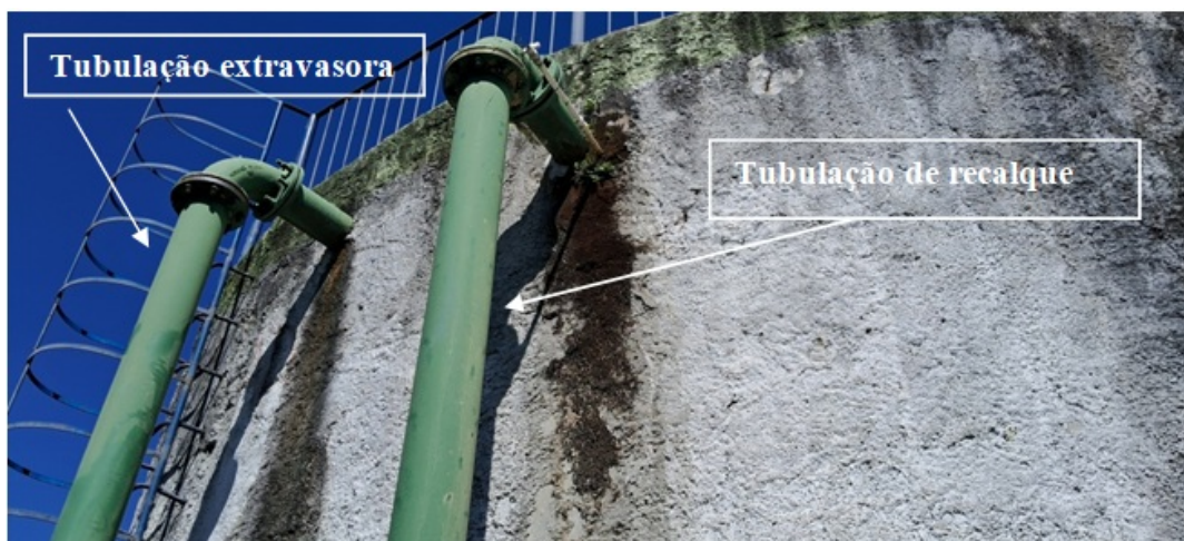
Foto 3 – Tubulação de recalque e extravasora ( ambas DN 150 mm)
