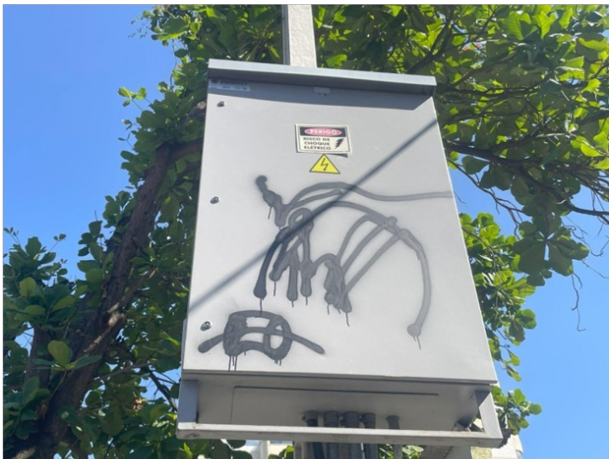
Foto 7 - Vista do painel elétrico de controle da estação.
