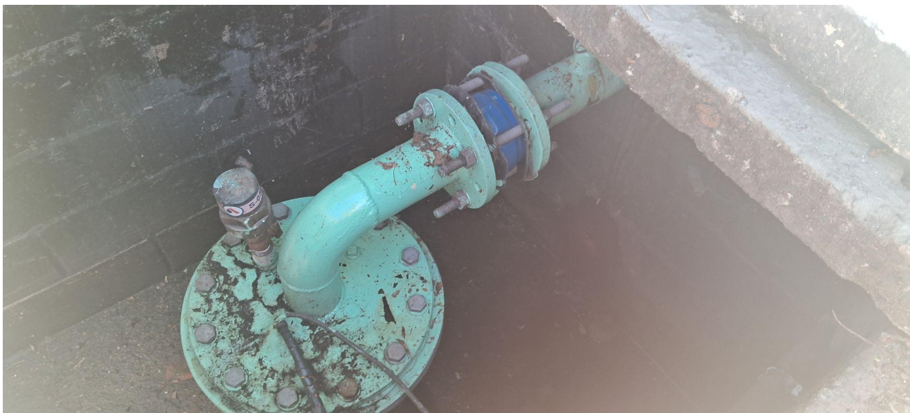
Foto 4 - Vista do conjunto motobomba, destaque da válvula de retenção na tubulação de recalque.
