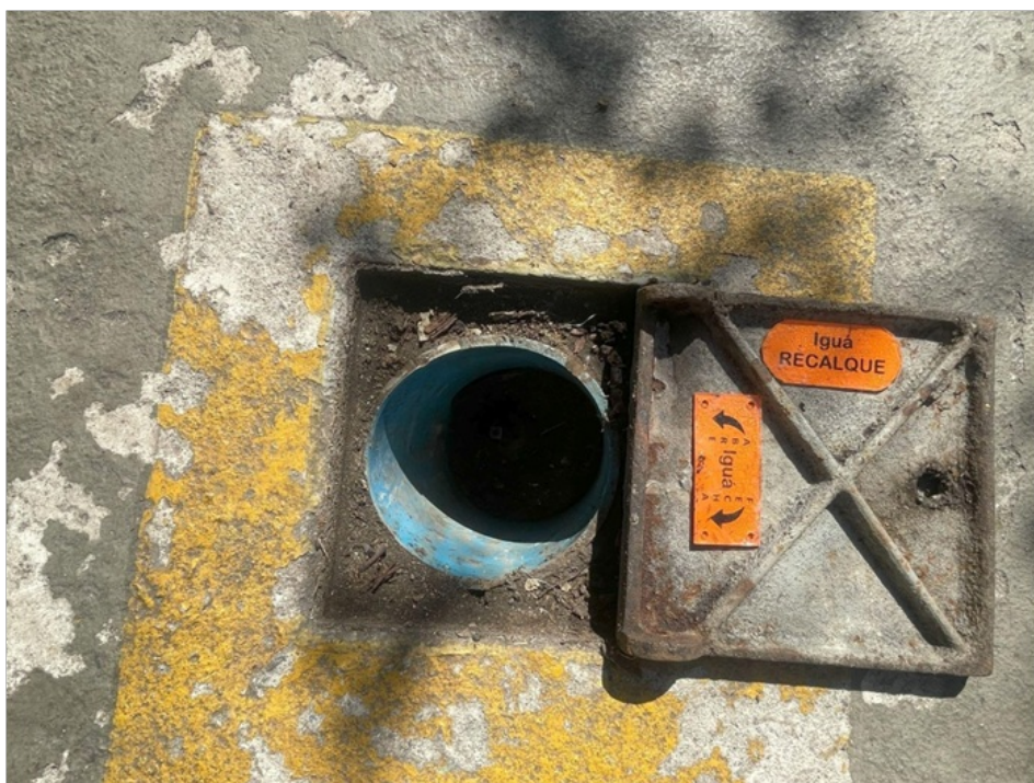
Foto 5 - Vista do interior da caixa do registro da linha de recalque, devidamente sinalizado.
