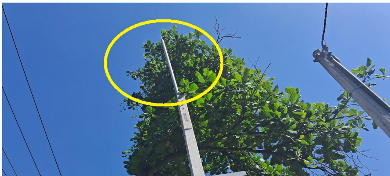
Foto 8 - Vista do para-raio da estação.
