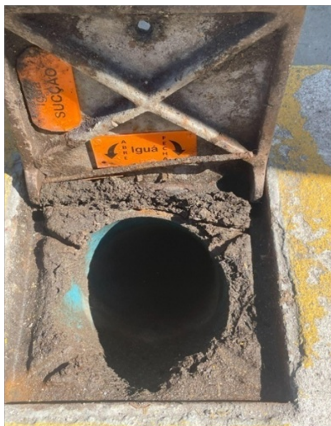
Foto 6 - Vista do interior da caixa do registro da linha de sucção, devidamente sinalizado.
