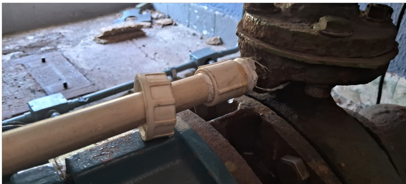
Foto 3 – Vazamento em tubulação acessória.
