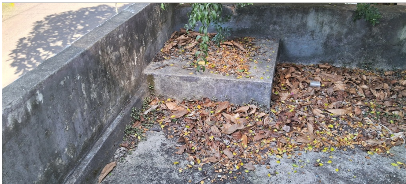
Foto 6 – Grande quantidade de folhas acumuladas sobre a laje do reservatório.
