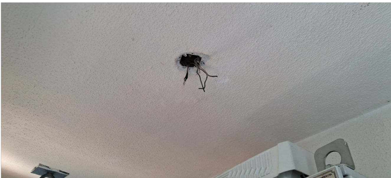
Foto 8 – Ausência de luminária.
