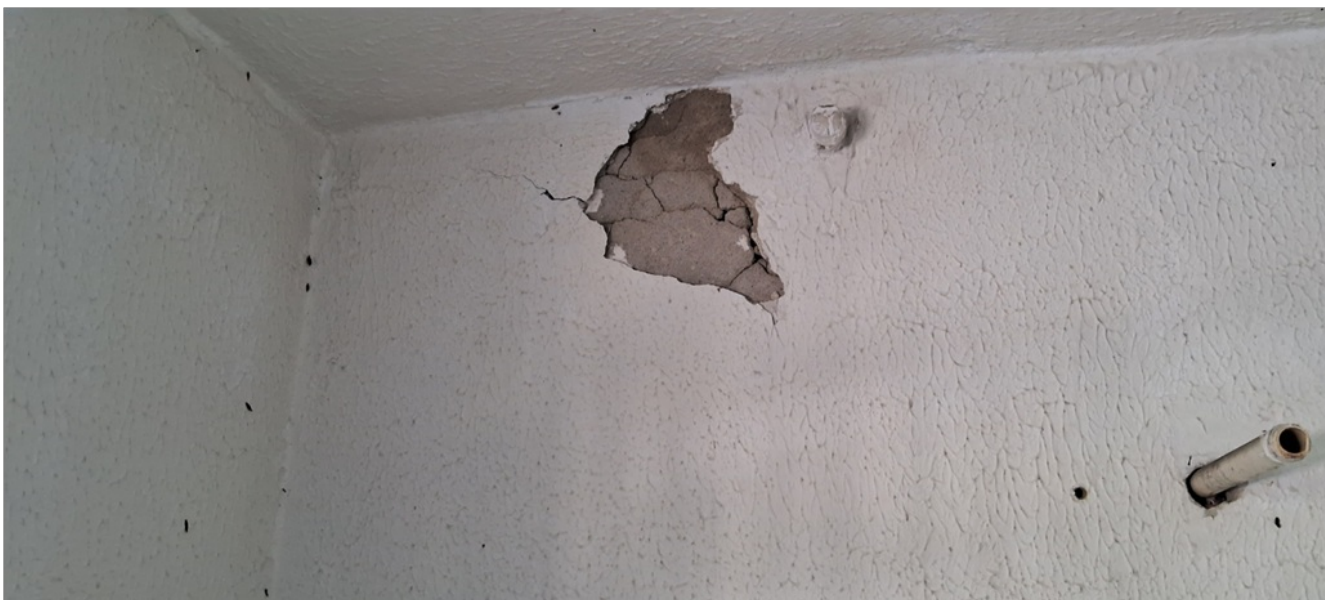
Foto 9 – Área interna com emboço da parede danificado.
