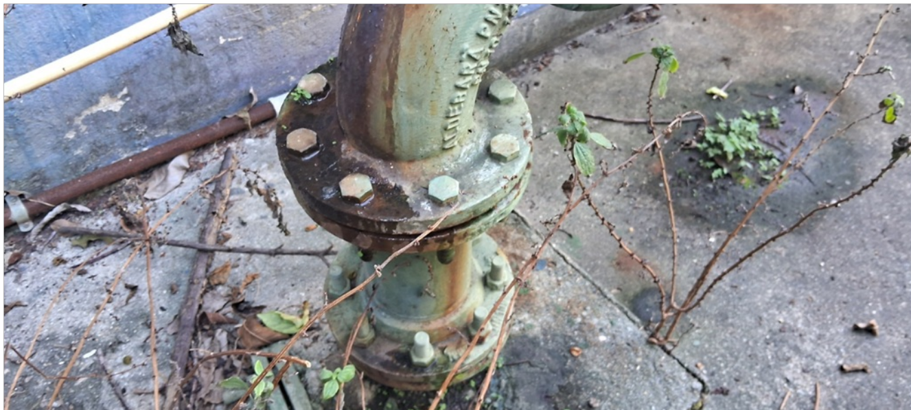
Foto 5 – Vazamento na tubulação do barrilete de recalque
