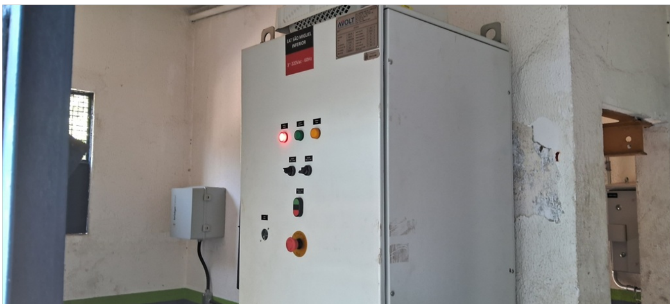
Foto 7 – Vista do painel de comando elétrico e de equipamento de telemetria.
