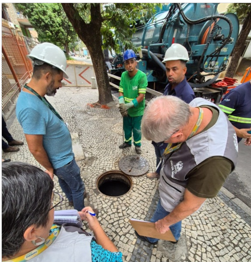
Foto 2 - PV após a remoção do efluente pelo Caminhão Auto Vácuo
