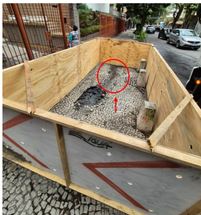
Foto 4 - Marca do efluente de esgoto no passeio público
