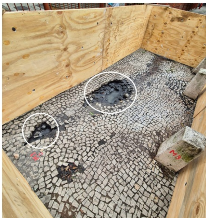
Foto 8 - Vazamentos do efluente de esgoto
