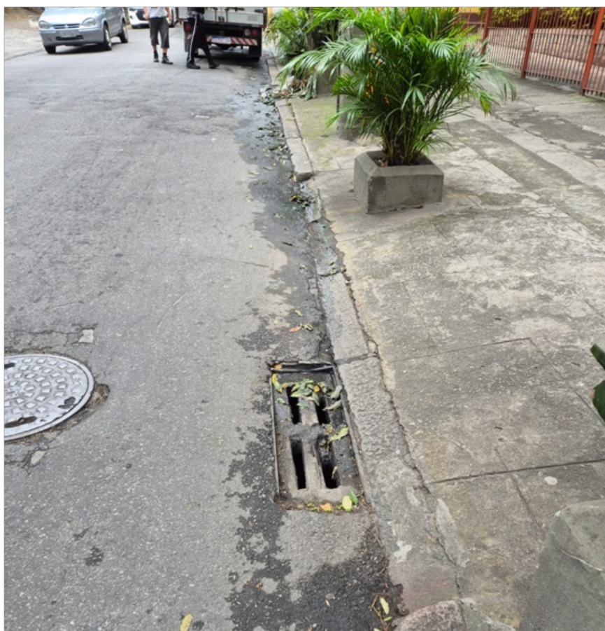
Foto 5 - Ralo pertencente a GAP para onde o efluente de esgoto se direcionava
