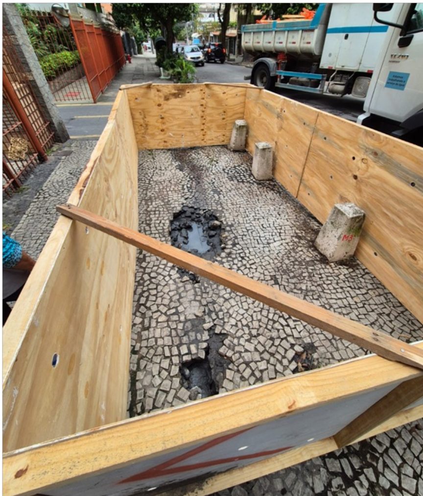
Foto 9 - Vazamentos do efluente de esgoto
