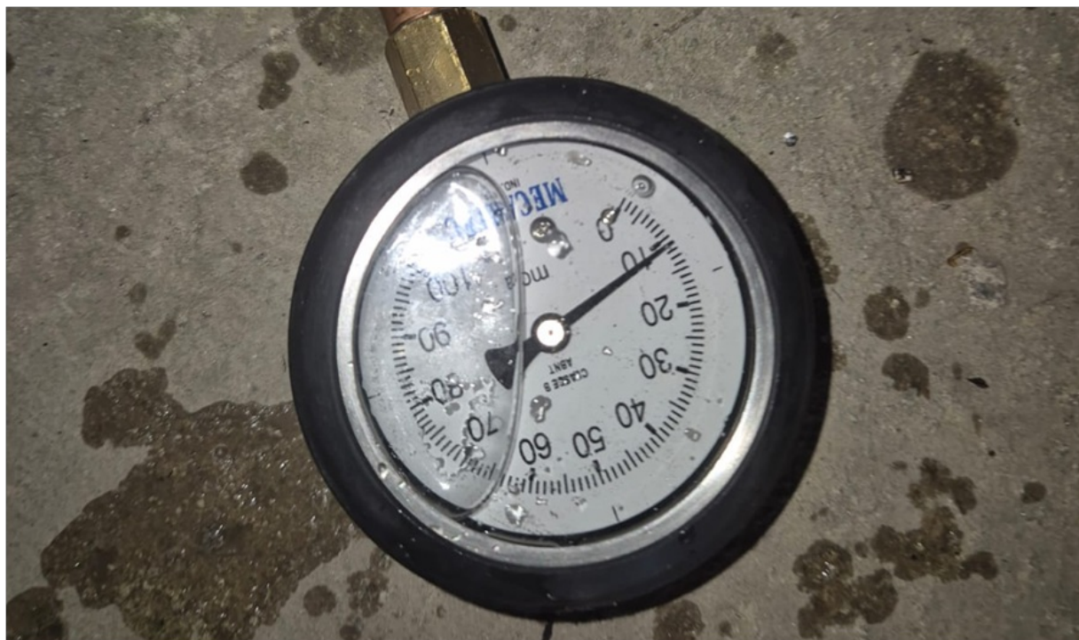
Foto 4 – Pressão manométrica medida no imóvel nº 87 frente no momento da vistoria : 11 MCA
