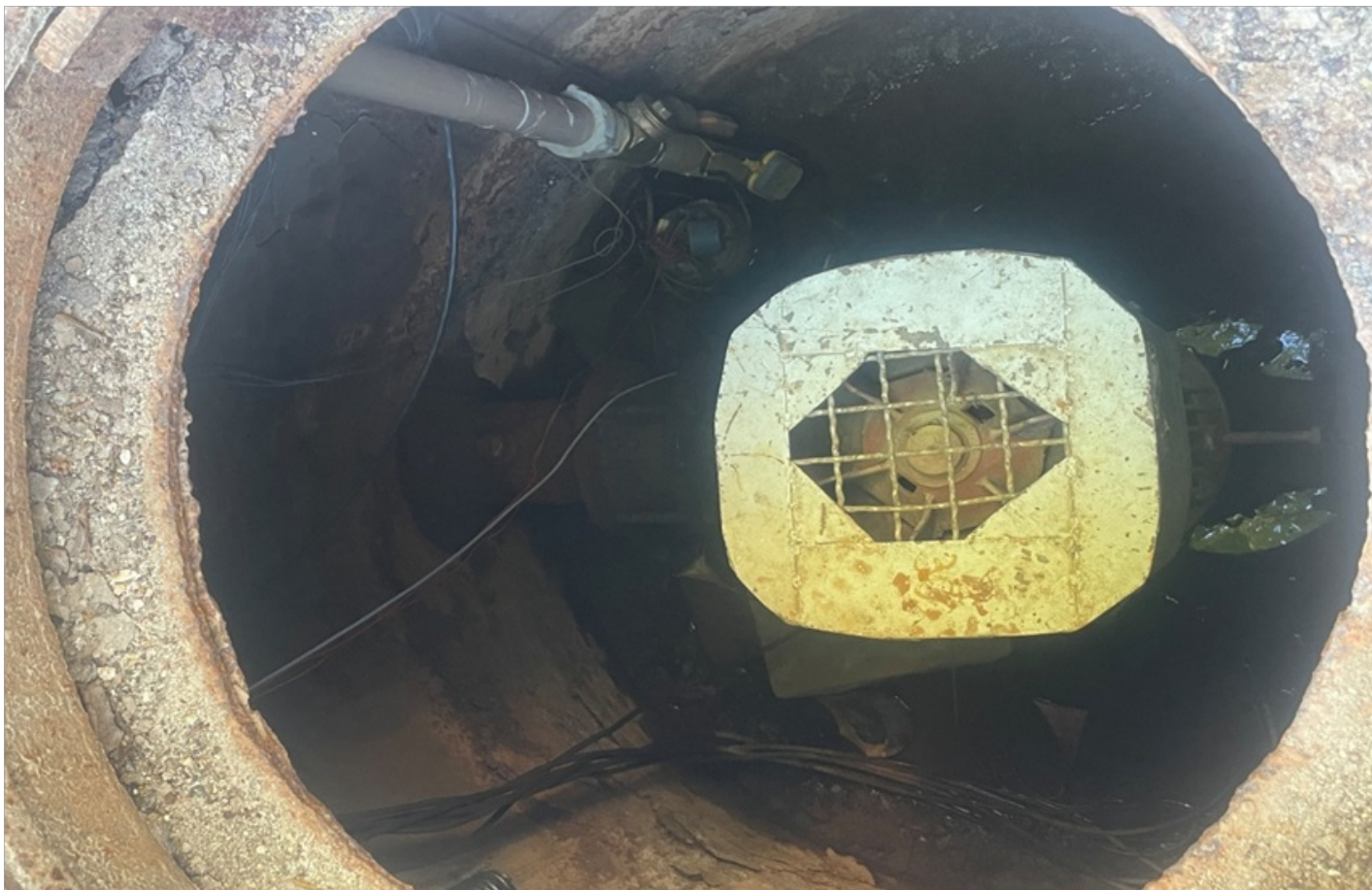
Foto 3 - Poço da motobomba operante da EEAT apresentando água em seu interior (vazamento).
