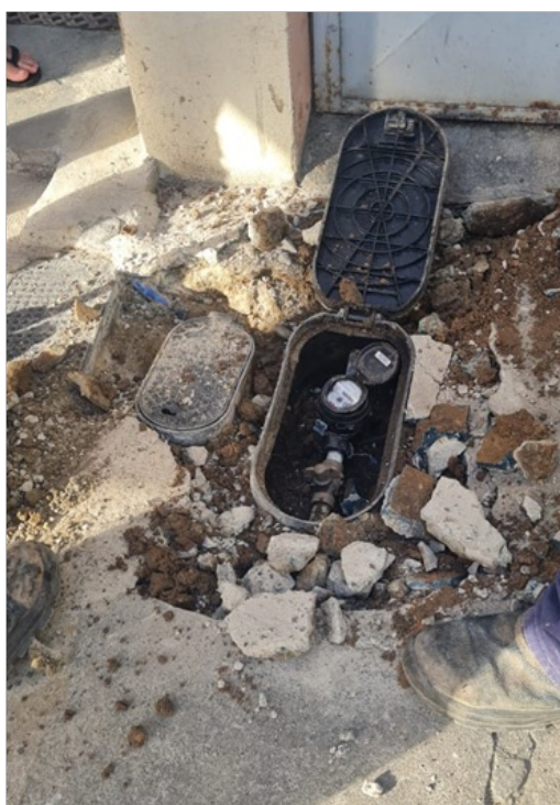
Foto 7 – Hidrômetro externo (novo) do imóvel nº 13
