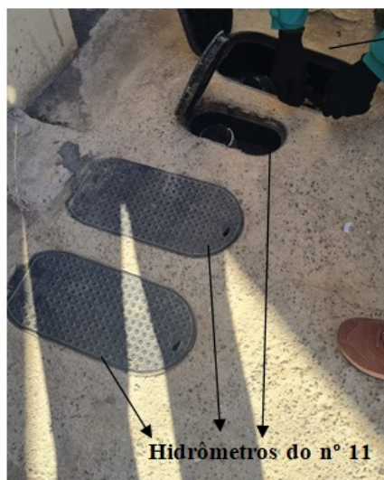
Foto 8 – Hidrômetros do imóvel nº 11 D
