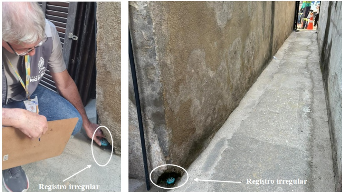
Foto 9 e 10 – Registro encontrado em um ramal predial do imóvel nº 11 D
