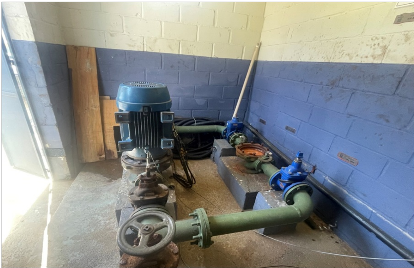
Foto 2 - Vista do conjunto motobomba e barriletes.
