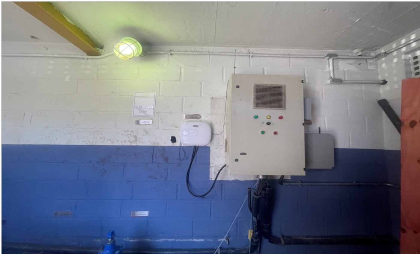
Foto 4 - painel de controle devidamente trancado.
