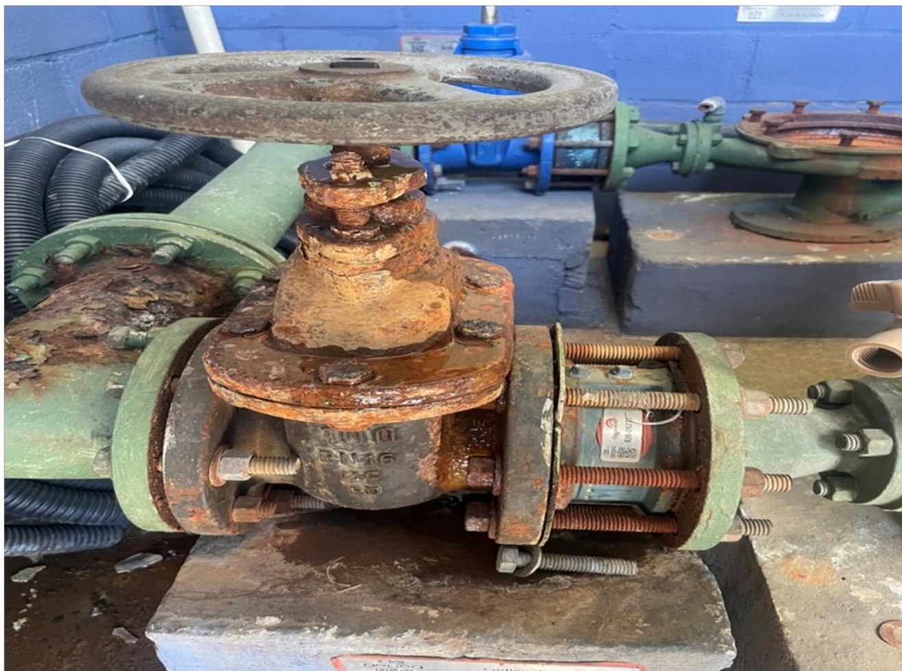
Foto 6 - sinais de vazamento na EEAT.
