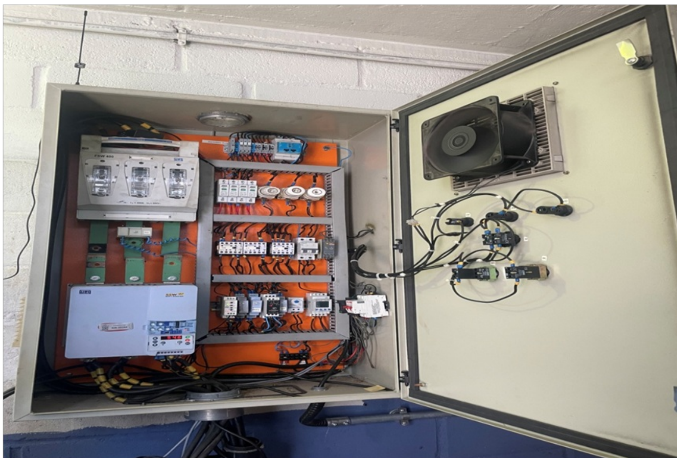
Foto 5 - Painel de controle.
