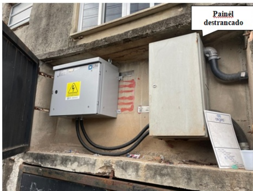
Foto 7 – Painéis de controle da EEAT em bom estado de conservação, o da esquerda possuindo sinalização e corretamente trancado e o da direita encontrava-se destrancado e sem sinalização.
