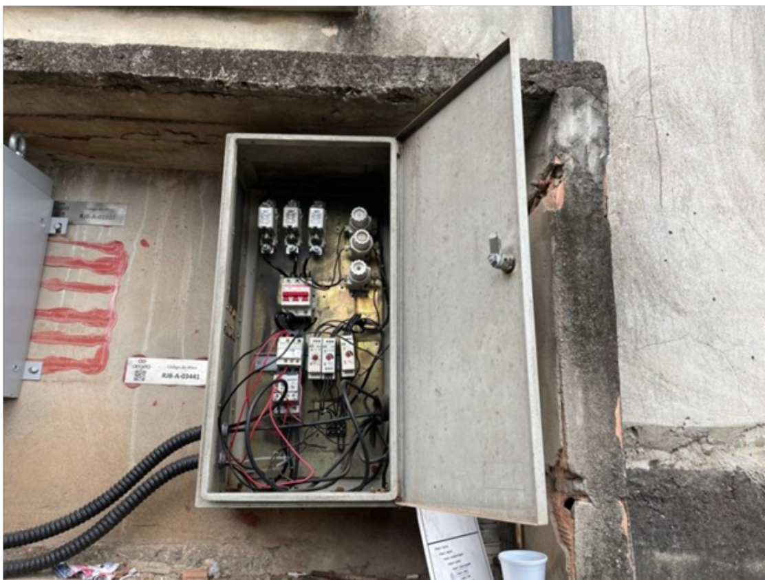
Foto 8 – Painel destrancado e sem sinalização de risco de choque elétrico.
