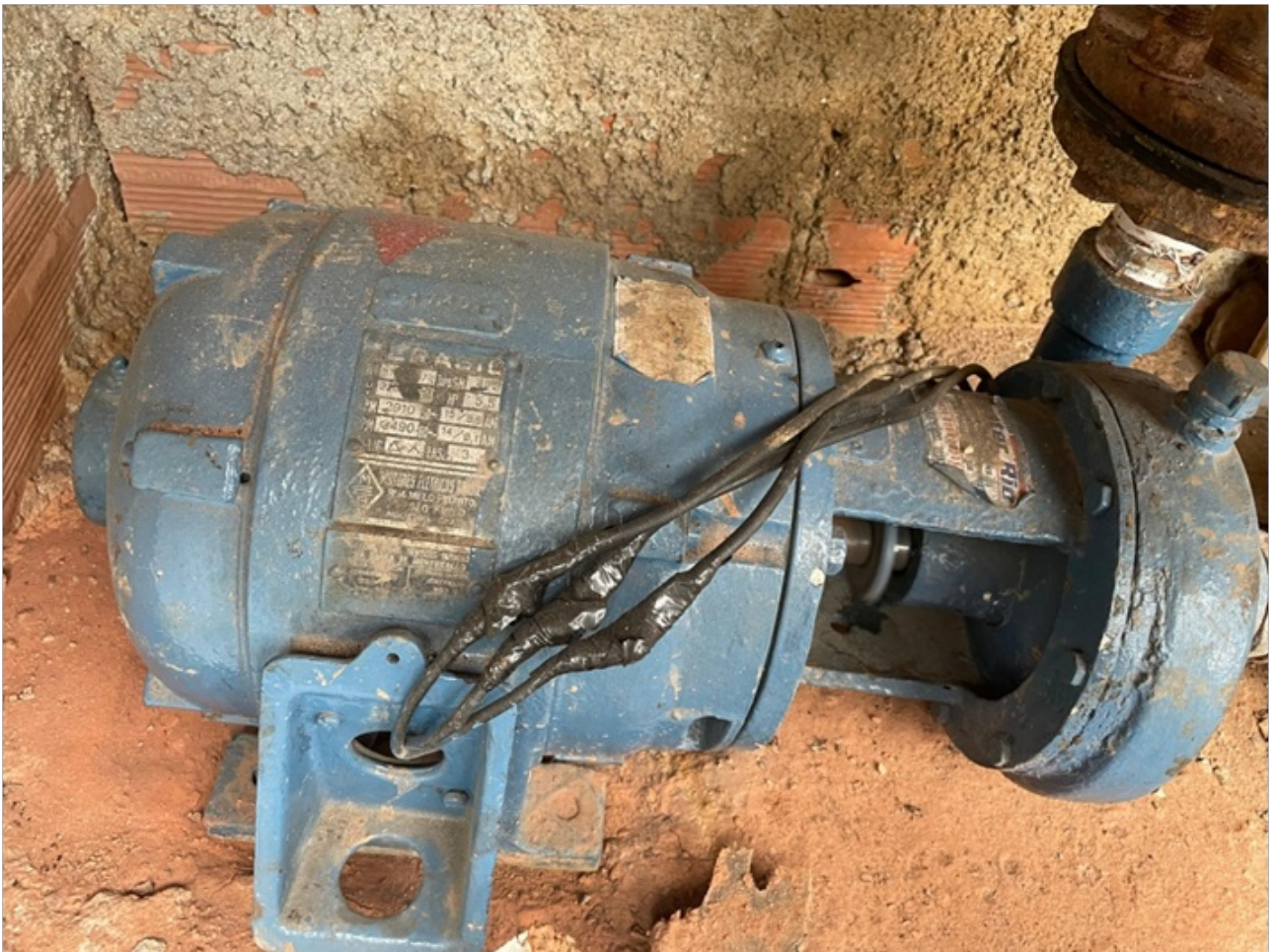
Foto 4 – Motobomba da EEAT.
