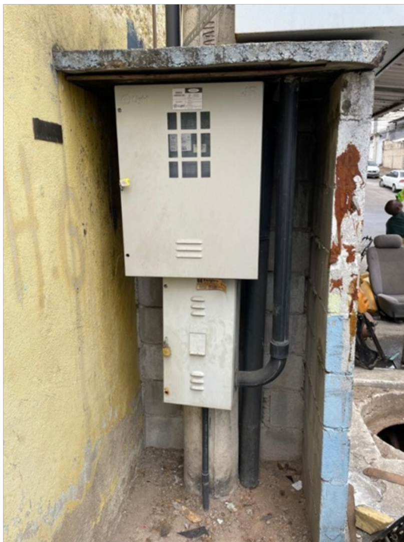
Foto 7 – Abrigo do painel elétrico da EEAT devidamente trancado.
