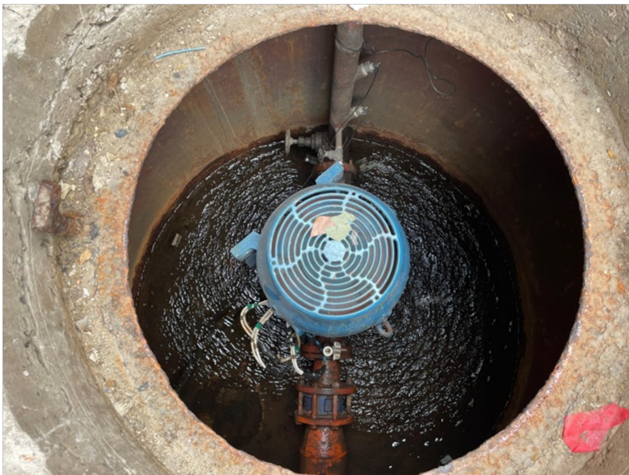
Foto 3 – Abrigo subterrâneo do conjunto motobomba com a presença de água proveniente de chuva.
