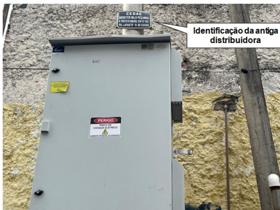
Foto 2 – EEAT com identificação da antiga distribuidora CEDAE.
