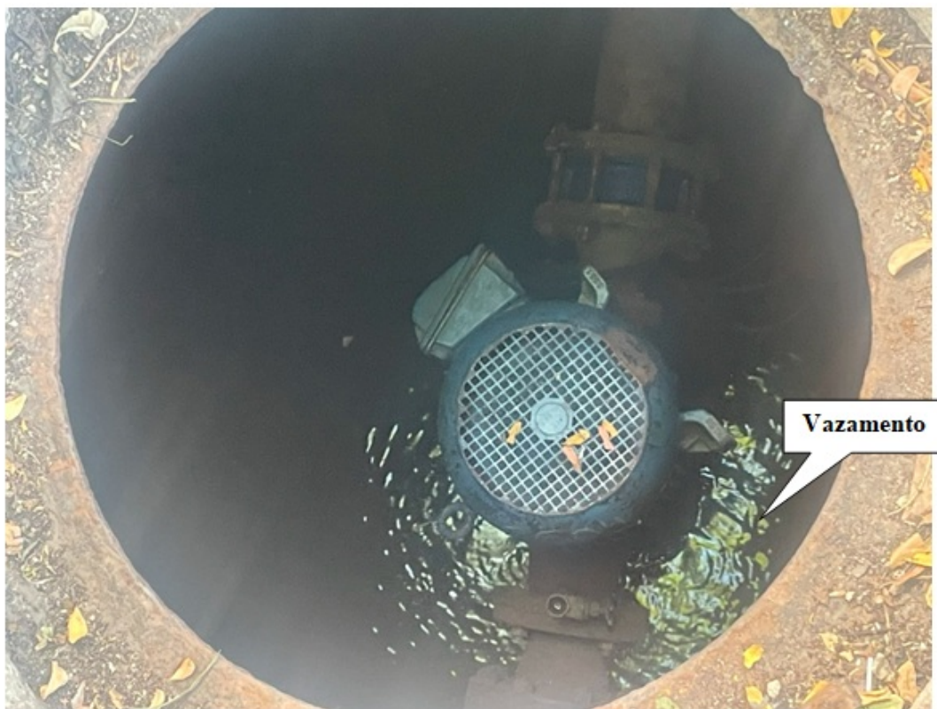
Figura 4 - Conjunto motobomba instalado na EEAT com sinais de vazamento.
