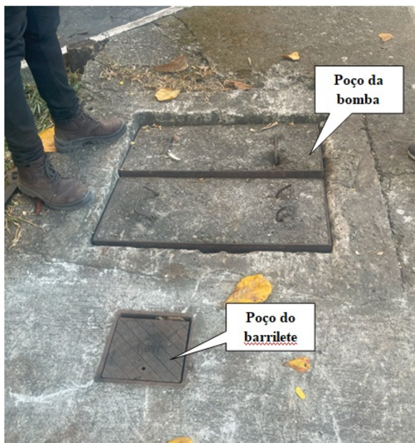
Figura 2 – Poço da bomba e poço do barrilete fechados
