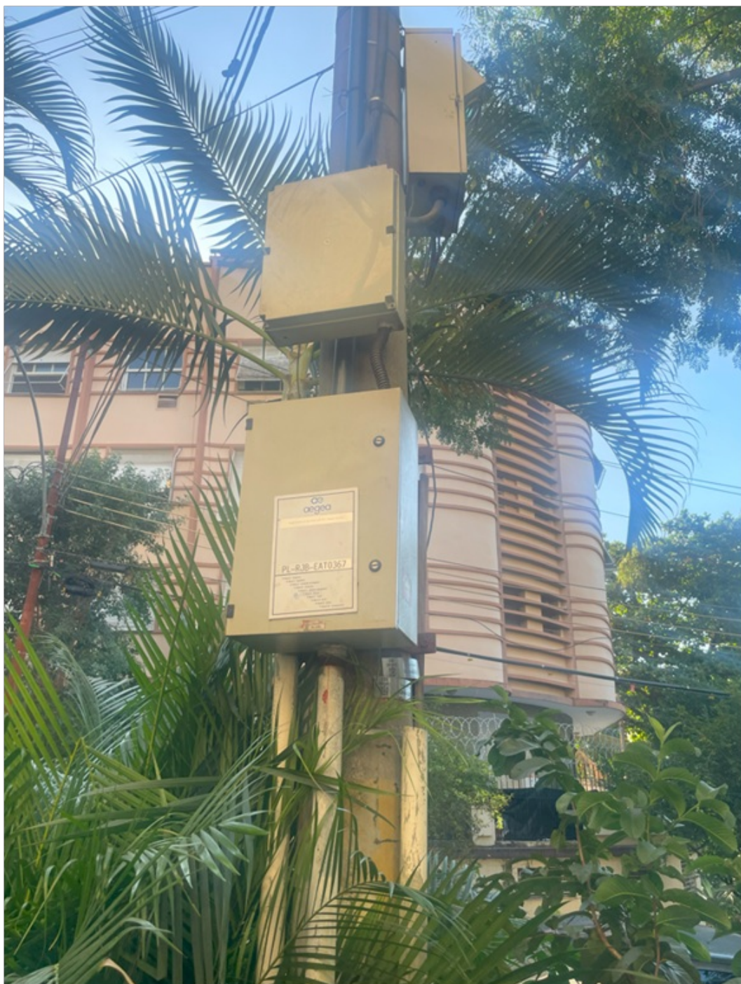
Figura 5 – Painel elétrico fechado
