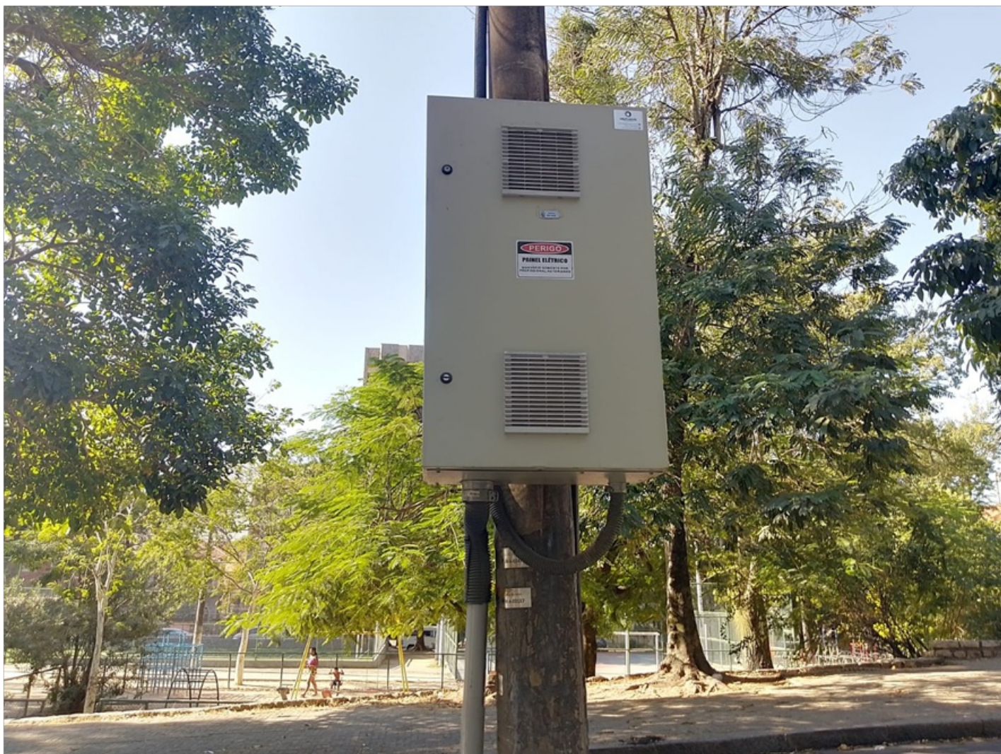
Figura 4 – Pannel elétrico fechado
