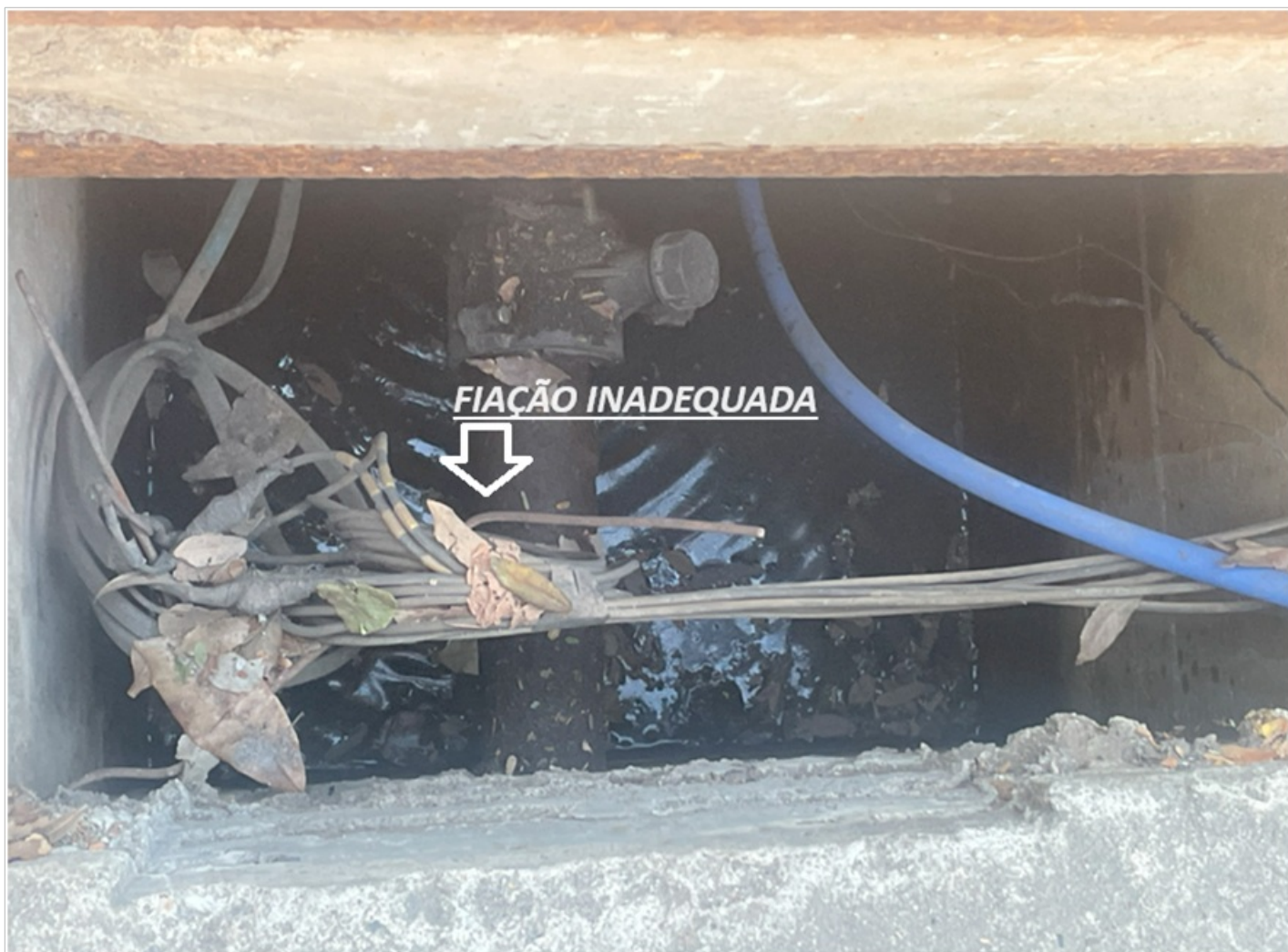
Figura 3 – Visão interna do poço da bomba
