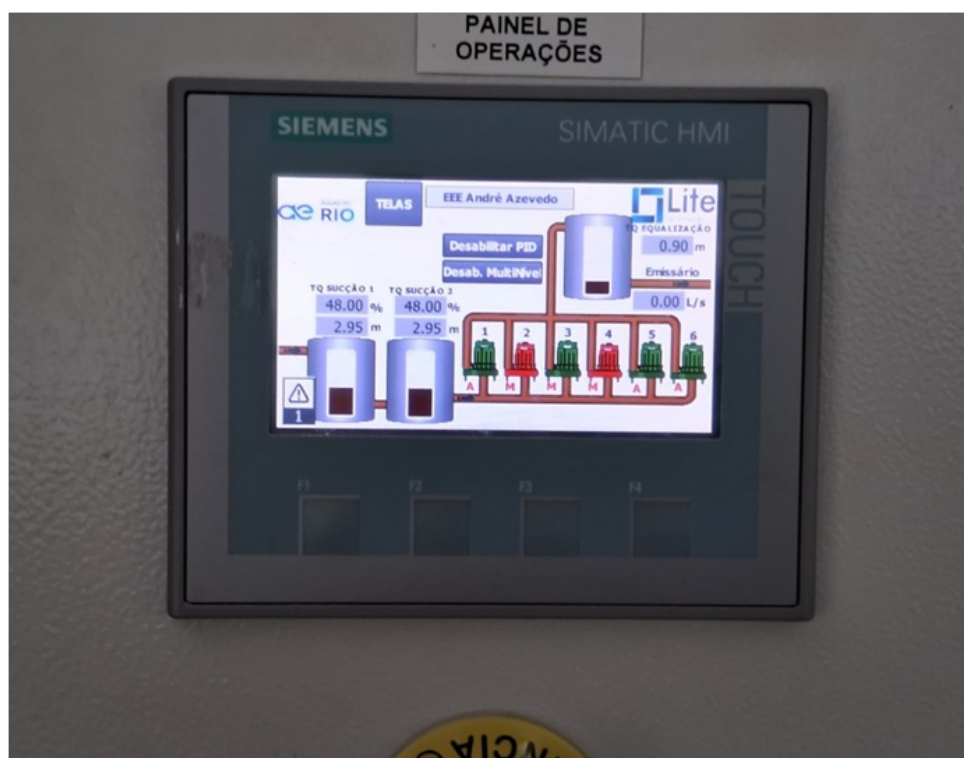
Foto 14 – Painel de operação
