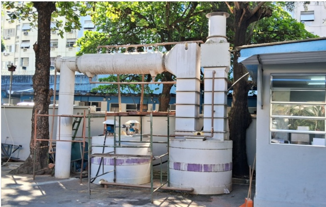
Foto 19 – Lavador de gases
