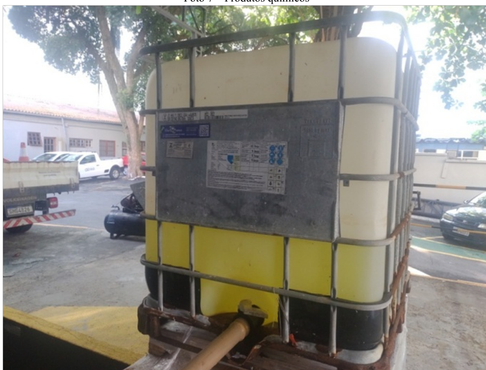
Foto 8 – Tanque de hipoclorito
