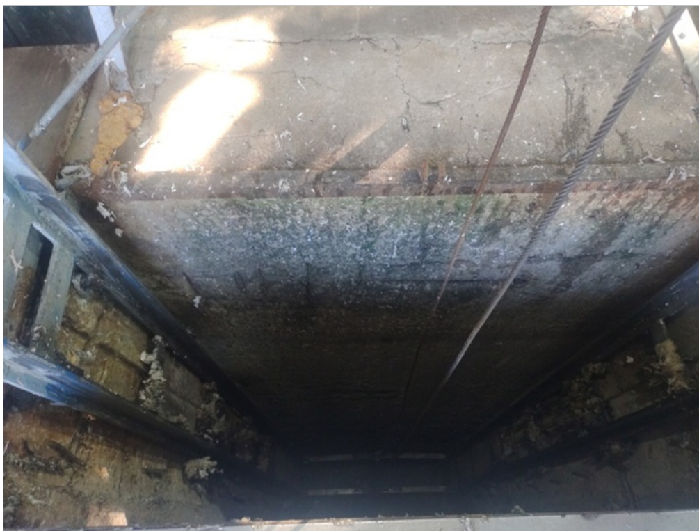
Foto 5 – Poço de gradeamento
