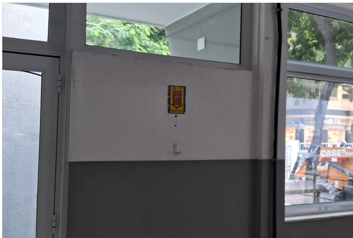
Foto 10 – Local para extintor, sem extintor hall de operação
