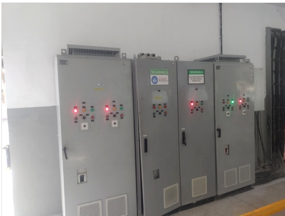
Foto 13 - Quadros de comando
