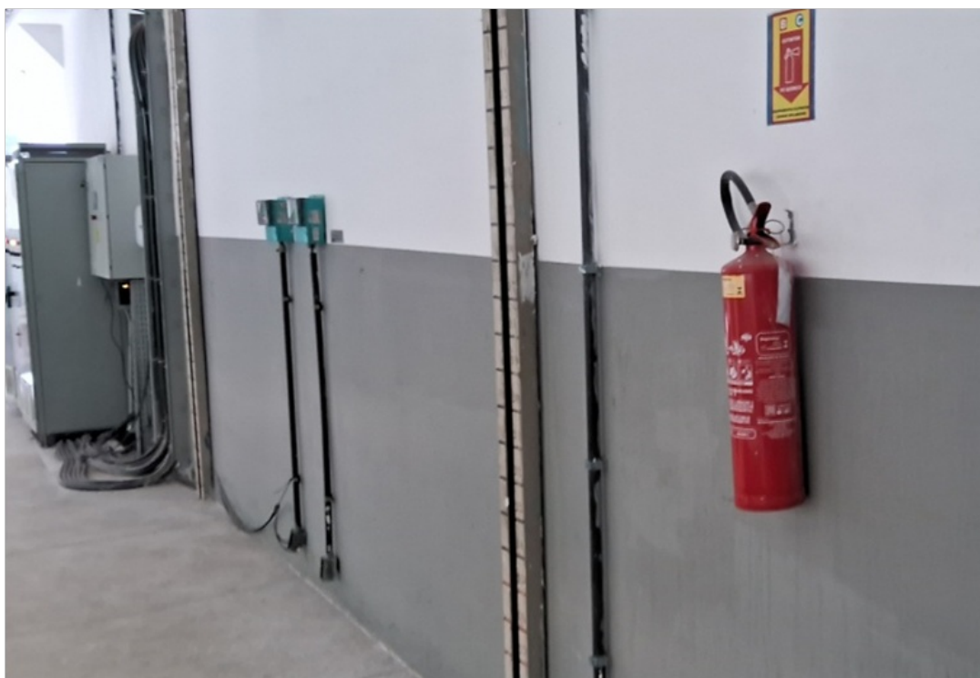
Foto 11 – Extintor hall de operação
