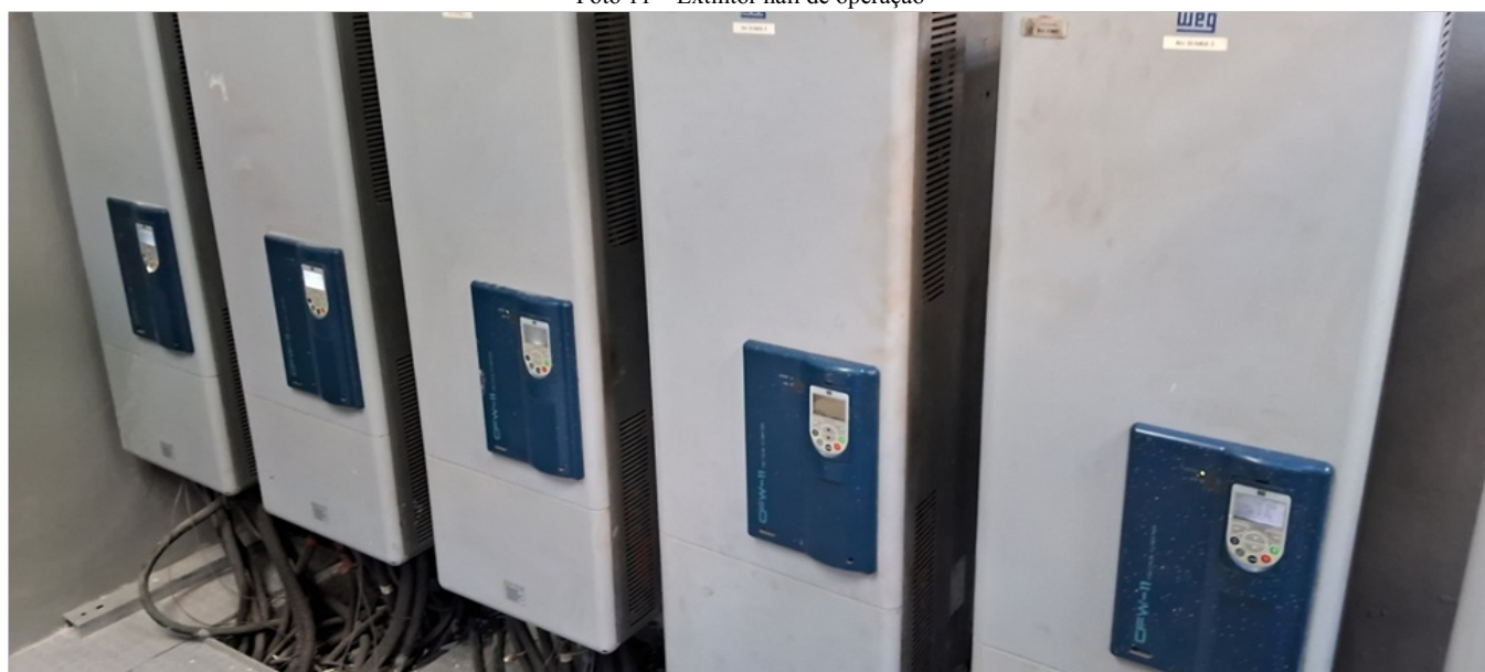
Foto 12 – Inversores de frequência
