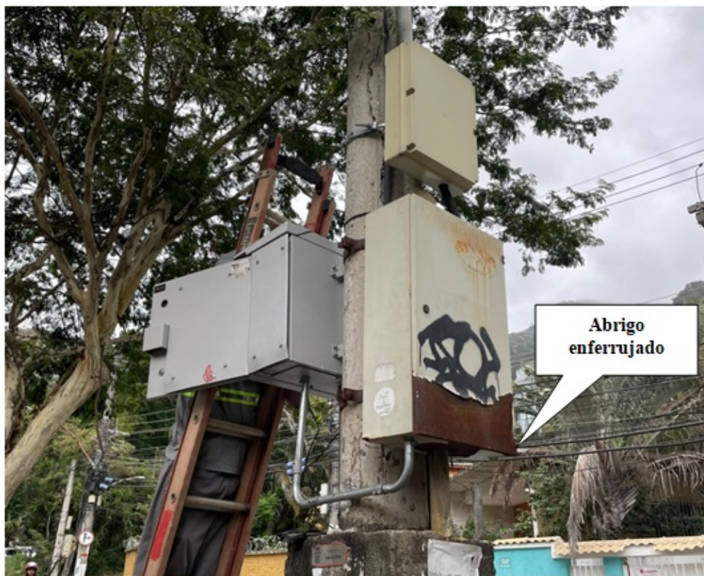
Foto 5 - Abrigo do painel de controle enferrujado e trancado.
