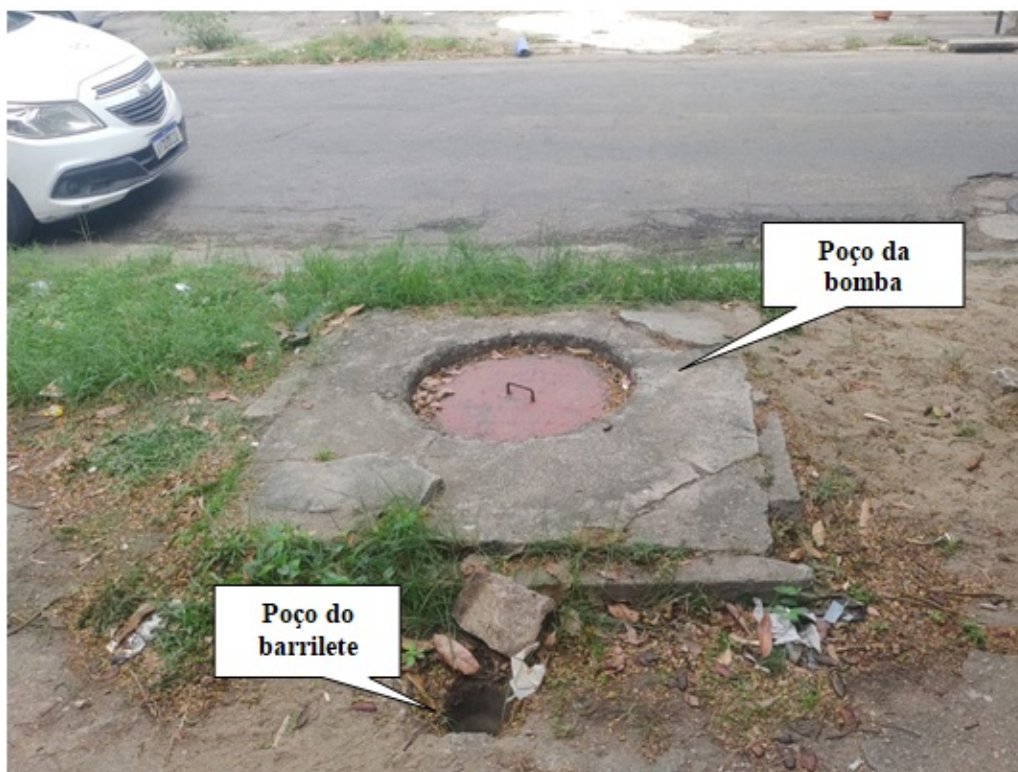
Foto 1 - Localização da EEAT na calçada da via pública.
