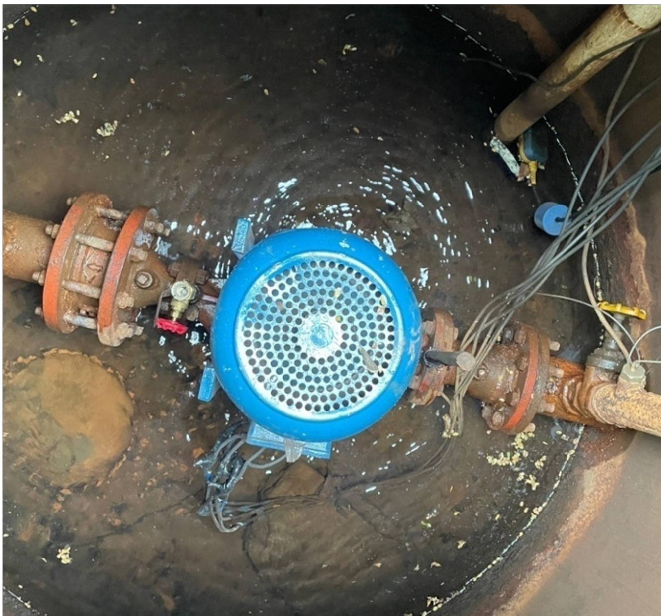
Foto 4 - Motobomba apresentando sinais de vazamento.
