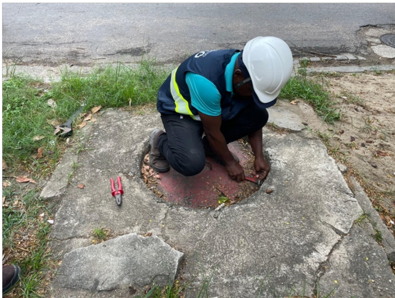
Foto 2 - Colaborador da Concessionária abrindo o tampo de ferro do poço da bomba.
