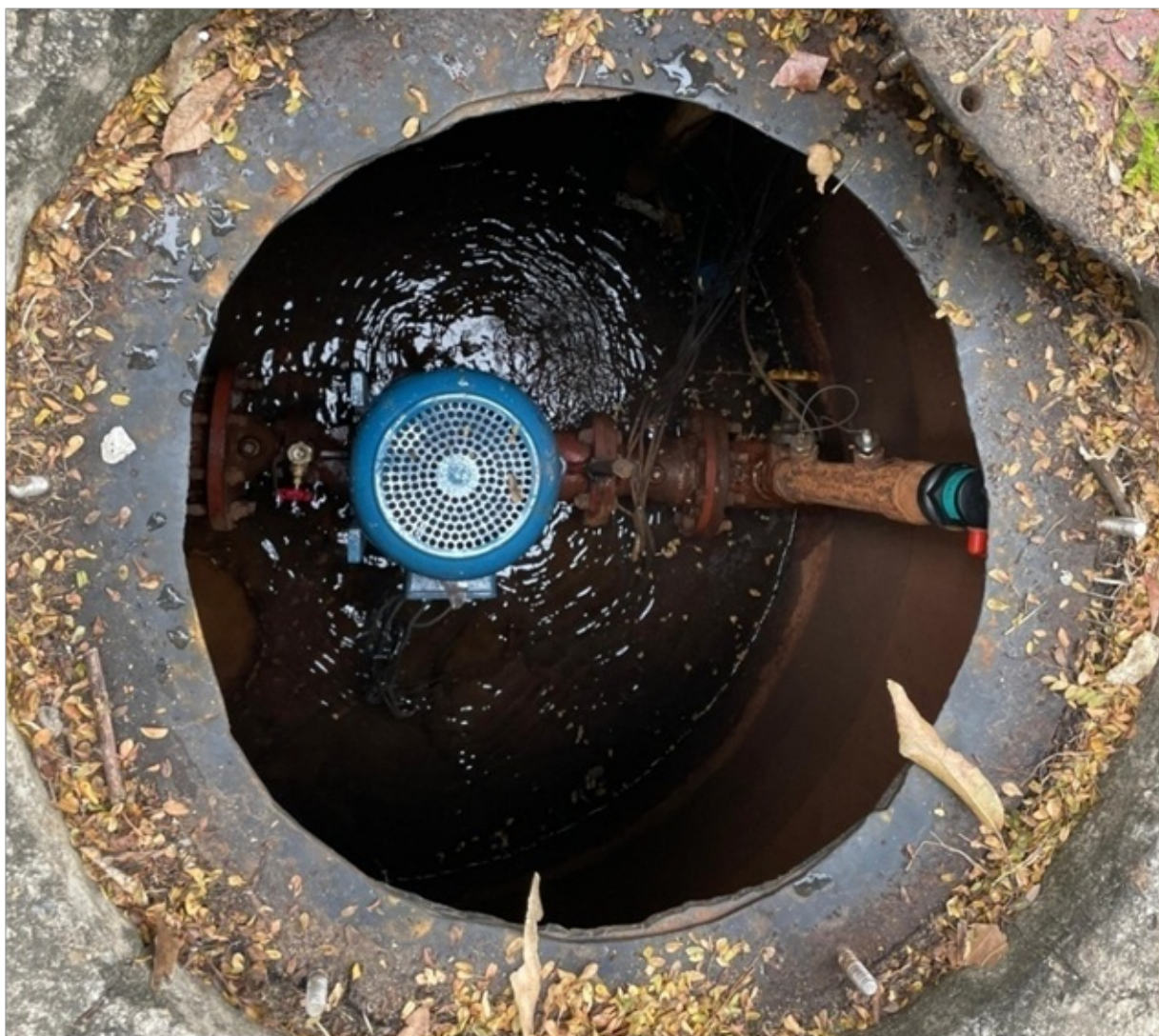
Foto 3 – Poço da motobomba operante da EEAT apresentando água em seu interior (vazamento).
