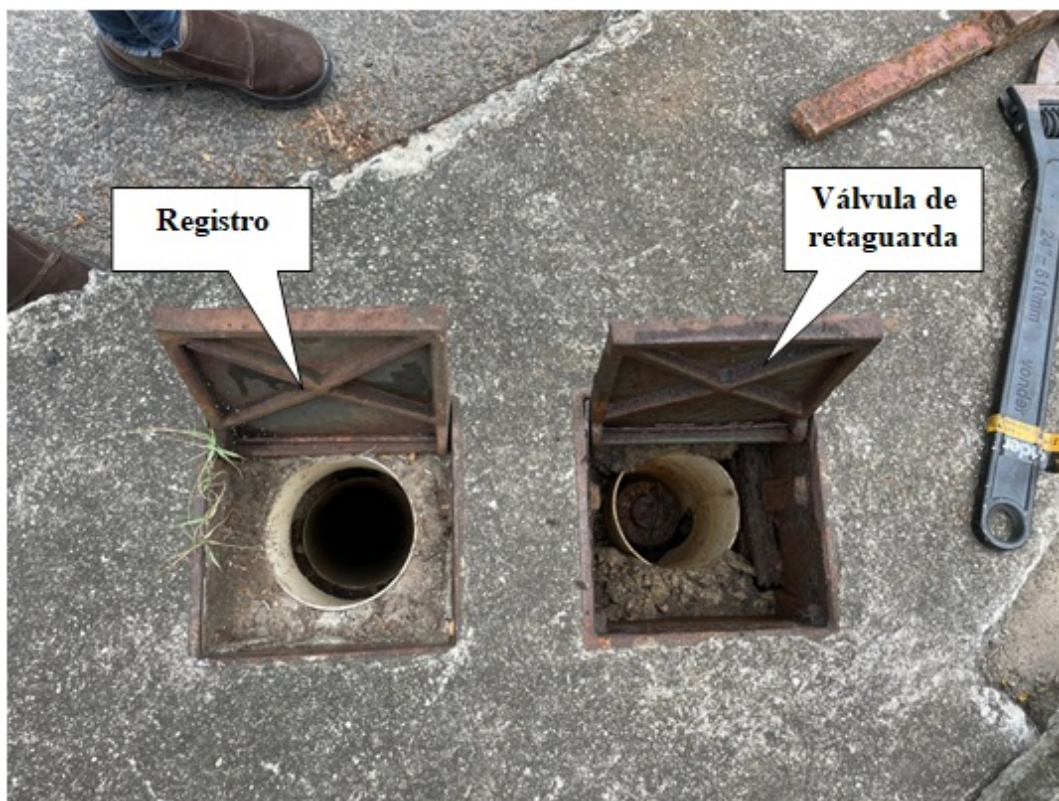
Foto 4 - Localização dos barriletes do registro e da válvula de retaguarda da motobomba.
