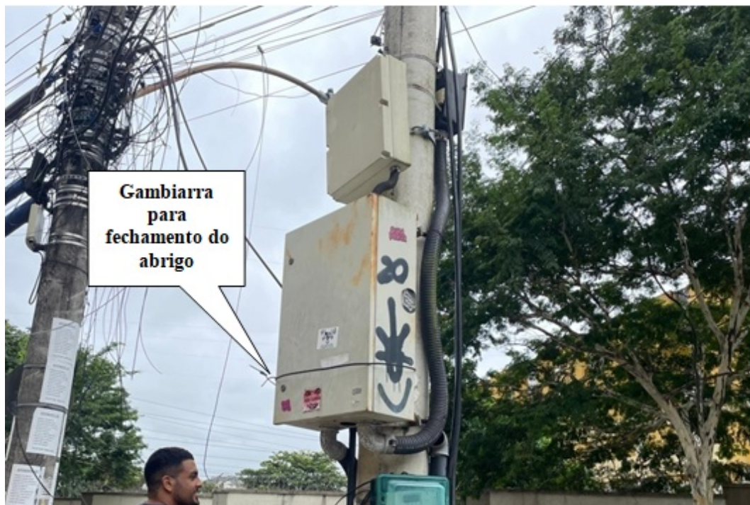
Foto 5 - Painel de controle da EEAT com gambiarra para fechamento do abrigo.
