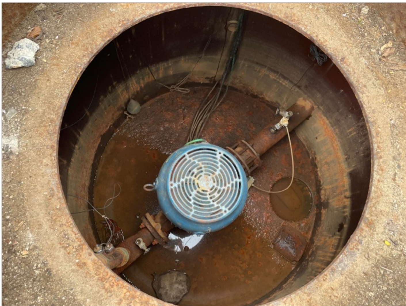
Foto 3 - Conjunto motobomba instalado na EEAT.
