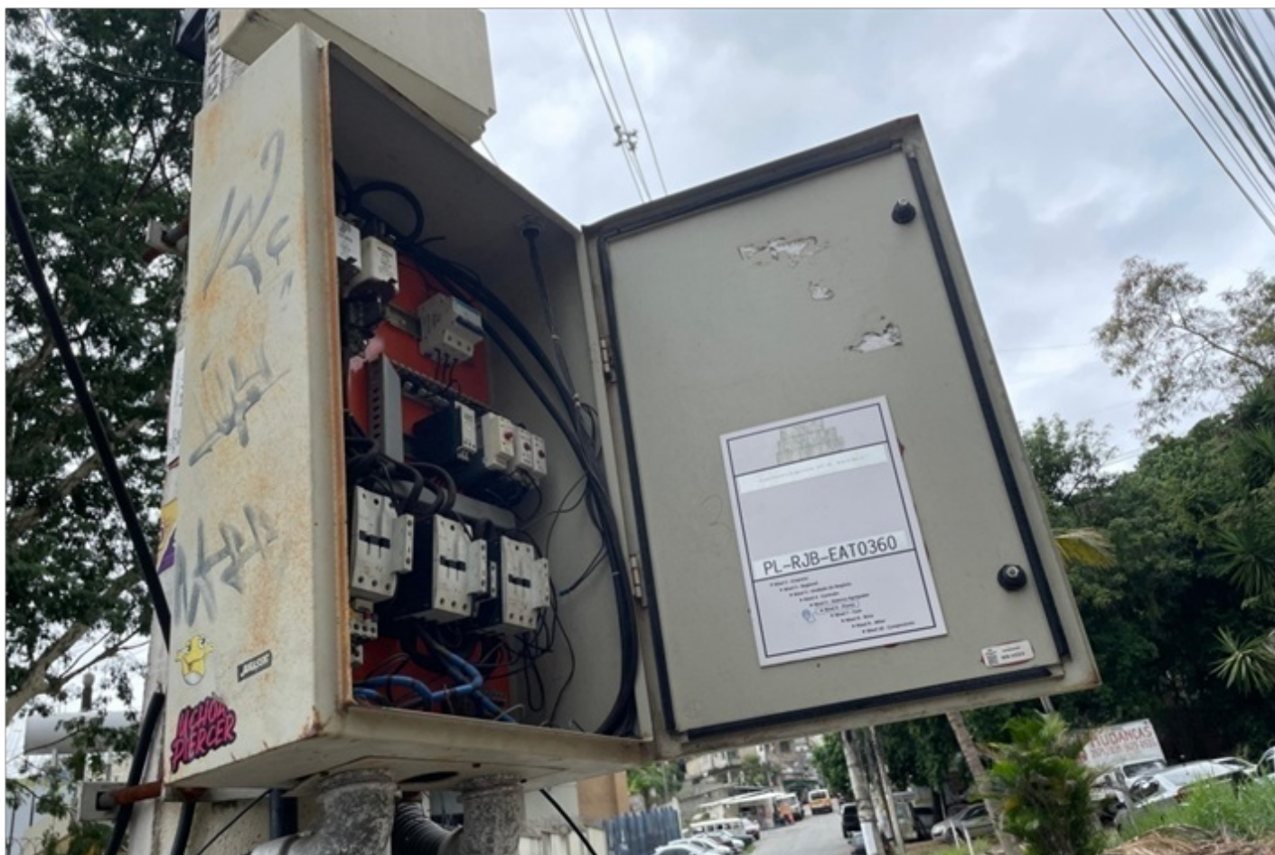
Foto 6 - Painel elétrico da EEAT aberto.
