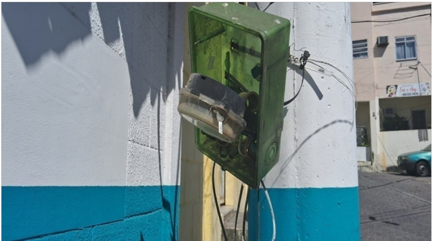
Foto 2 – Instalações elétricas inadequadas.
