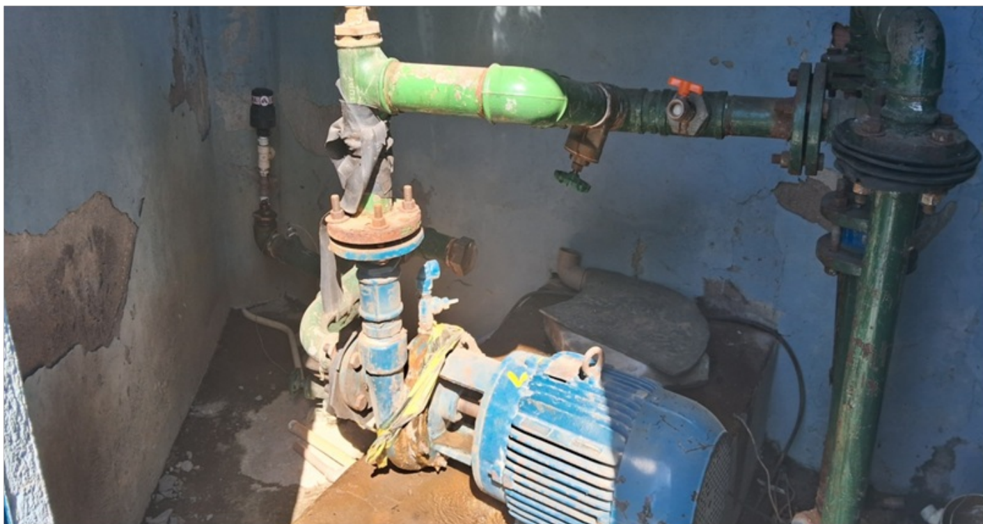
Foto 3 – Vista do conjunto motobomba e barriletes.
