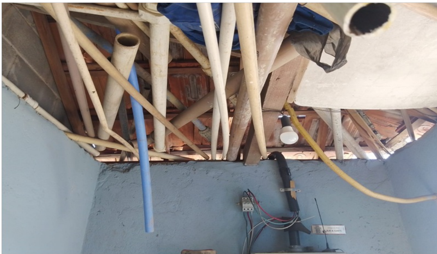
Foto 5 – Disposição inadequada de materiais.
