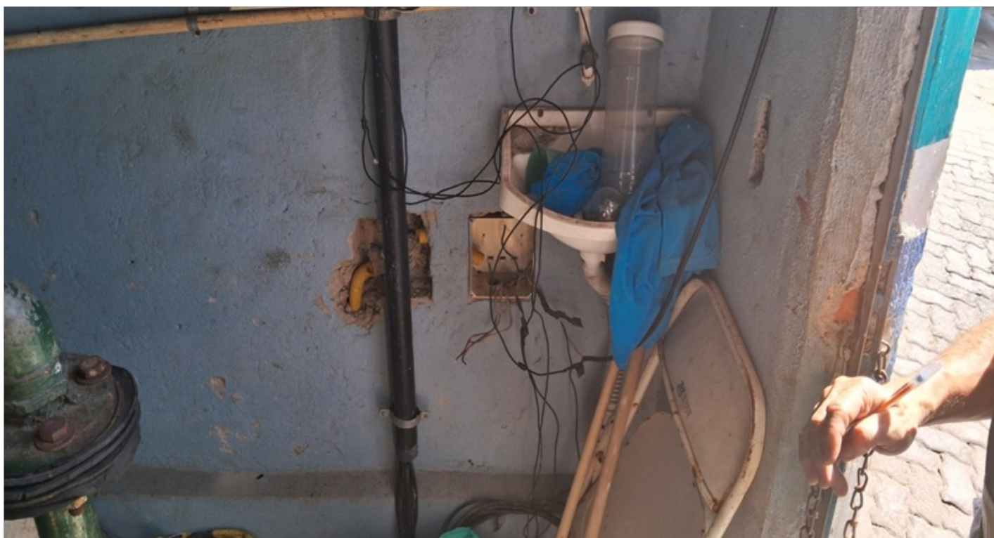
Foto 6 – Falta de proteção das instalações elétricas.
