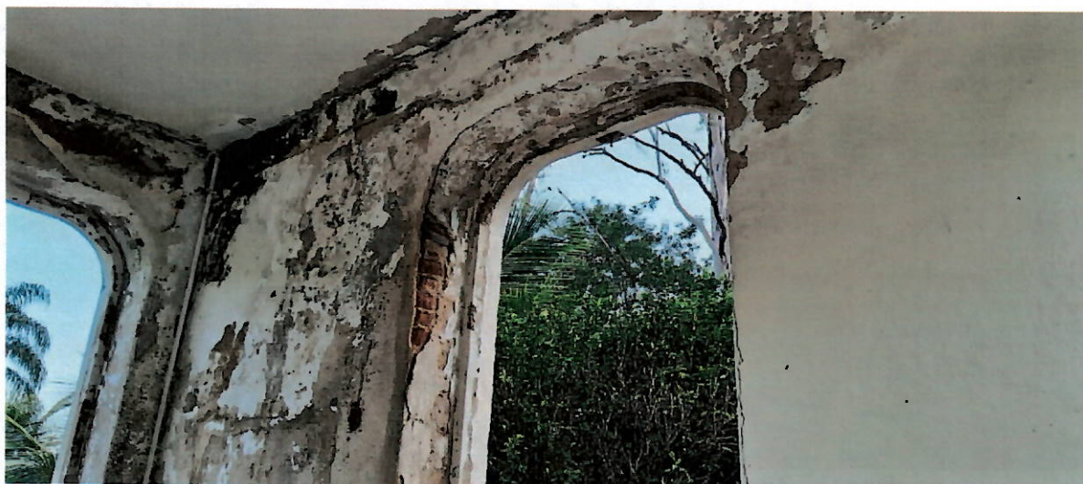
Foto 11 – Vista do interior da casa de química. Destaca-se trecho necessitando de reformas.
