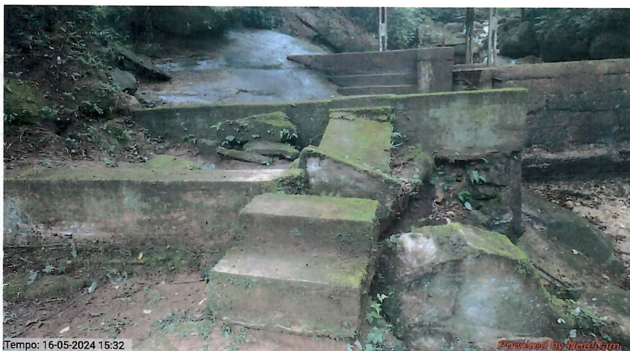
Foto 3 – Trecho danificado da pequena passarela de acesso à Barragem Fazenda.
