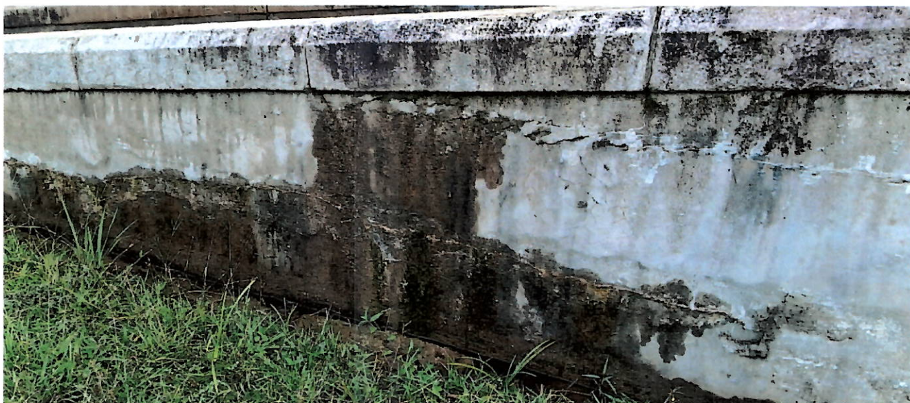
Foto 13 – Área com vazamento na escada hidráulica após a desinfecção.
