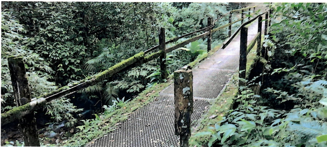
Foto 6 – Pontilhão de acesso a Barragem Meio necessitando reparo no guarda-corpo.
