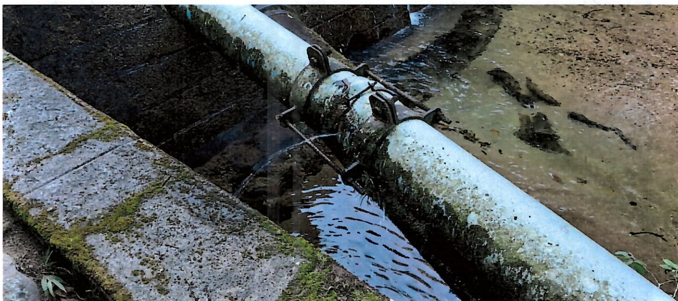
Foto 5 – Adutora de captação da Barragem Meio com vazamento
