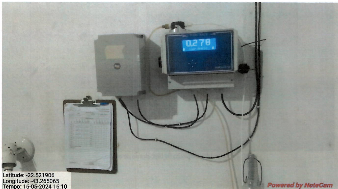
Foto 16 – Turbidímetro online recentemente instalado capaz de fazer medições instantâneas.
