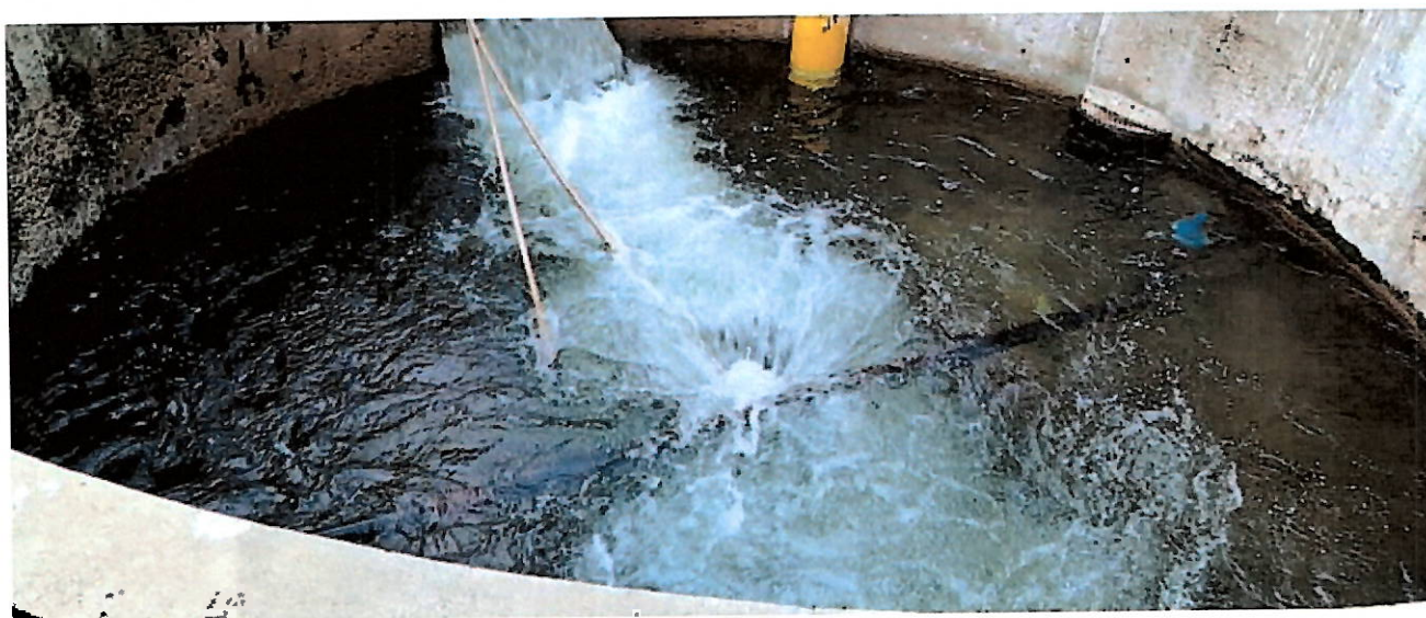
Foto 28 – Vista do tanque onde é realizada em desinfecção.
