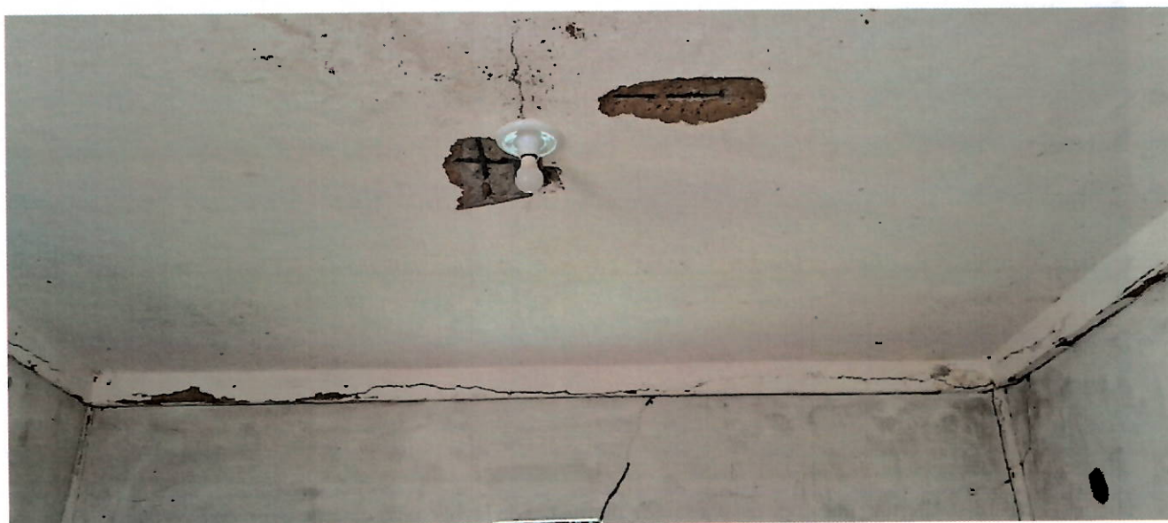
Foto 20 – Rachaduras na estrutura, deslocamento do revestimento e marcas de infiltração no interior da casa de química (Xerém I).
