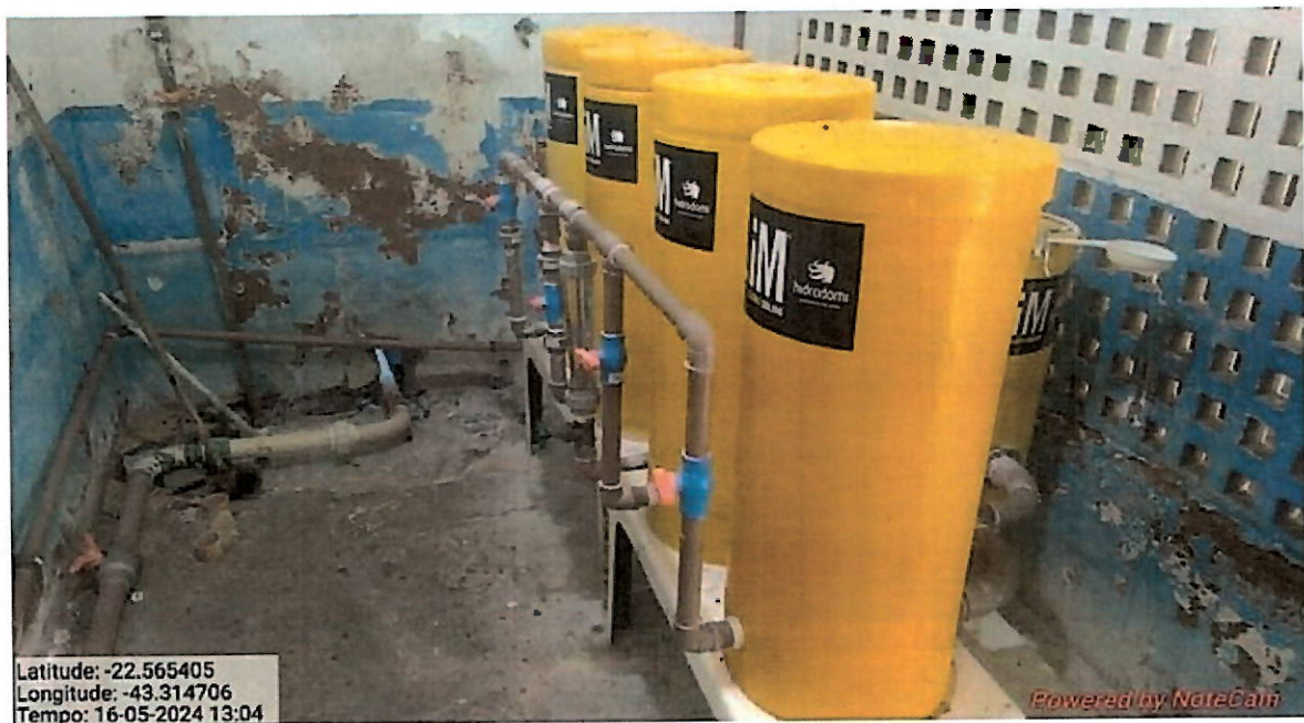
Foto 32 – Sistema de desinfecção reserva (Xerém II). Área interna necessitando melhoria no revestimento.
