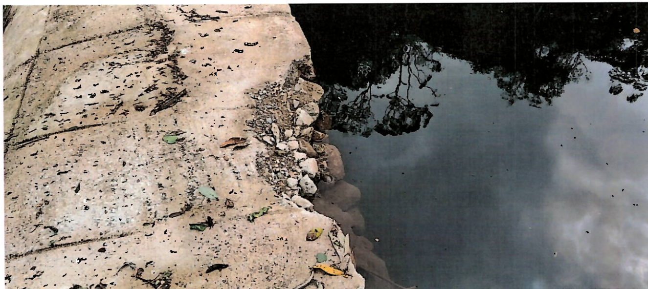
Foto 7 – Área danificada na borda da crista da barragem.
