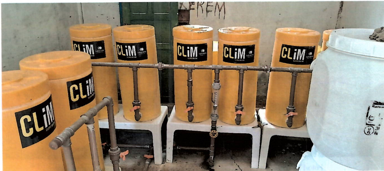
Foto 19 – Vista do sistema de desinfecção com Hipoclorito de Cálcio (Xerém I). Nota-se que o revestimento do piso e das paredes não é adequado para o tipo de atividade, assim como não há instalação sanitária para os efluentes.
