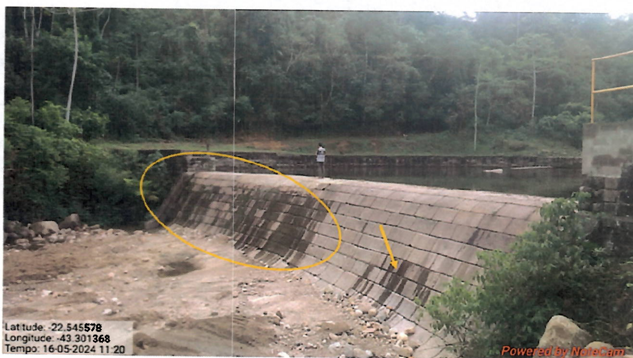
Foto 3 - Vista da face de montante da barragem. Destaca-se as marca de infiltração de água pelo interior da barragem o que pode comprometer a estabilidade da barragem.
