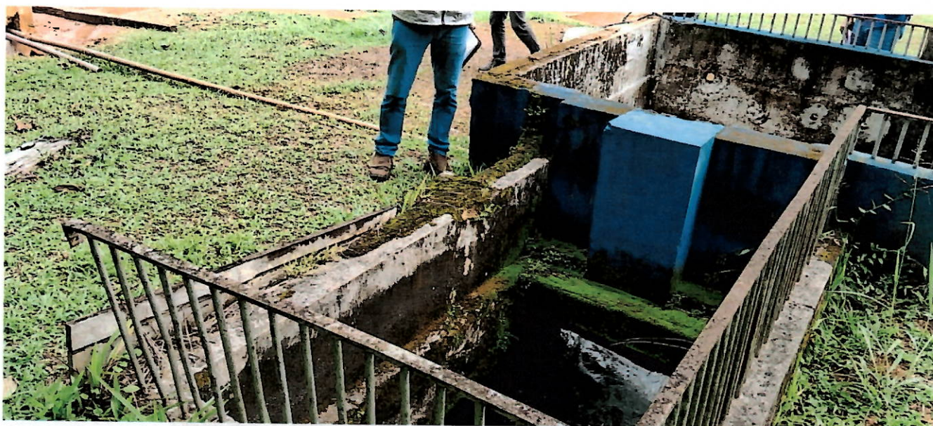
Foto 17 – Trecho com ausência de guarda corpo na área de desinfecção (Xerém I).
