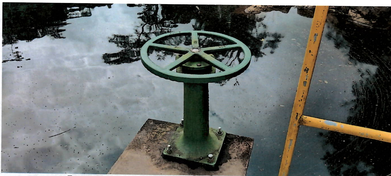
Foto 6 – Volante e pedestal da comporta de captação na Barragem João Pinto.
