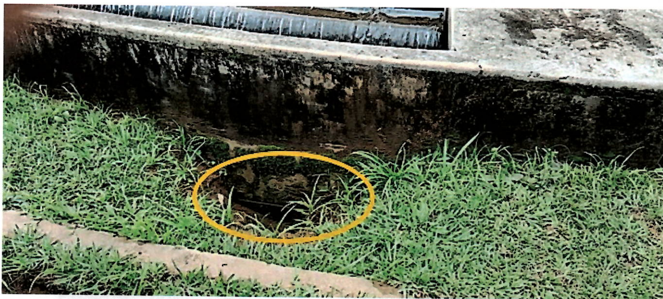
Foto 13 - Área do clarificador com vazamento (Xerém I).
