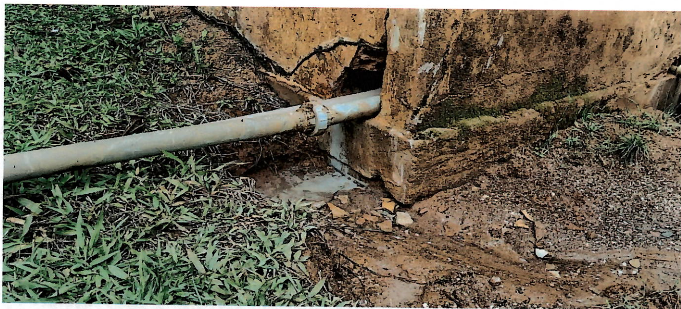
Foto 18 – Abertura por onde estava saindo o efluente da lavagem da casa de química (Xerém I).
