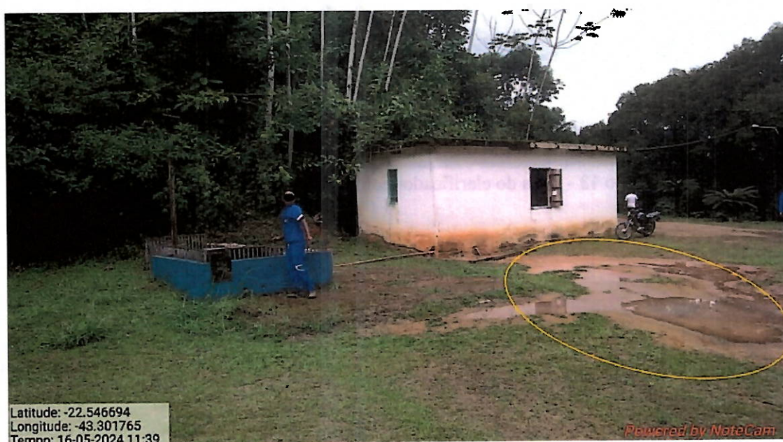
Foto 15 - Vista da área de desinfecção. À esquerda fica o canal de aplicação do desinfetante, à direita a casa de química. Destaca-se também o solo encharcado pelo efluente da lavagem da casa de química.
