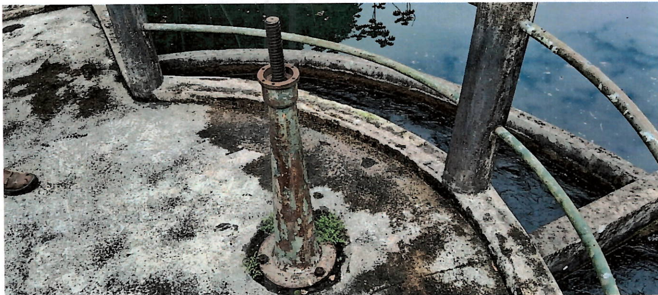
Foto 11 – Registro, localizado na área central do clarificador, sem volante e faltando peça para encaixe do volante (Xerém I).
