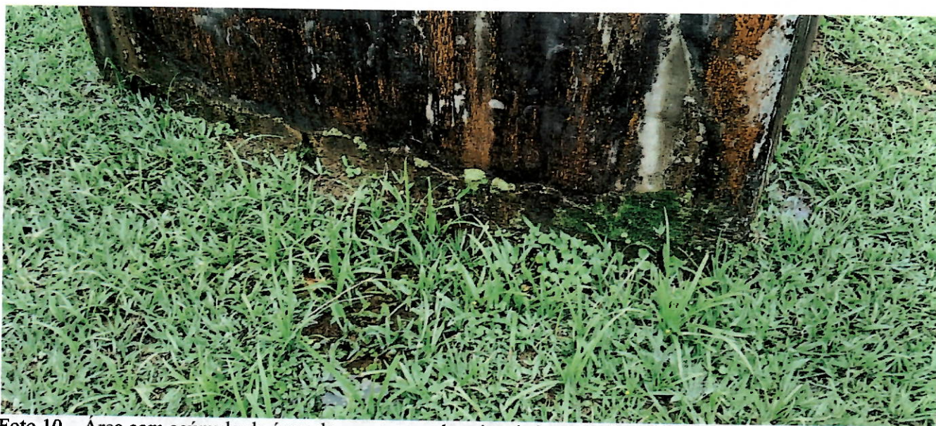
Foto 10 – Área com acúmulo de água do vazamento da caixa de inspeção/amortecimento.
