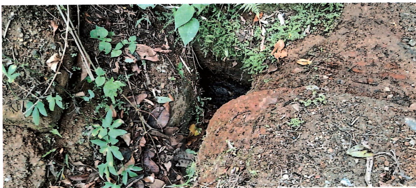
Foto 4 – Infiltração no muro da barragem João Pinto nas proximidades da adutora de captação.
