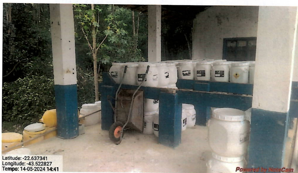
Foto 10 - Armazenamento de hipoclorito de cálcio.
