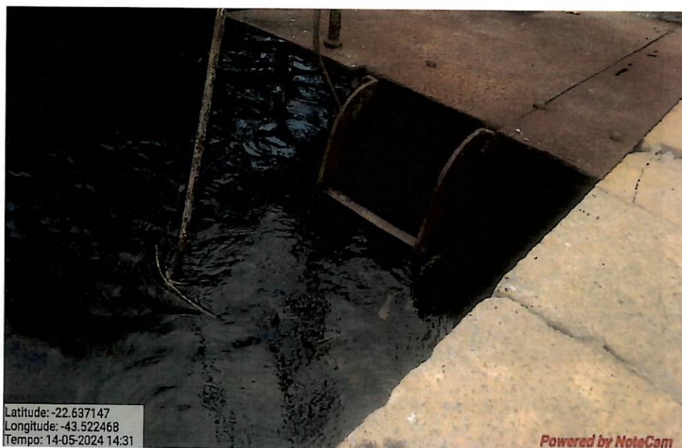
Foto 9 - Reservatórios da UT Rio D'Ouro, Local de Entrada da Água Clarificada.
