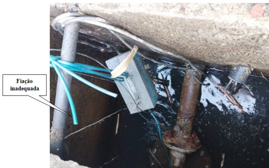
Figura 2 – Poço da motobomba submersa operante da EEAT
