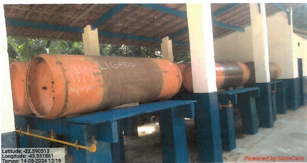
Foto 12 – Posto de Cloração da Unidade de Tratamento.
