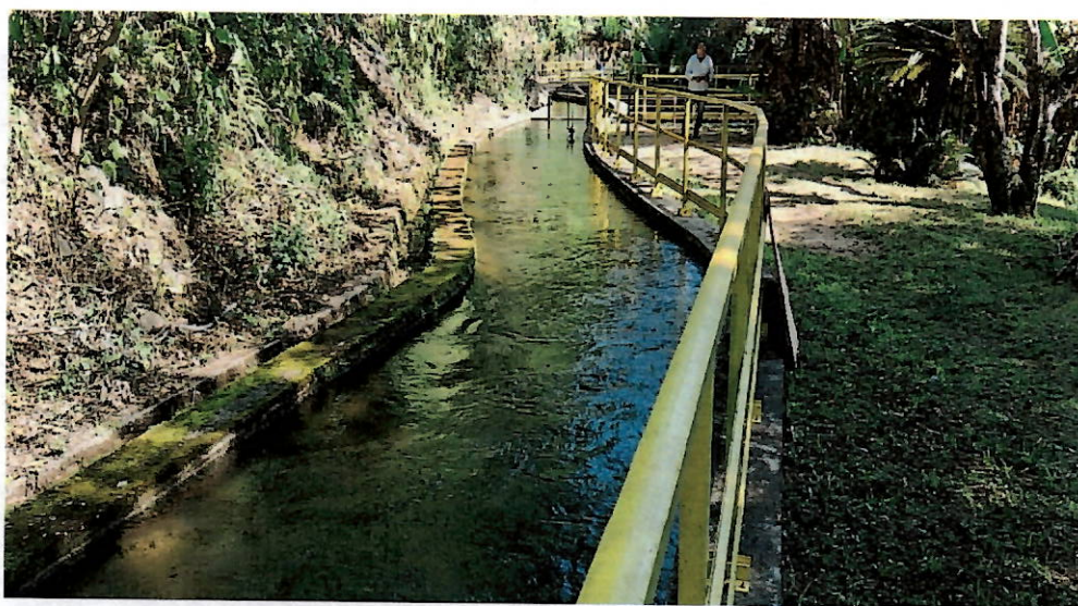
Foto 6 – Canal que direciona para aos decantadores.
