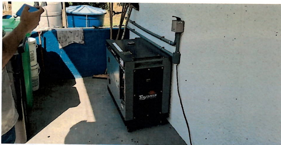
Foto 17 – Gerador de Energia.
