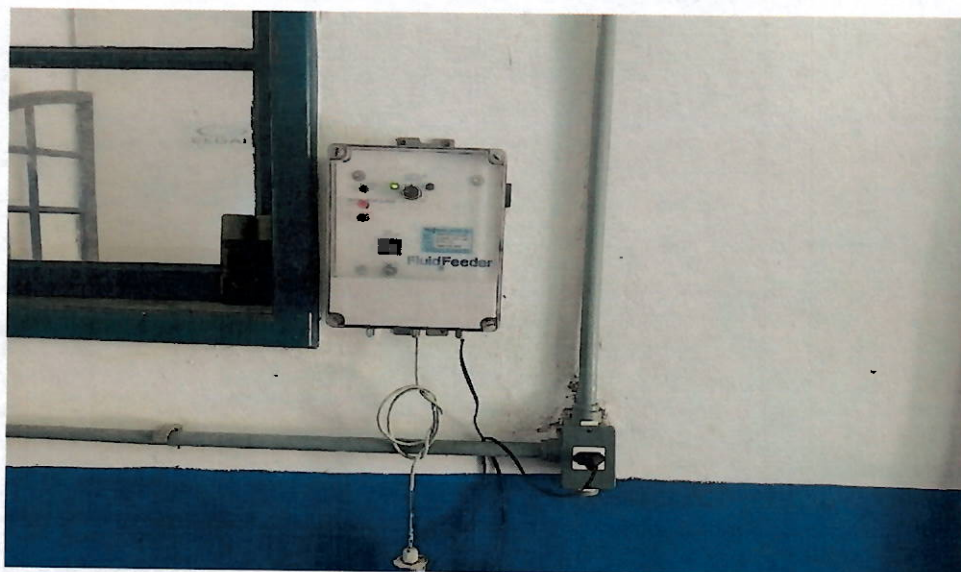
Foto 14 – Aparelho Detector de vazamento de Cloro.
