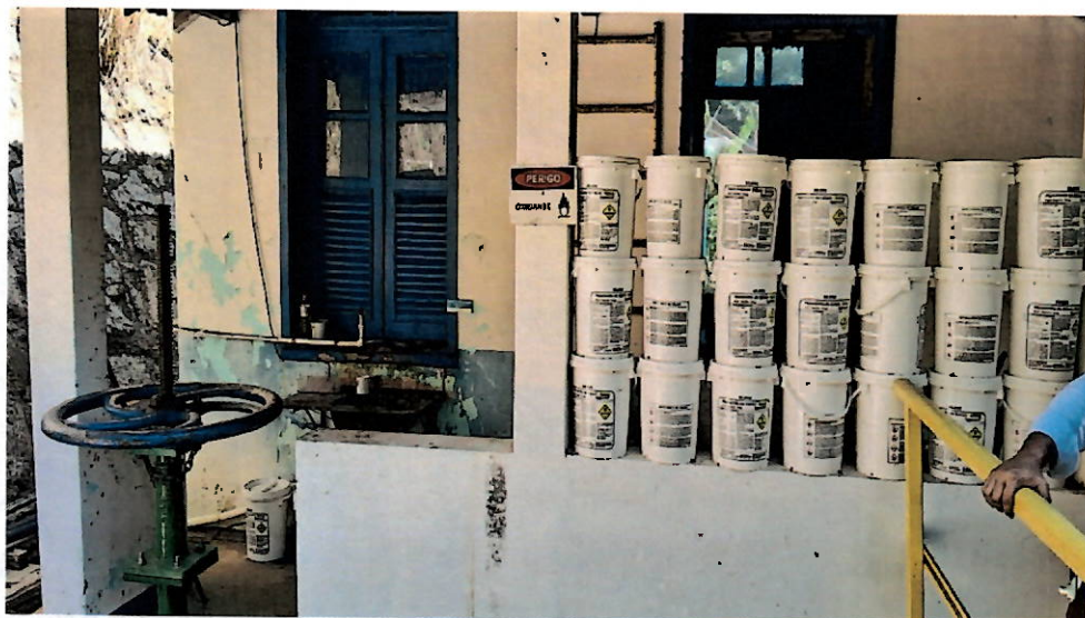
Foto 9 – Armazenamento de hipoclorito de cálcio.
