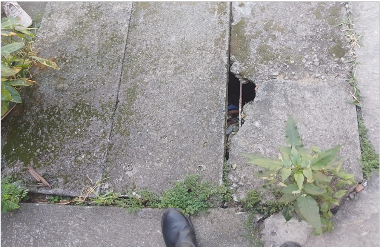
Foto 9 – Parte da tampa de concreto quebrada
