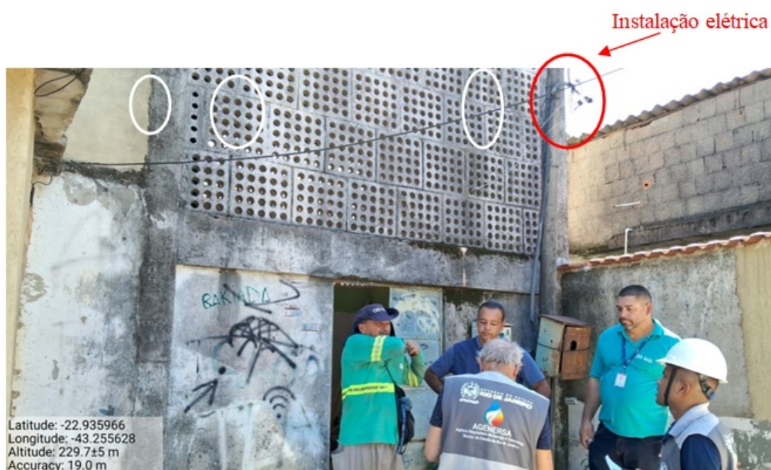
Foto 14 – Instalação elétrica sem proteção
