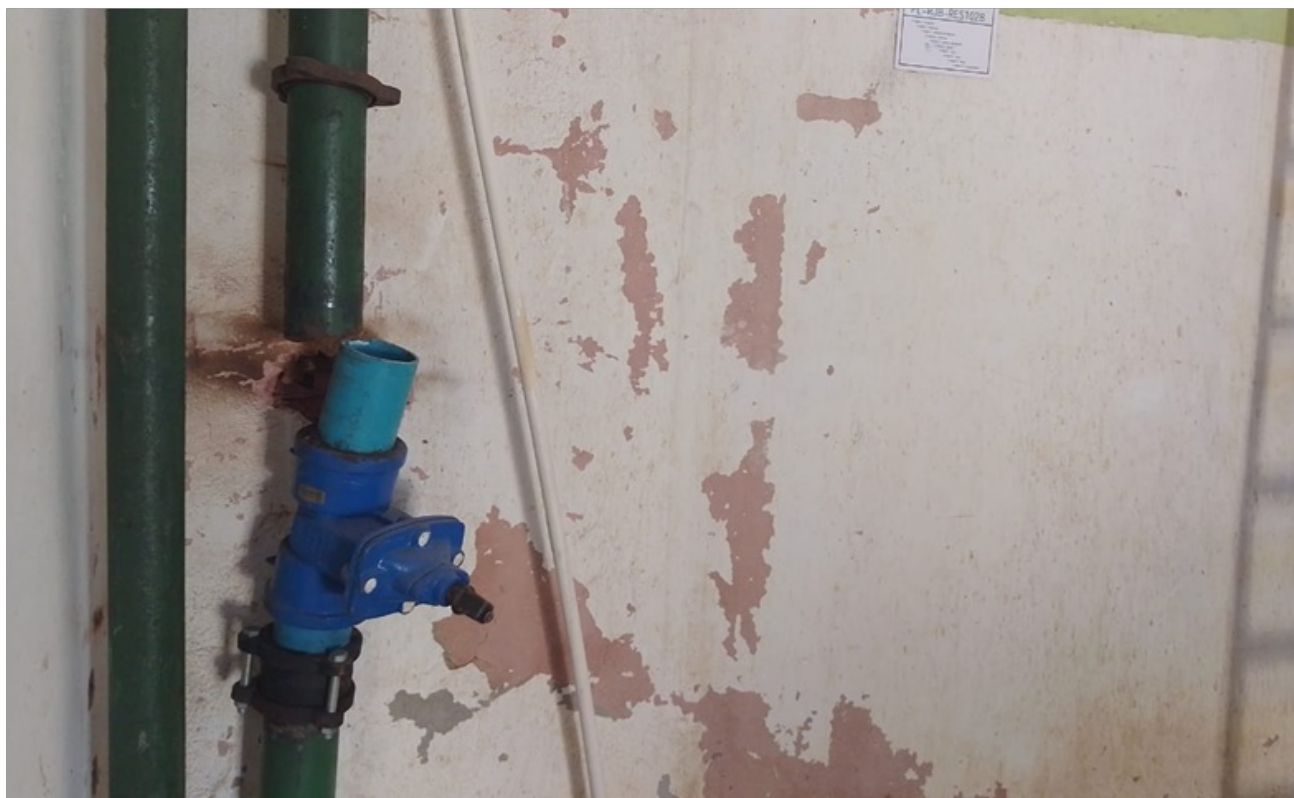
Foto 4 – Tubulação de recalque interrompida
