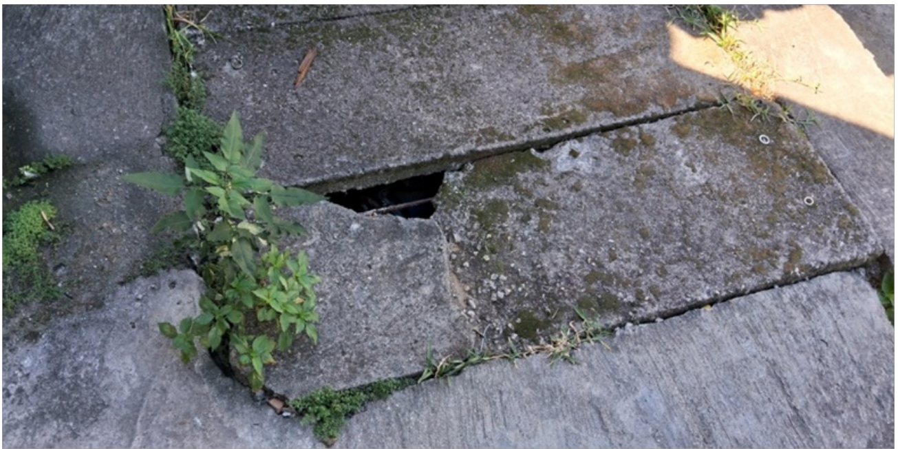
Foto 8 – Parte da tampa de concreto quebrada
