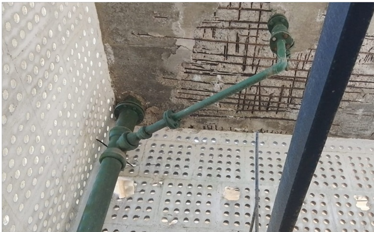
Foto 5 – Tubulações de limpeza
