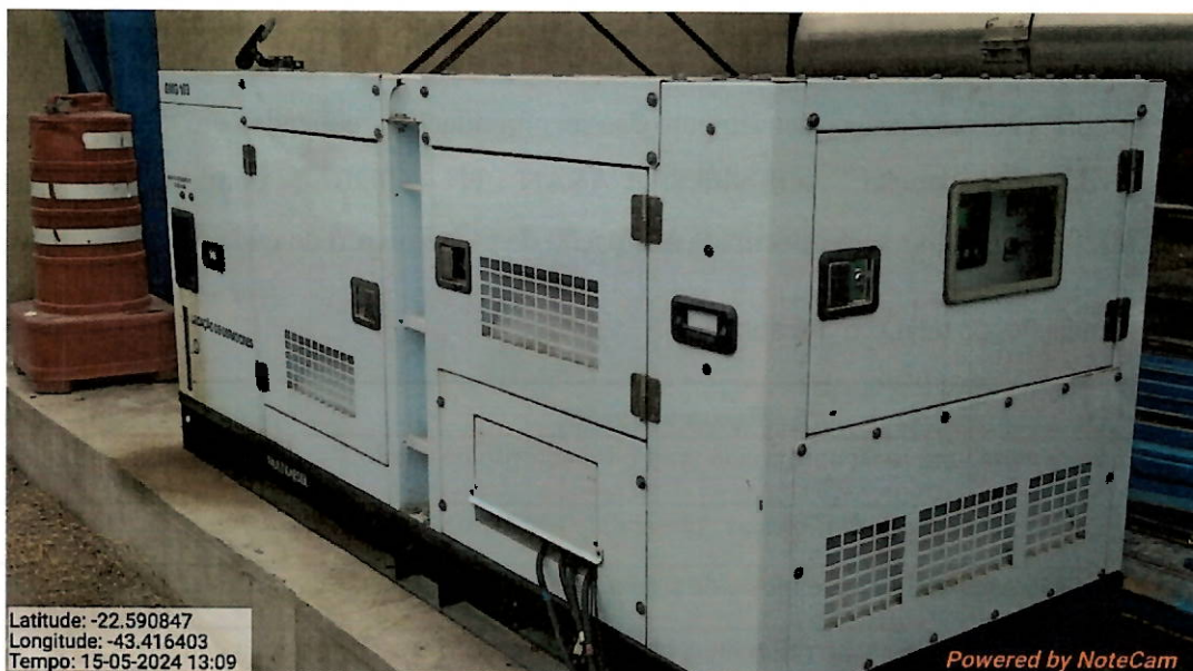
Foto 26 - grupo gerador de energia.
