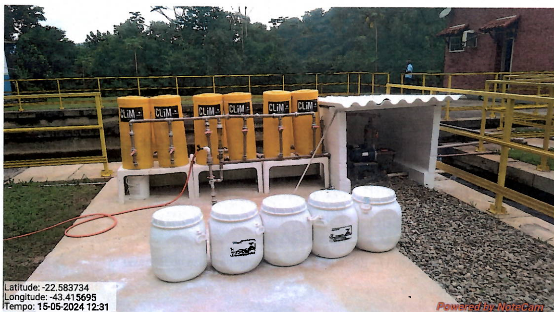
Foto 15 - Sistema de desinfecção com Hipoclorito de Cálcio em pastilhas.
