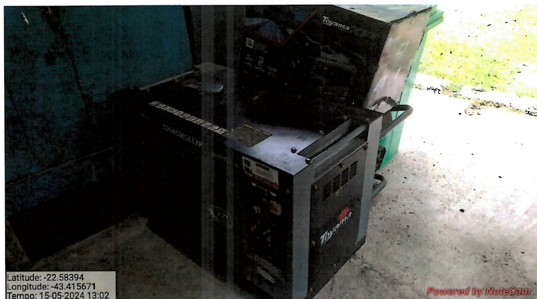
Foto 22 - Gerador de energia.
