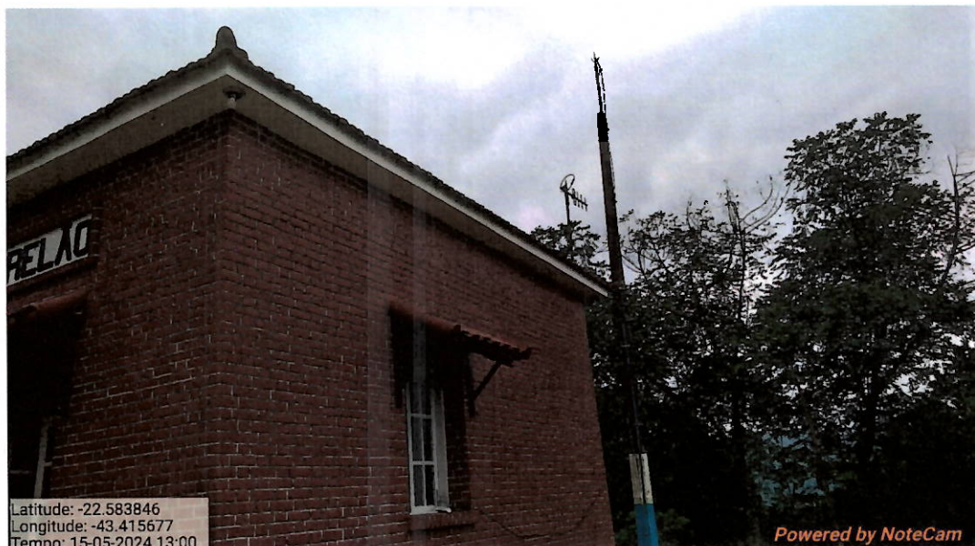
Foto 21 - Sistema de proteção contra descargas atmosféricas.
