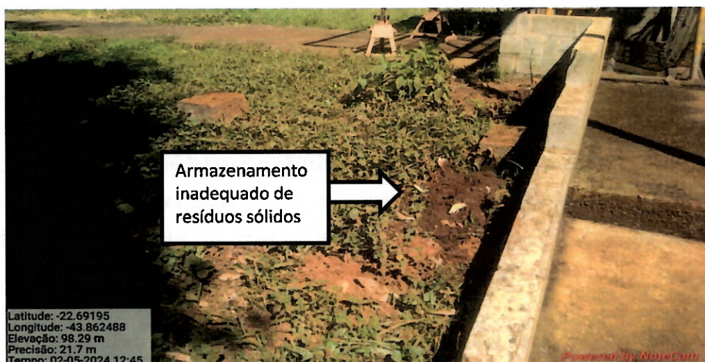
Foto 3 – Resíduos do gradeamento de água bruta.
