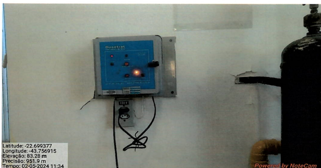
Foto 15- Aparelho Detector de vazamento de Cloro.
