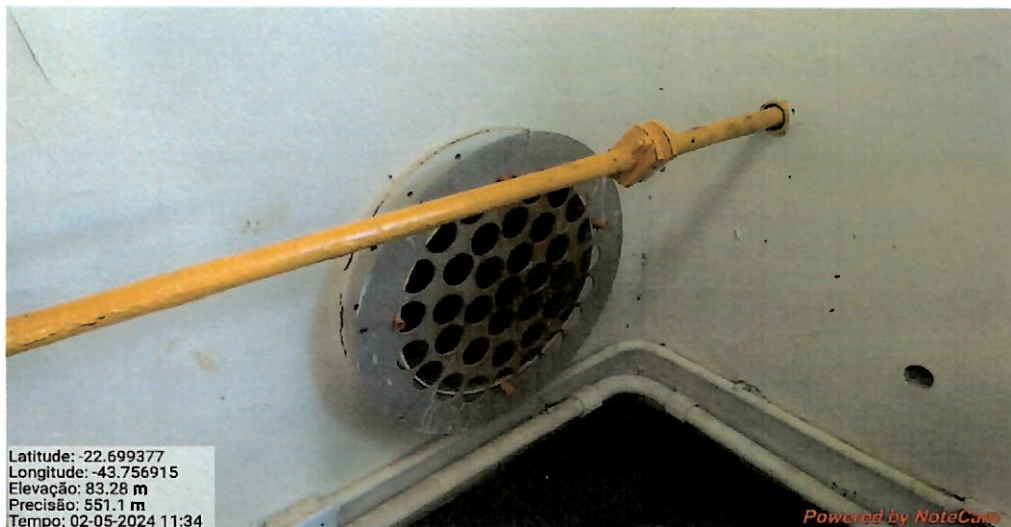
Foto 17- Saída do exaustor na sala que contém os evaporadores.
