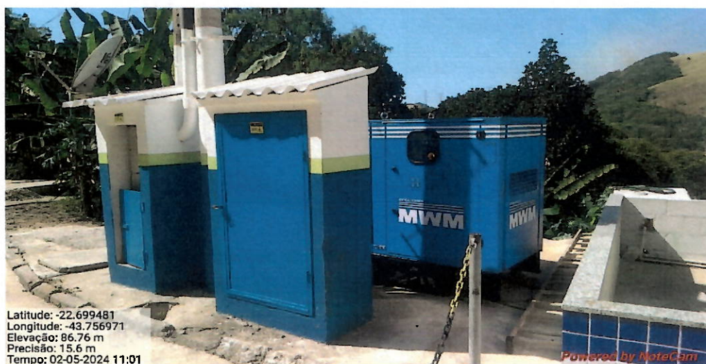
Foto 7 – Gerador de energia da Unidade de Tratamento.
