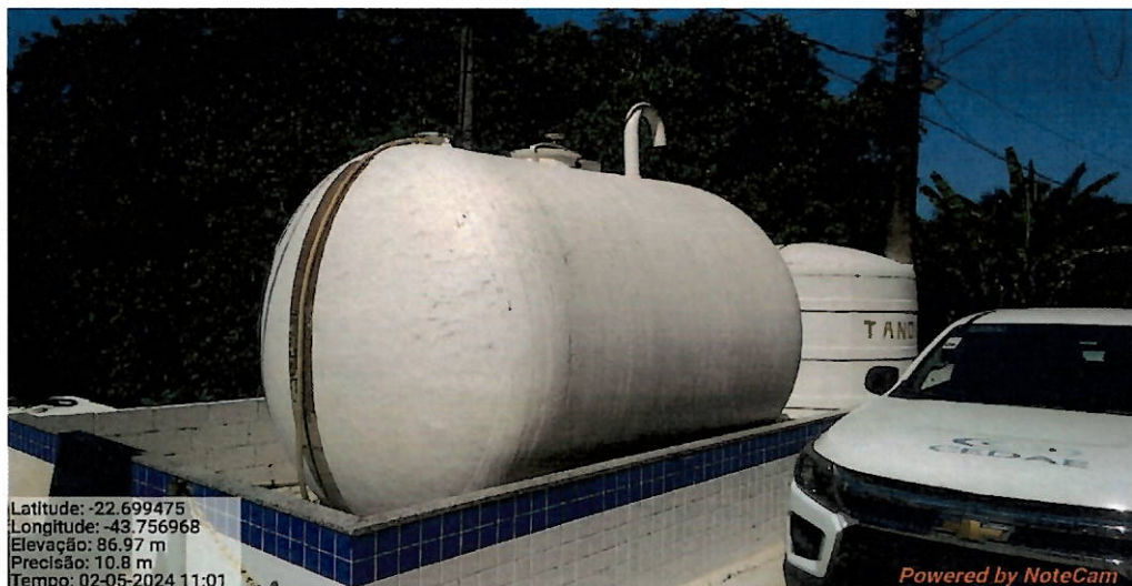
Foto 6 – Reservatório 10.000L contendo ácido fluorsilícico.
