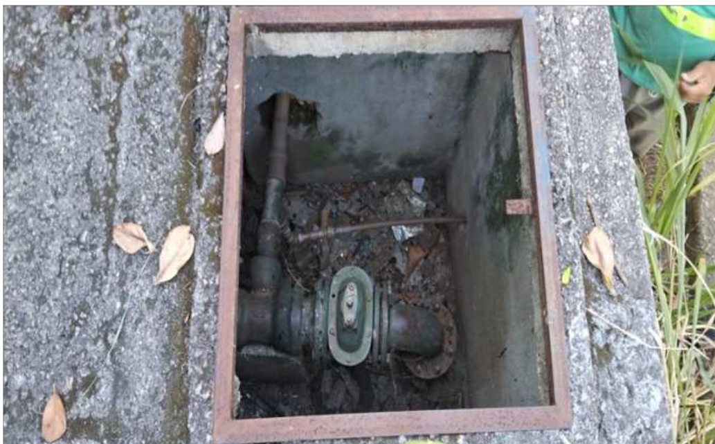
Foto 3 – Tubulação de distribuição DN 100 e 50 mm
