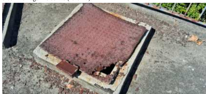
Foto 17 – Tampa solta e com ferrugem
