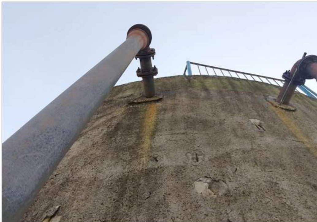
Foto 15 – Tubulação de recalque e extravasora com partes enferrujadas
