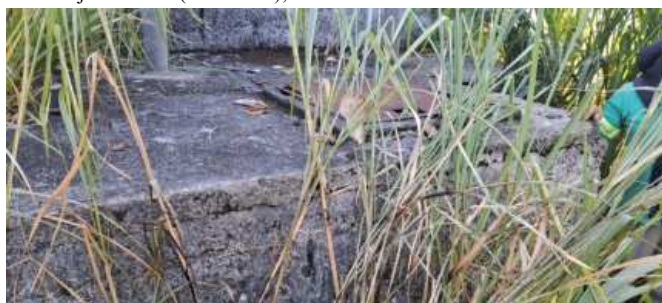
Foto 8 – Tampa da caixa do barrilete enferrujada
