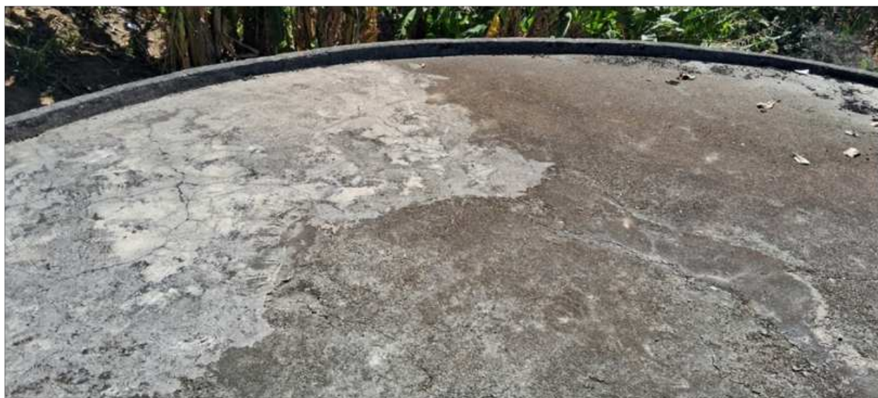
Foto 16 – Rachaduras na laje
