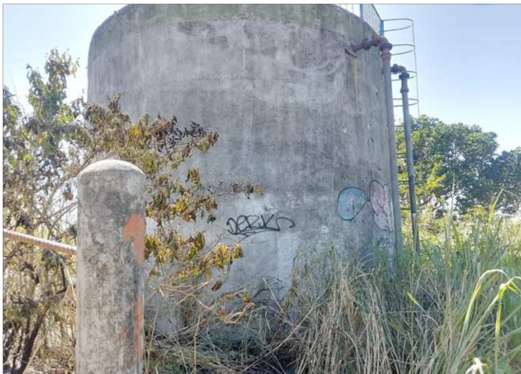
Foto 11 – Reservatório sem identificação
