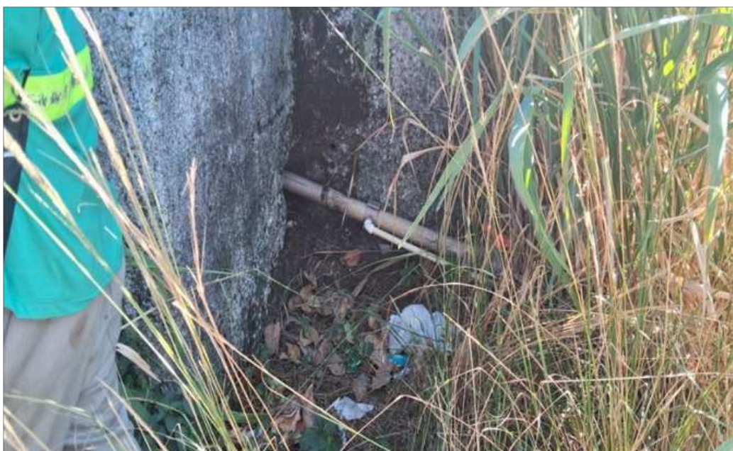
Foto 4 – Tubulação de distribuição DN 50 mm
