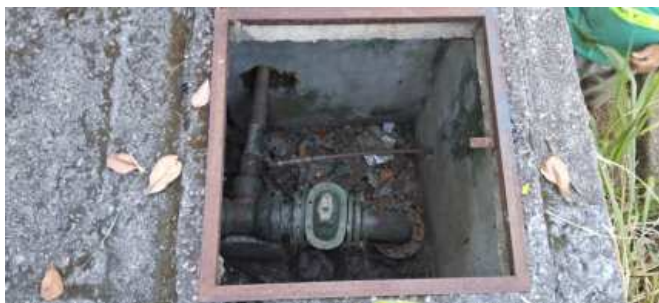
Foto 9 – Tapa da caixa do barrilete fora do caixilho
