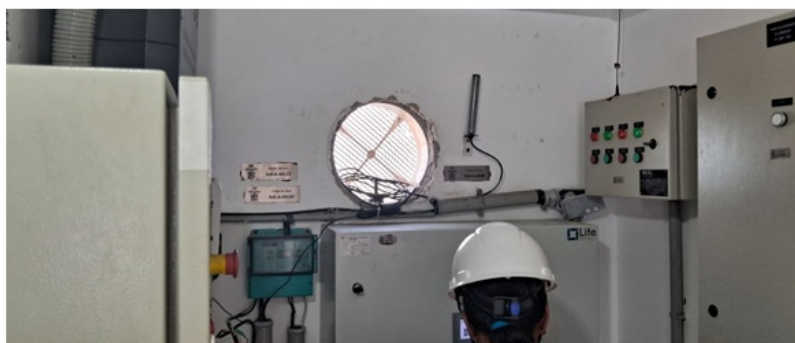
Foto 14 - Fios elétricos fora de eletrodutos
