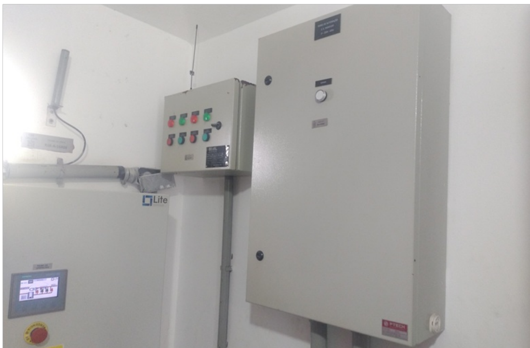
Foto 8 - Painel de controle operacional
