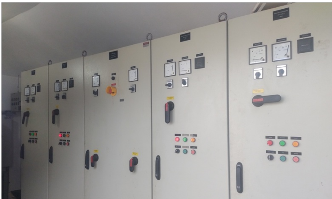
Foto 6 - Painéis de controle operacional
