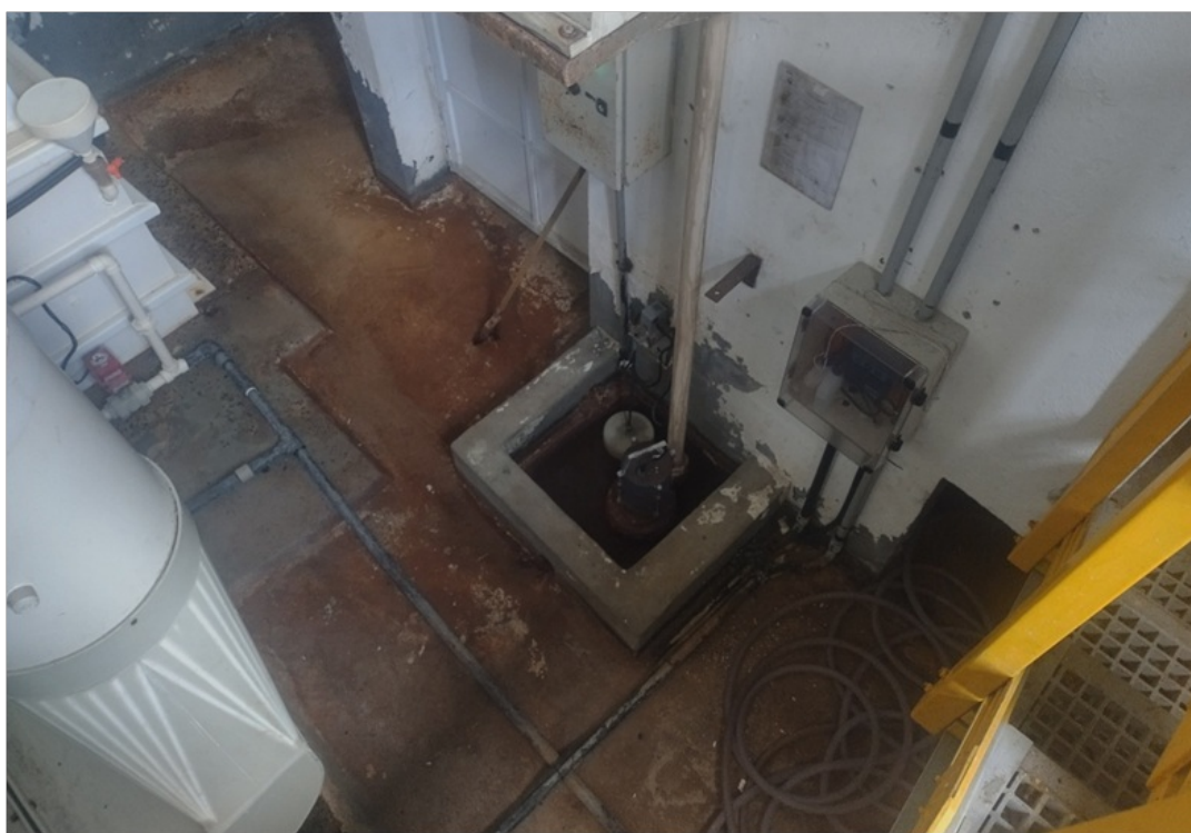
Foto 19 - Bomba para esgotamento e cabos elétricos pelo chão
