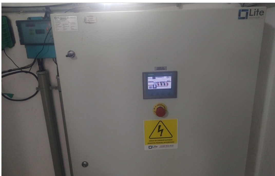
Foto 9 - Painel de controle operacional
