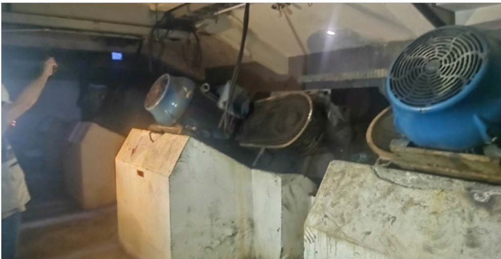
Foto 5 - Dois dos três motores que estão em funcionamento
