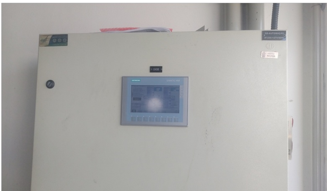
Foto 7 - Painel de controle operacional
