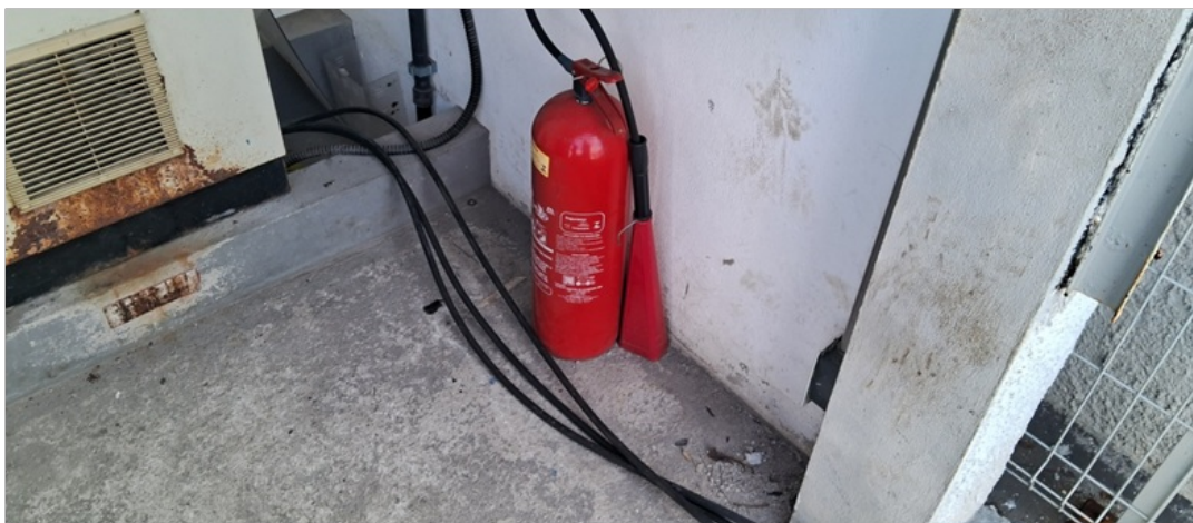
Foto 15 - Cabos elétricos no chão, extintor de incêndio indevidamente instalado e equipamento enferrujado
