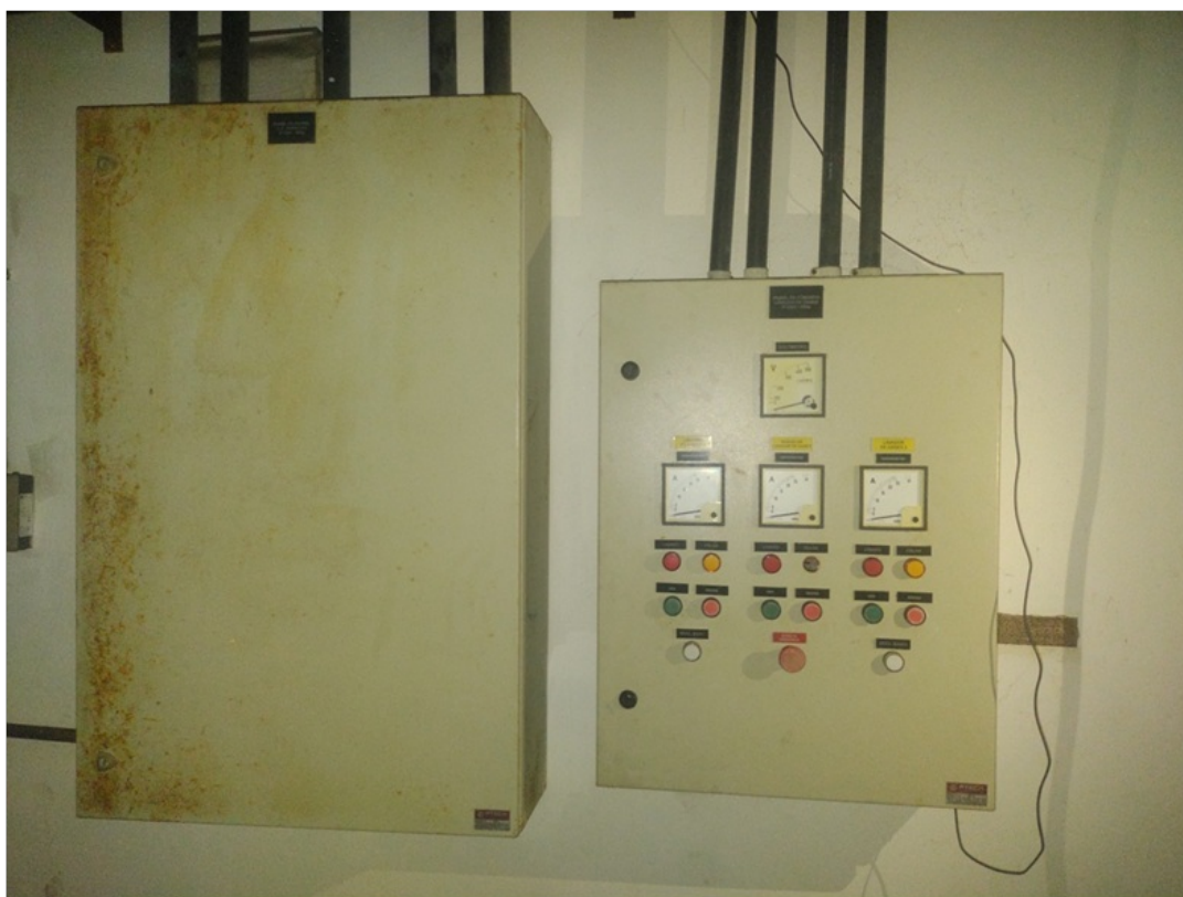
Foto 18 - Tampa do painel de controle enferrujada
