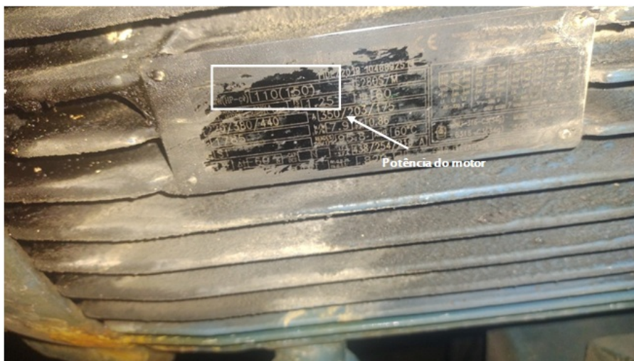
Foto 11 - Plaqueta de identificação contendo informações técnicas do motor (potência - 150cv)
