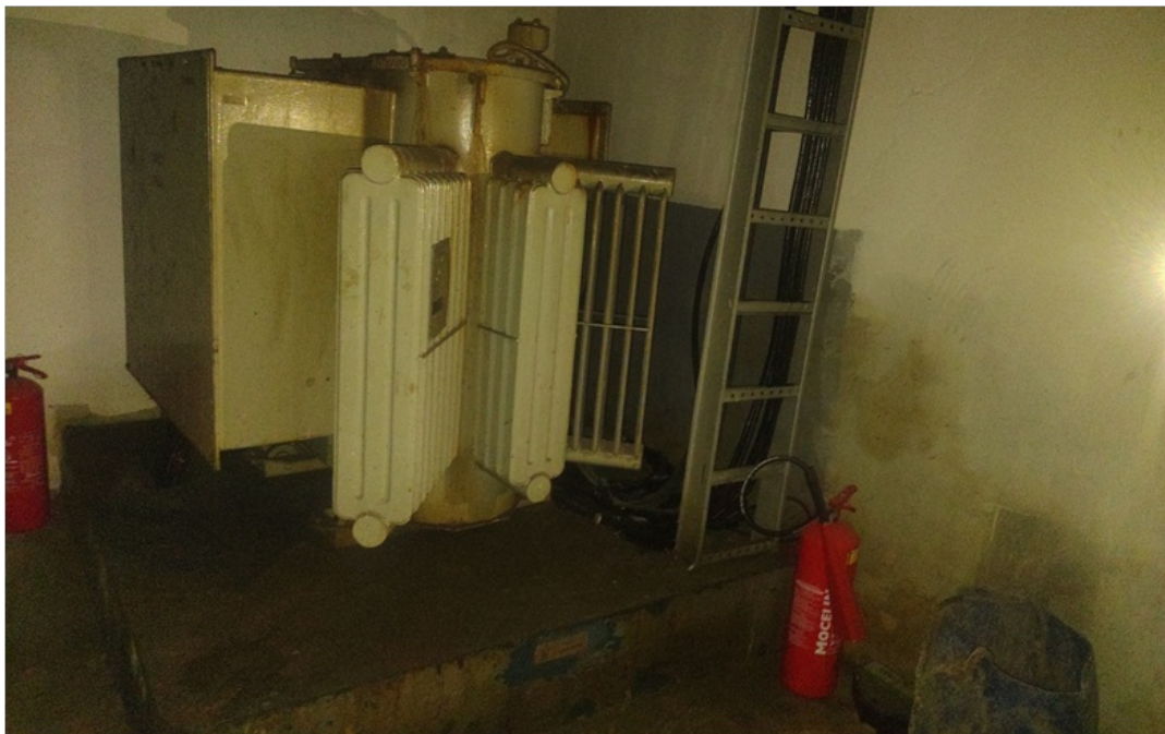
Foto 16 - Extintor de incêndio indevidamente instalado
