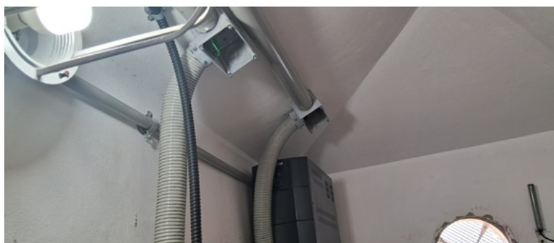
Foto 13 - Caixas de passagem de fios elétricos sem tampa
