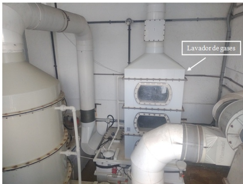
Foto 22 - Lavador de gases em funcionamento
