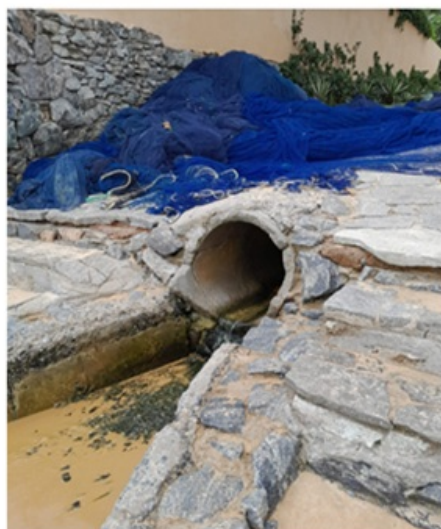
Canalização do excedente da água da lagoa que desemboca na praia do Canto.
