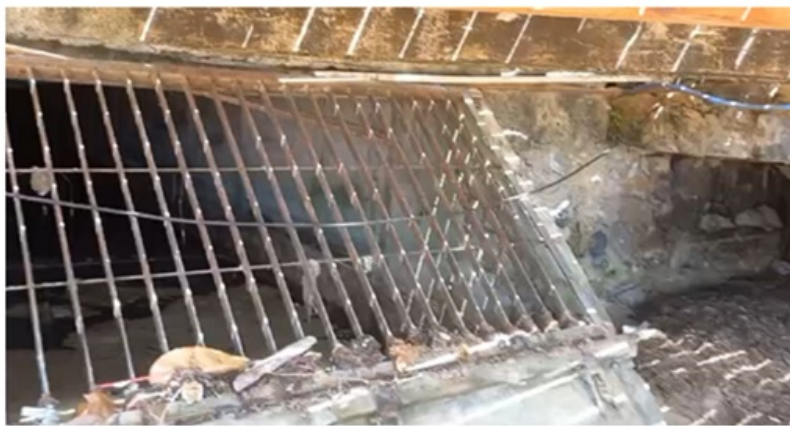
Gradeamento para materiais grosseiros do canal de drenagem sob o Pier.
