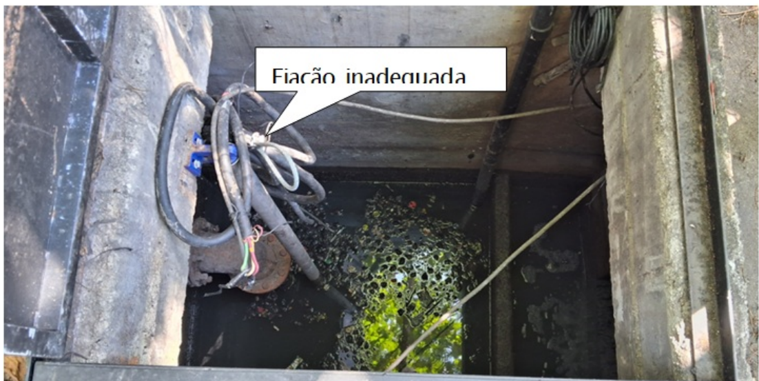
Foto 6 - Poço de sucção onde está instalado o conjunto motobomba.
