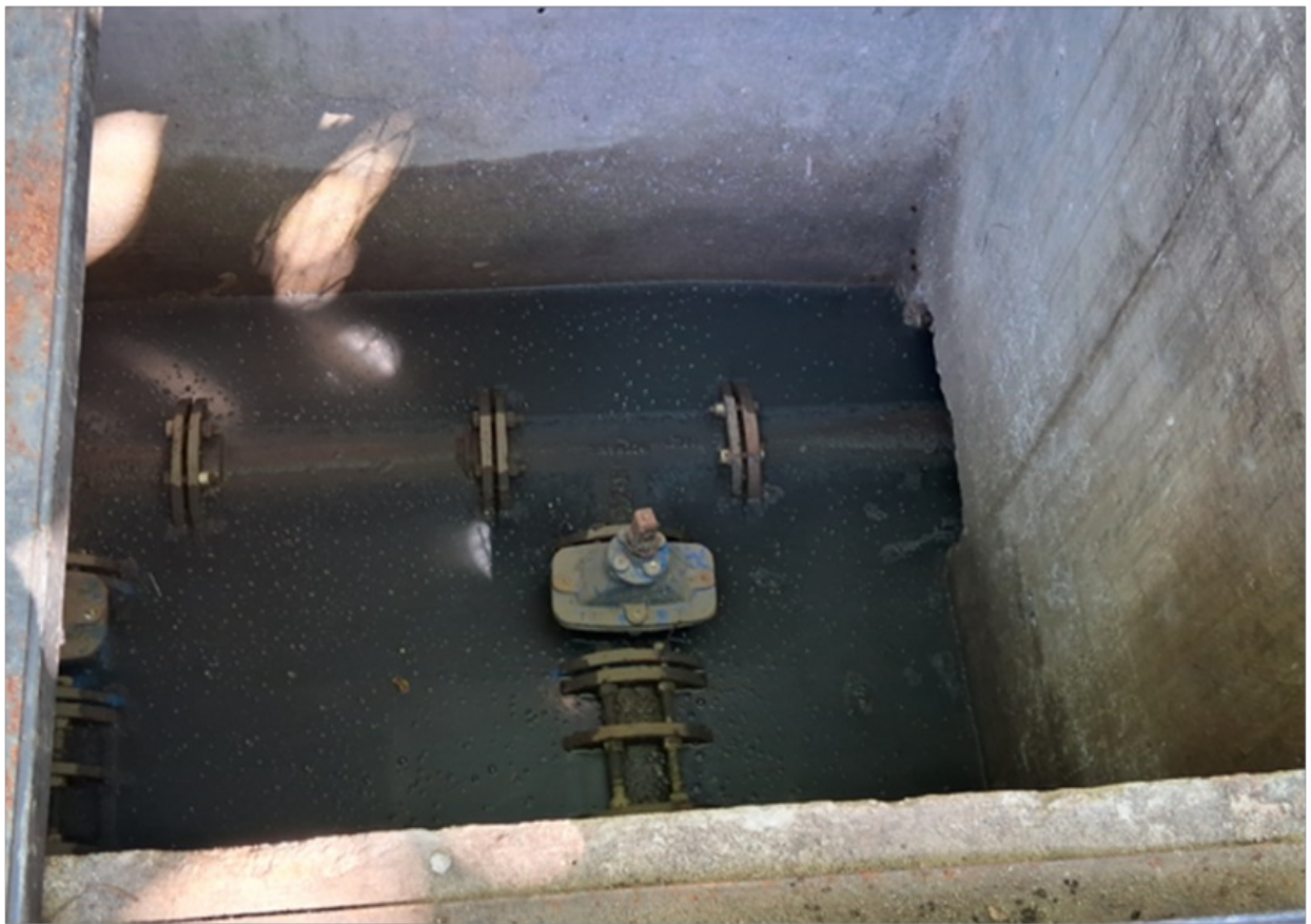
Foto7 - Barrilete onde está localizada a válvula de retenção e a ventosa
