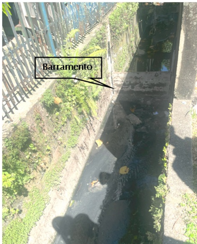
Foto 5: Coletor de chegada do esgoto
