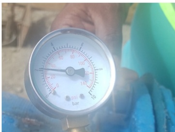
Manômetro no recalque do booster
