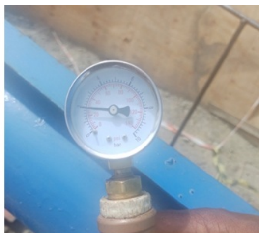
Manômetro na retaguarda do booster
