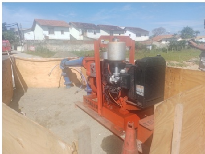
Booster provisório instalado
