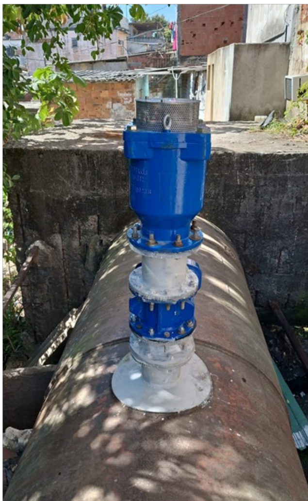
Foto 7 – Ventosa recolocada após este segundo rompimento, onde a válvula gaveta operou semi-aberta como se fosse uma descarga
