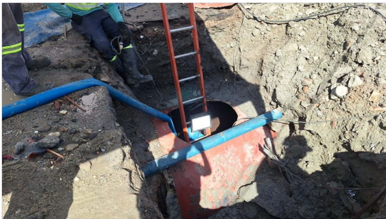
Foto 2 – Inspeção interna da tubulação após o rompimento.
