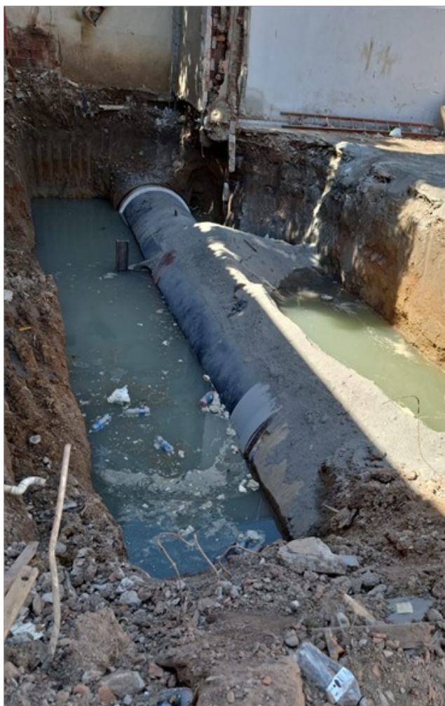
Foto 5 – Tubulação trocada no primeiro rompimento que sofreu soldagem de vazamento, segundo moradores após o segundo rompimento.
