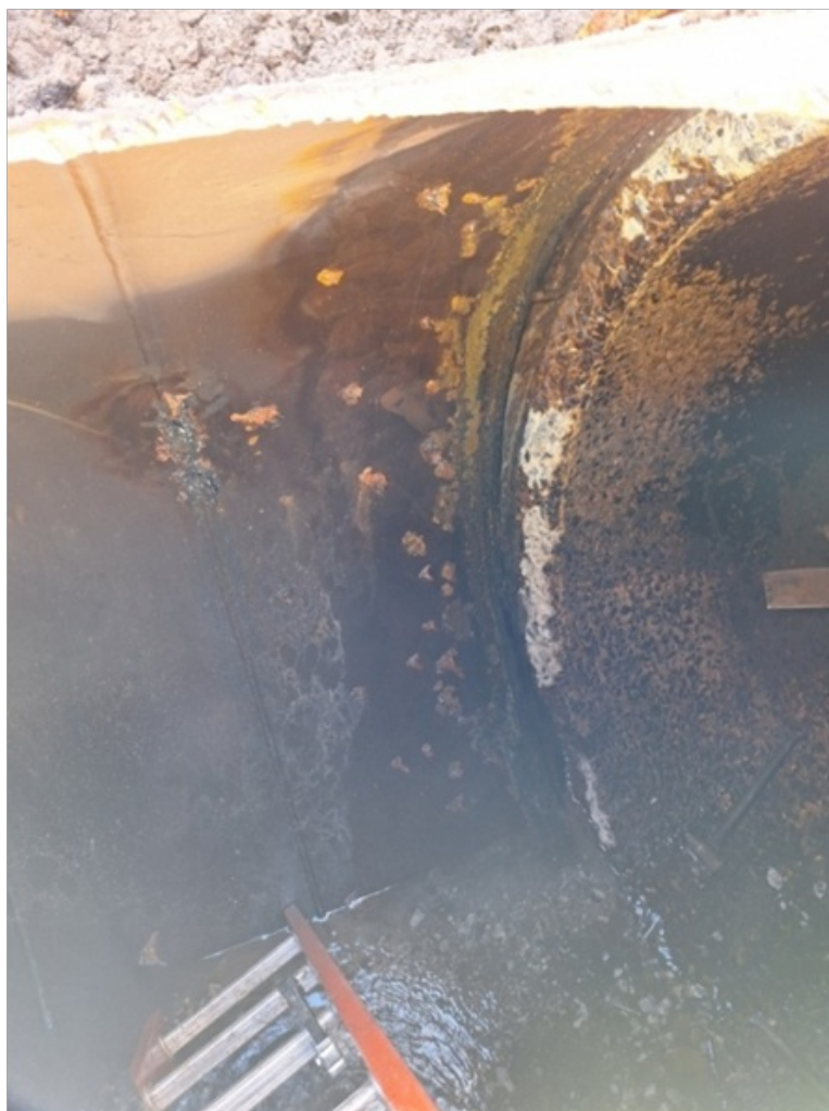
Foto 3 – Vista interna da tubulação rompida, próximo a bolsa.
