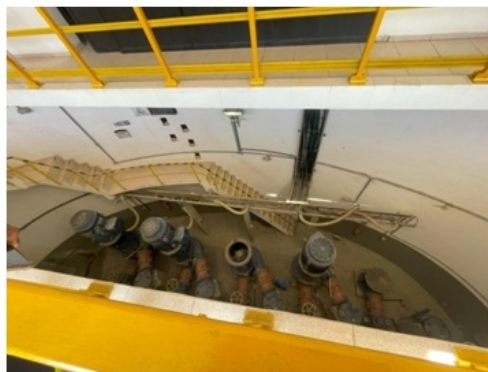
Foto 12 – Vista do piso inferior da sala de bombas. Destaca-se que há ausência de instalação de dois conjuntos moto-bombas (3 e 5).
