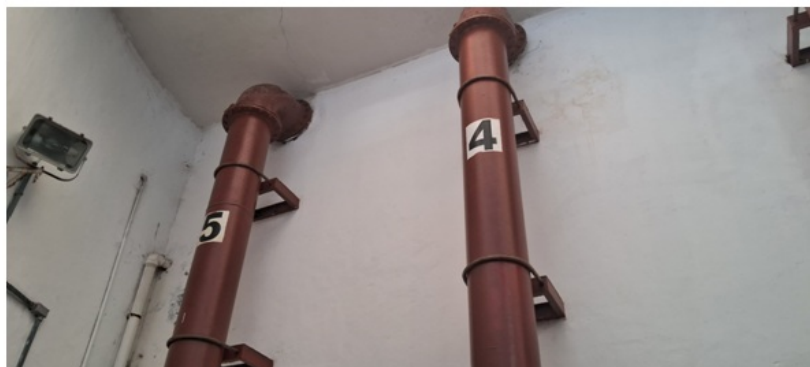
Foto 17 – Tubulação do barrilete de recalque em bom estado de conservação.
