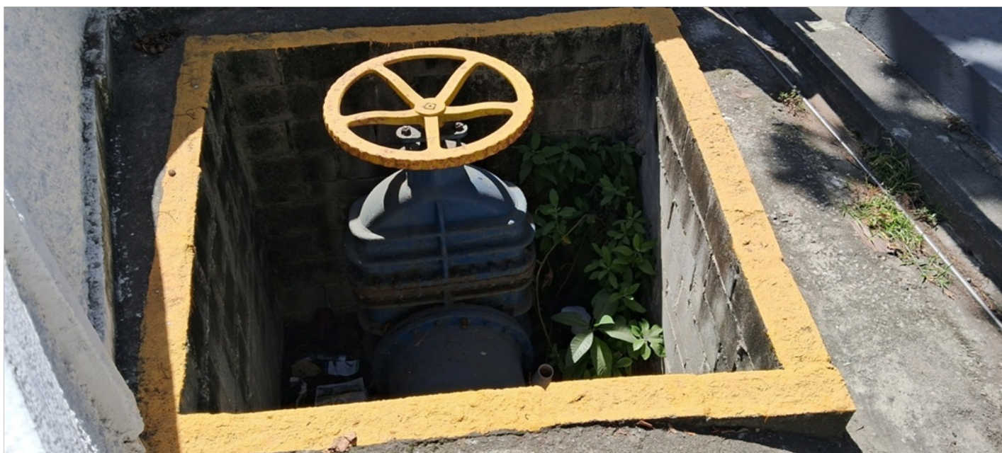
Foto 4 – Válvula de controle da entrada do efluente na estação. Nota-se o acúmulo de resíduos e crescimento de vegetação no interior da caixa de alvenaria.
