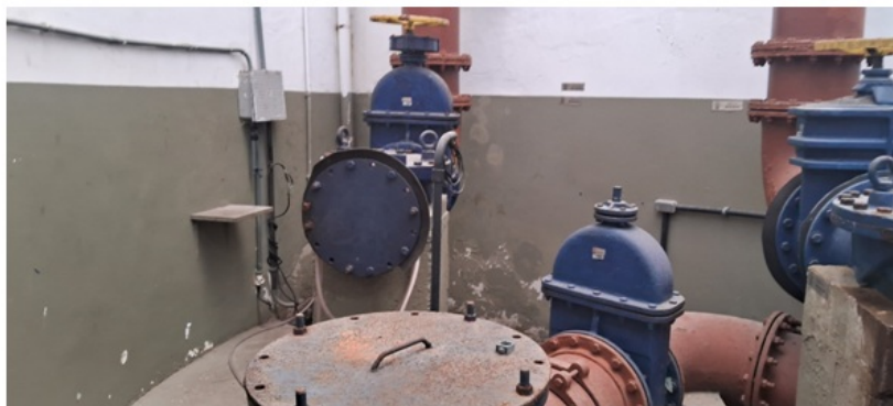
Foto 14 – Vista do CMB 5 que não está instalado.
