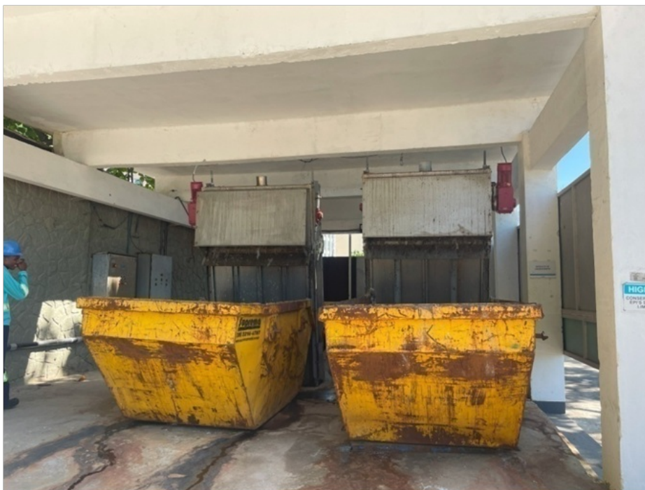
Foto 5 – Vista anterior da área do gradeamento. Nota-se escorrimento de esgoto no piso.
