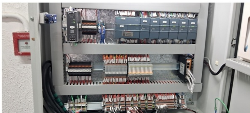
Foto 24 – Vista do interior de um dos painéis eletro-eletrônicos, que estavam em bom estado de conservação.
