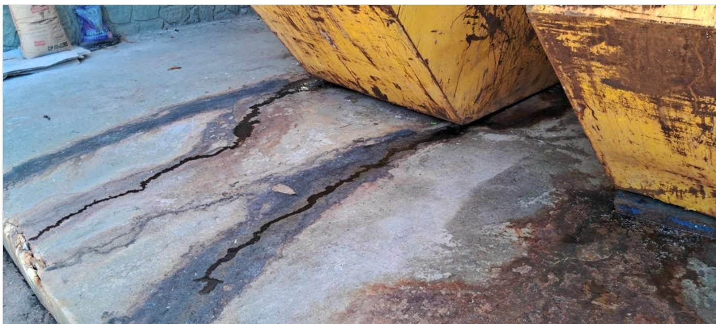
Foto 6 – Detalhe do escoamento de esgoto pelas caçambas de acúmulo de sólidos que estavam provavelmente com o fundo corroído.
