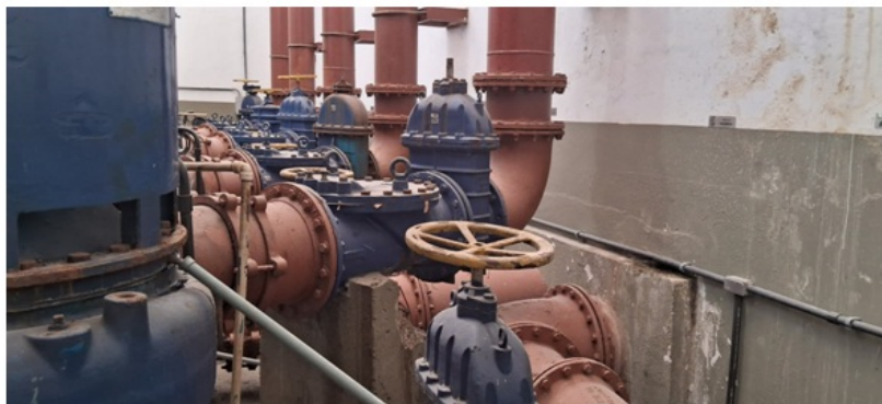
Foto 18 – Vista lateral do barrilete de recalque. Nota-se a instalação de válvulas de retenção e de bloqueio.
