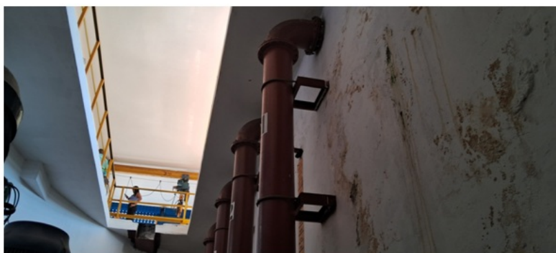
Foto 20 – Vista da parede da sala de bombas em que há sinais de infiltração e bolores que precisam ser tratados.
