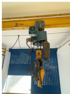
Foto 13 – Vista da ponte rolante.
