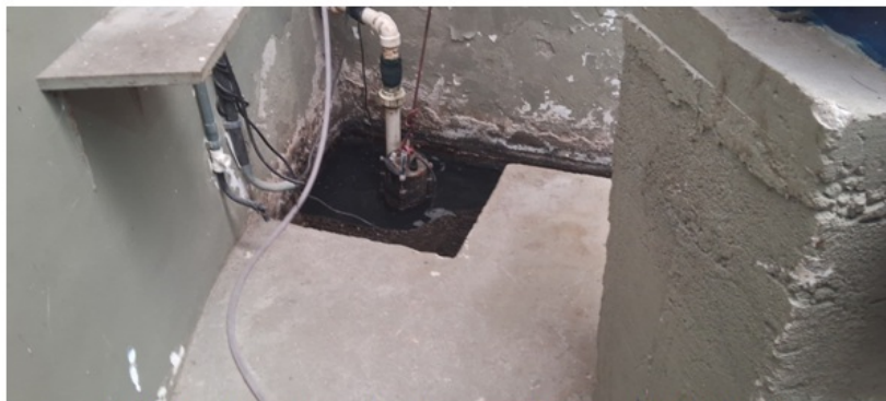
Foto 15 – Bomba para drenagem de efluente acumulado no piso da Sala de Bombas.
