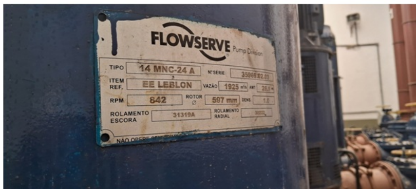
Foto 16 – Vista da etiqueta com detalhes técnicos dos conjuntos motobombas instalados. Vazão 1925 m³/h; AMT 26,9 m; RPM 842; Diâmetro do rotor 597 mm. São utilizadas bombas centrífugas de eixo vertical.
