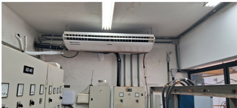
Foto 22 – Sala dos painéis elétricos que é climatizada.
