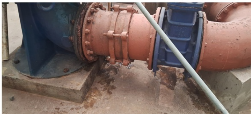
Foto 19 – Vista do barrilete com destaque para conexão em que estava ocorrendo vazamento.
