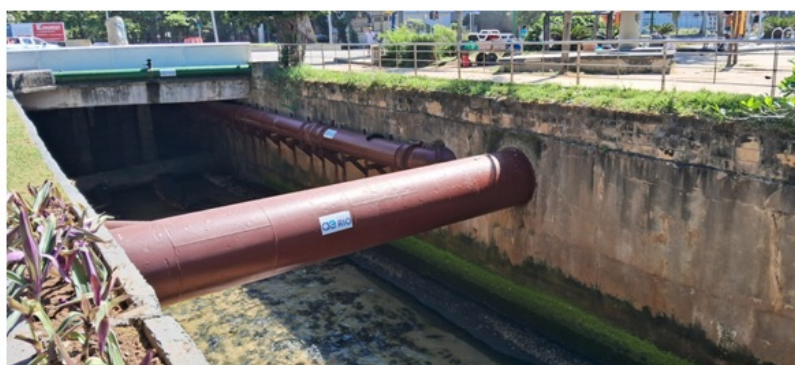
Foto 3 – Em primeiro plano a chegada na estação da linha de recalque da EEE Saturnino de Brito.
