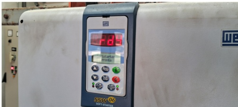
Foto 23 – Vista de um dos soft-starter instalados na estação. Também há instalados inversores de frequência.
