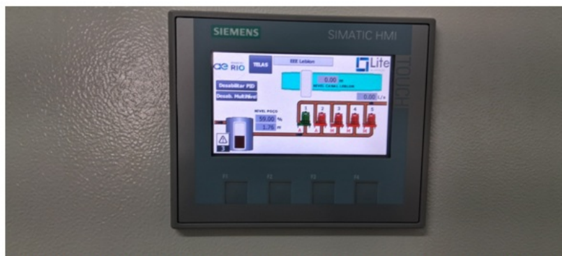
Foto 21 – Vista da tela de controle e monitoramento dos conjuntos motobombas. No momento da vistoria umas dos conjuntos estava ativo e o poço com nível de 1,76m.
