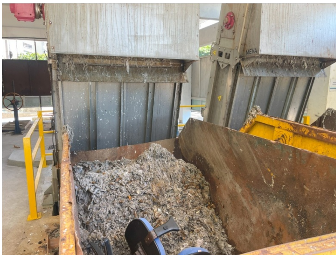
Foto 7 – Detalhe do sistema automático de gradeamento, que estava ativo no momento da vistoria, e da caçamba.
