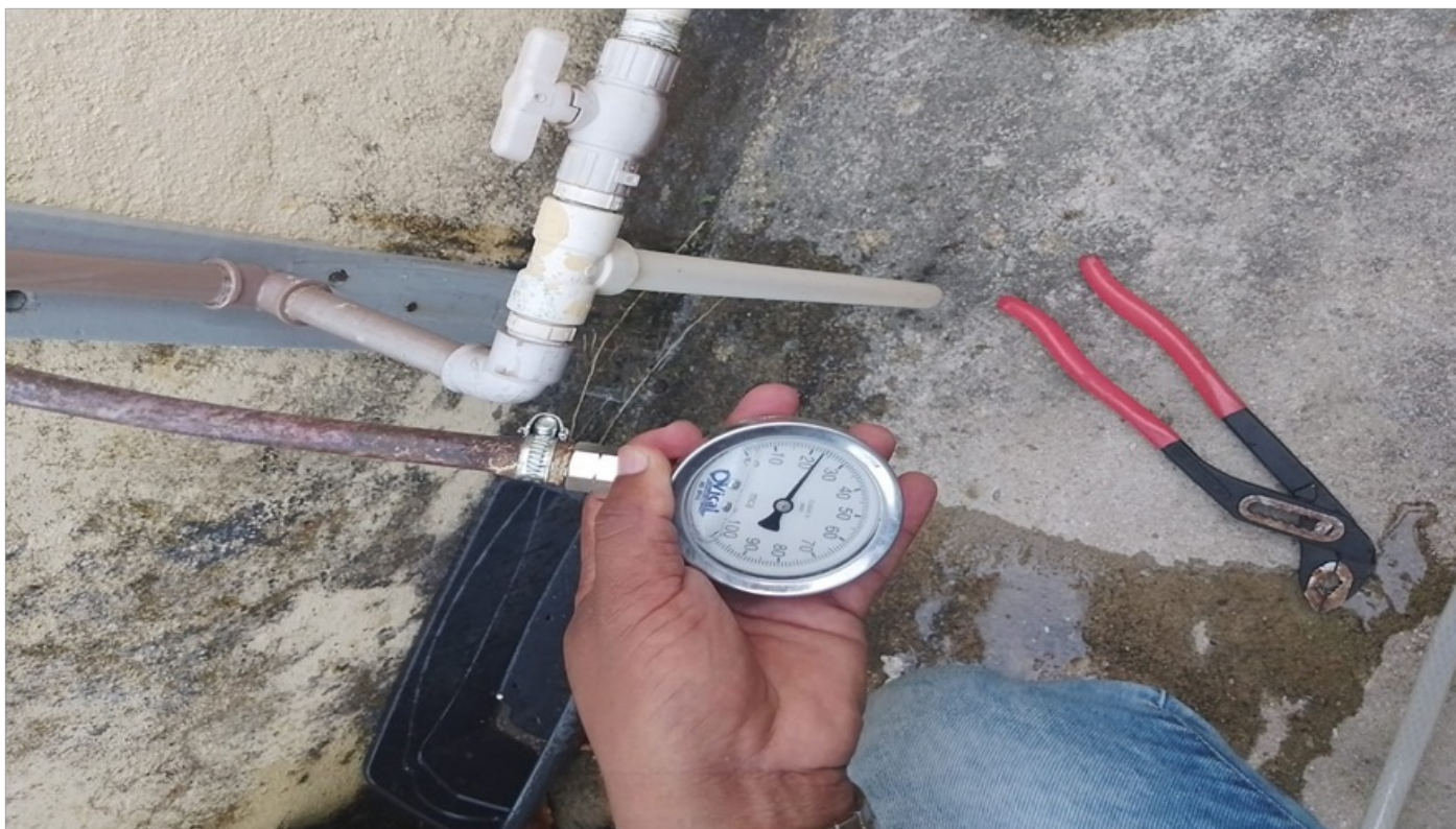
Foto 2 – Pressão manométrica medida no lote 30, quadra 5, casa1, da rua Itacuruça (23 MCA)
