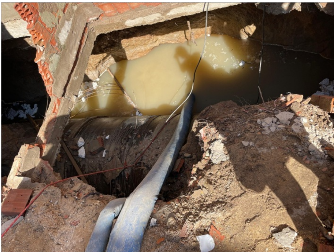
Foto 4 - Localização da adutora DN 1750 mm sobre construções irregulares.
