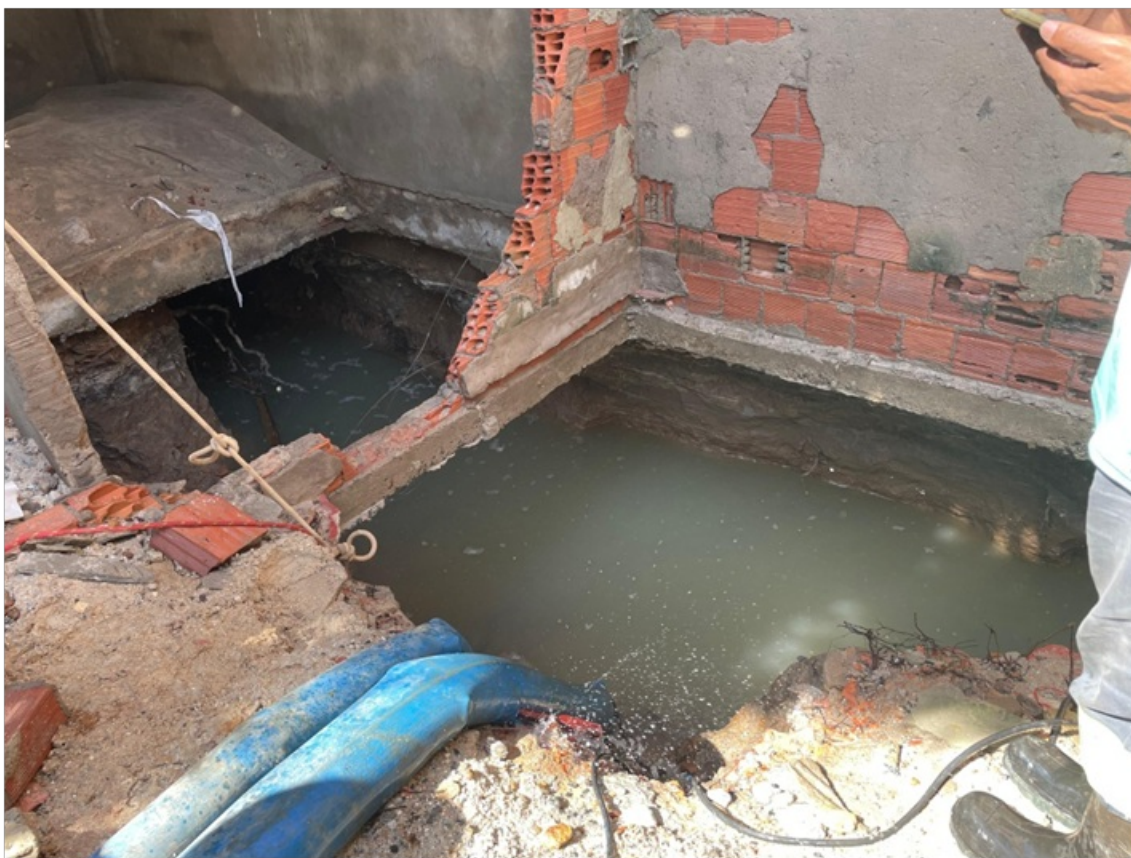
Foto 1 - Localização do rompimento da adutora DN 1750.
