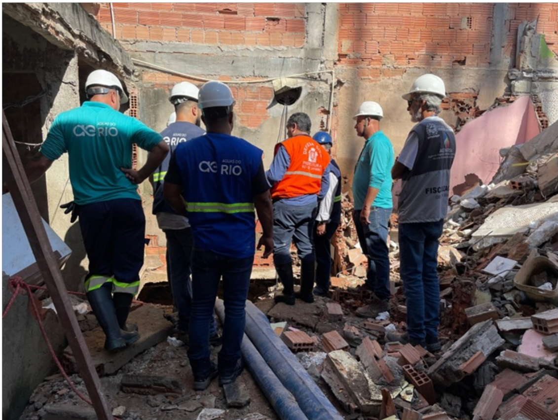
Foto 3 - Representantes da Defesa Civil, Concessionária Águas do Rio e AGENERSA analisando o rompimento.
