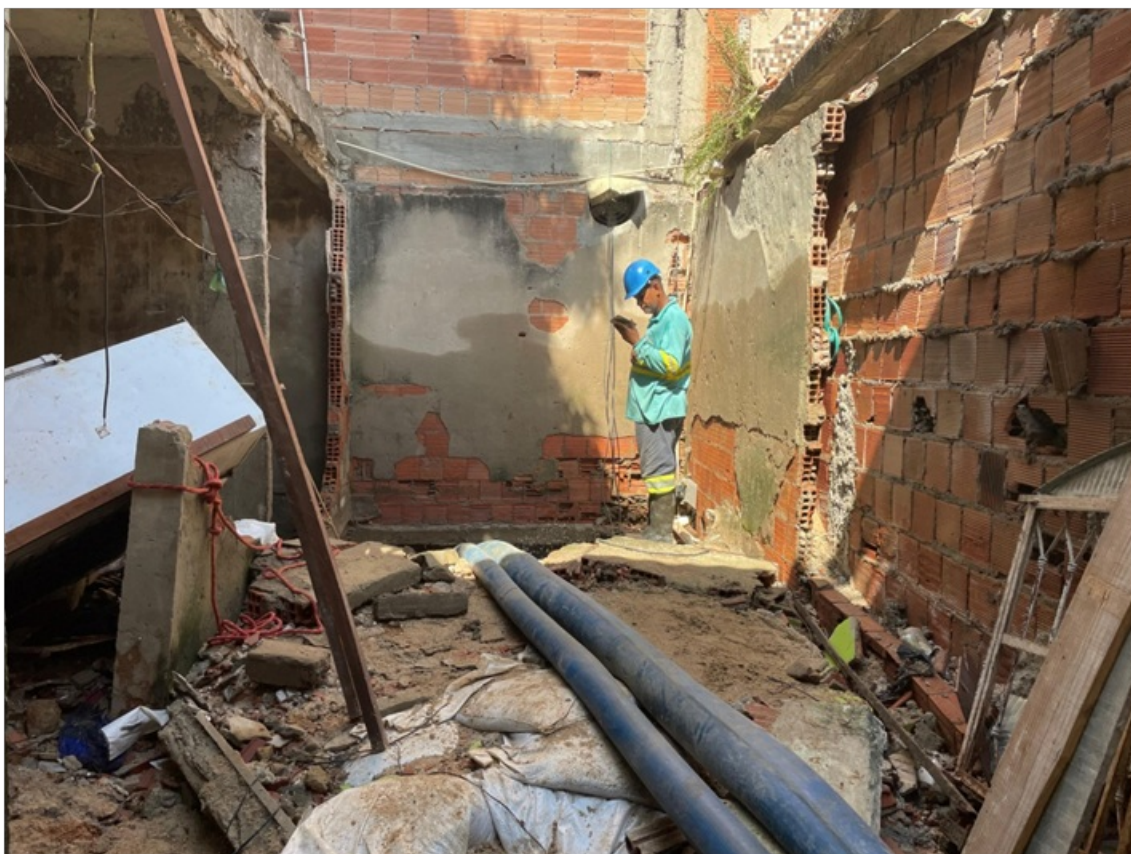
Foto 2 - Área non aedificandi com várias construções irregulares sobre a adutora.
