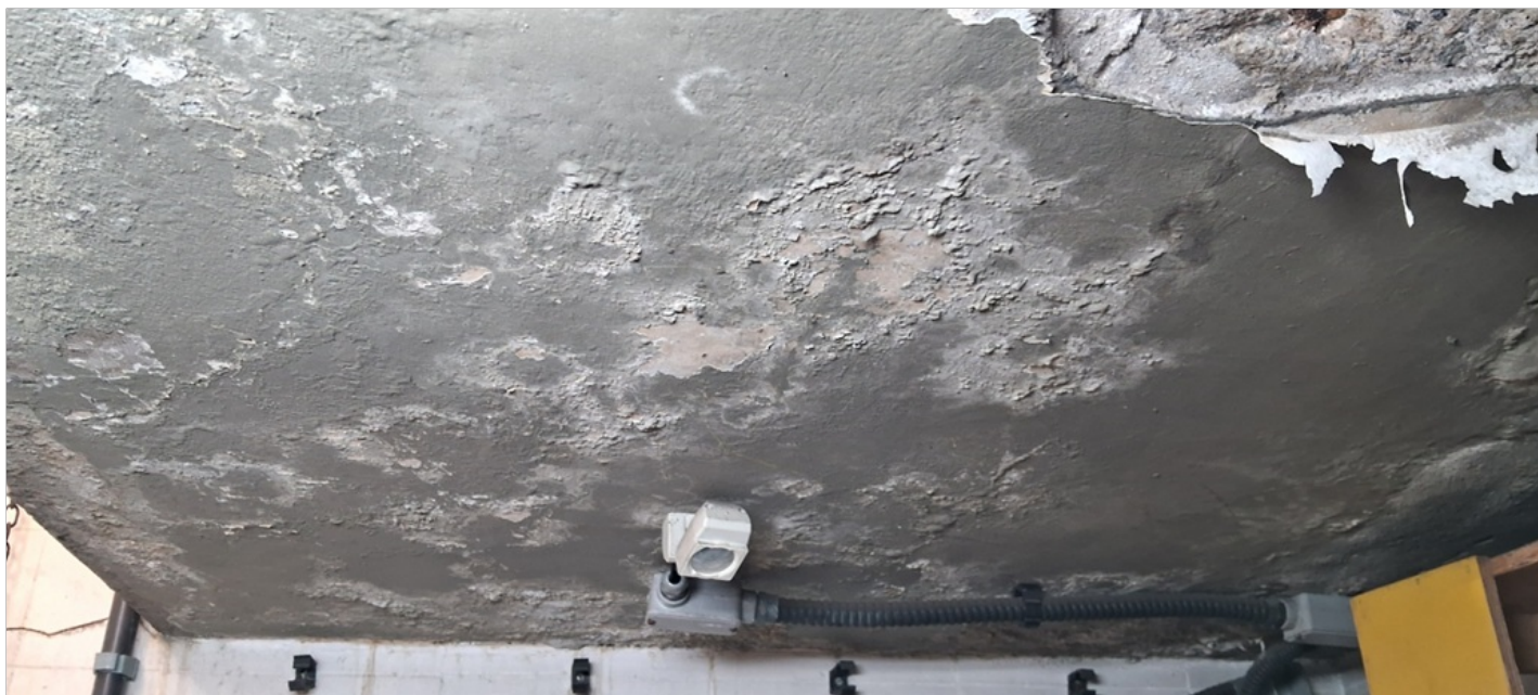
Foto 11 – Sinais de infiltração na laje.
