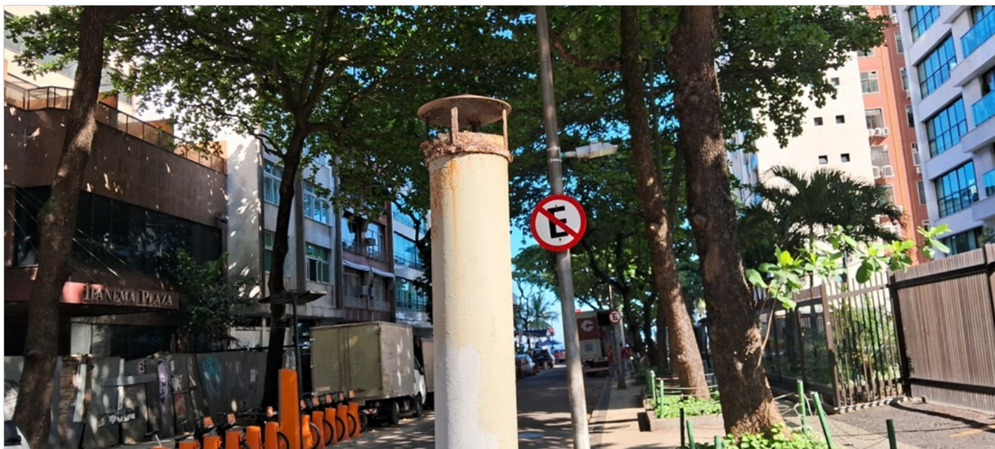
Foto 6 – Tubulação de ventilação.
