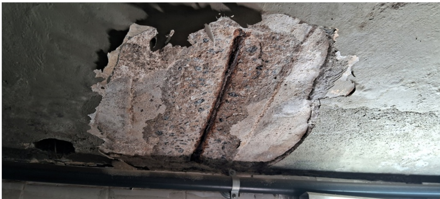
Foto 8- Armadura da laje exposta e corroída.
