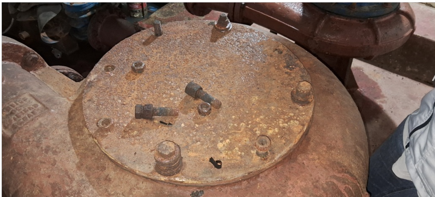
Foto 2 – conjunto motobomba inoperante.
