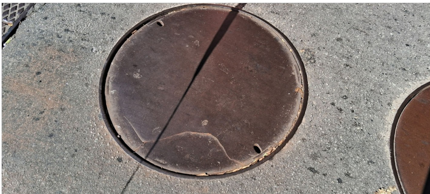
Foto 5 – Tampa de umas das visitas da sala de bombas com rachaduras.
