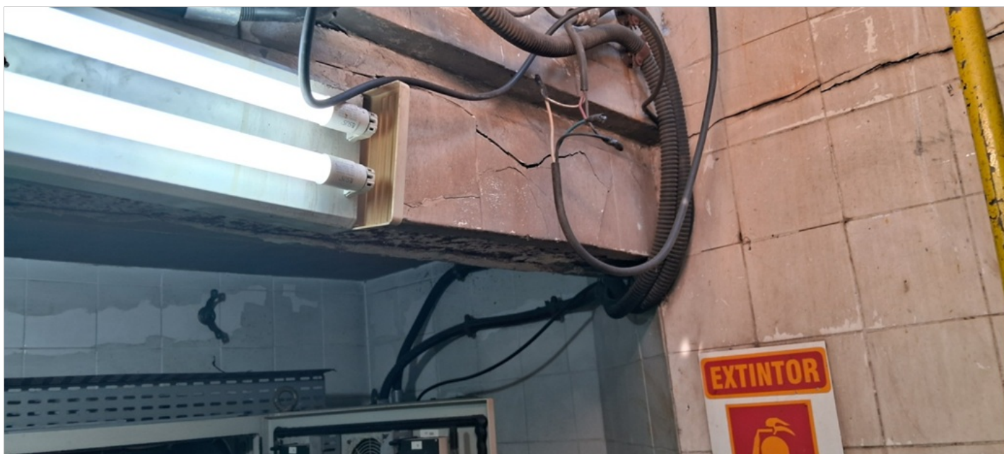
Foto 9 – Rachadura na lateral de uma viga e no revestimento cerâmico da parede.
