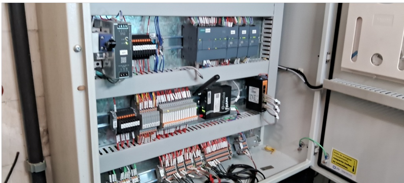
Foto 7 – Interior de um dos quadros elétricos.
