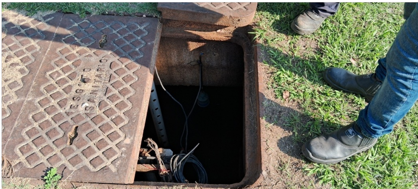
Foto 2 – Vista do interior do tanque de sucção.
