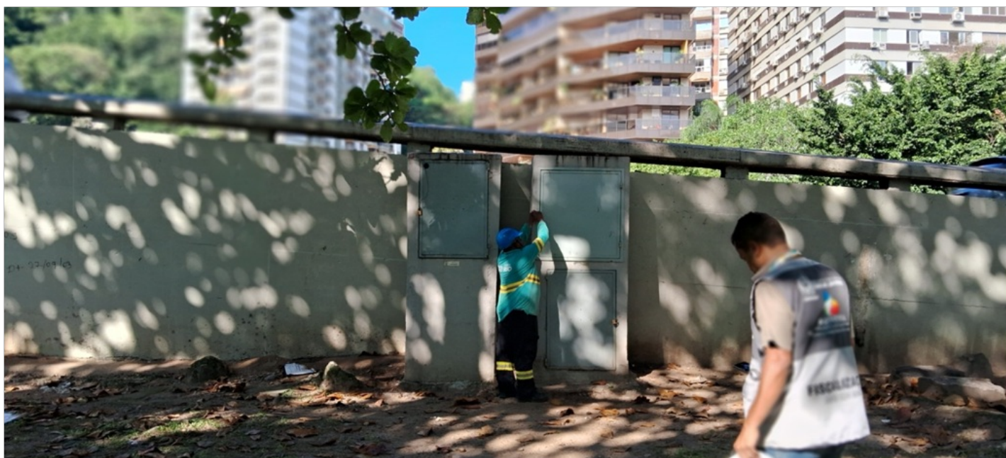
Foto 5 – Abrigos dos painéis elétricos sem identificação do risco de choque elétrico.
