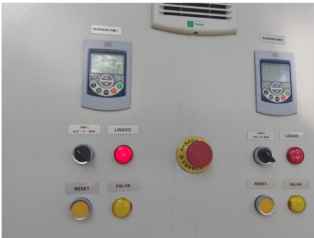
Foto 6 – Paineleltrico com inversor de frequncia indicando uma das bombas ligadas.
