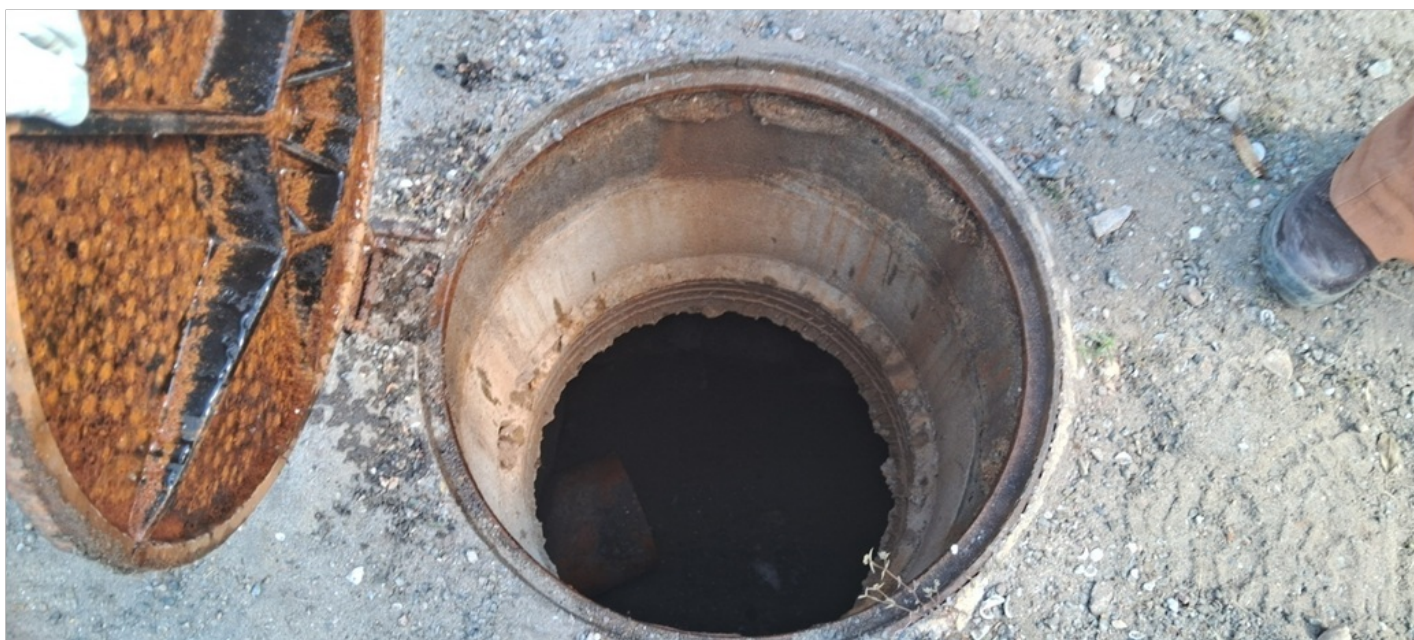
Foto 10 – Poço de visita da rede de drenagem sem fluxo de água.
