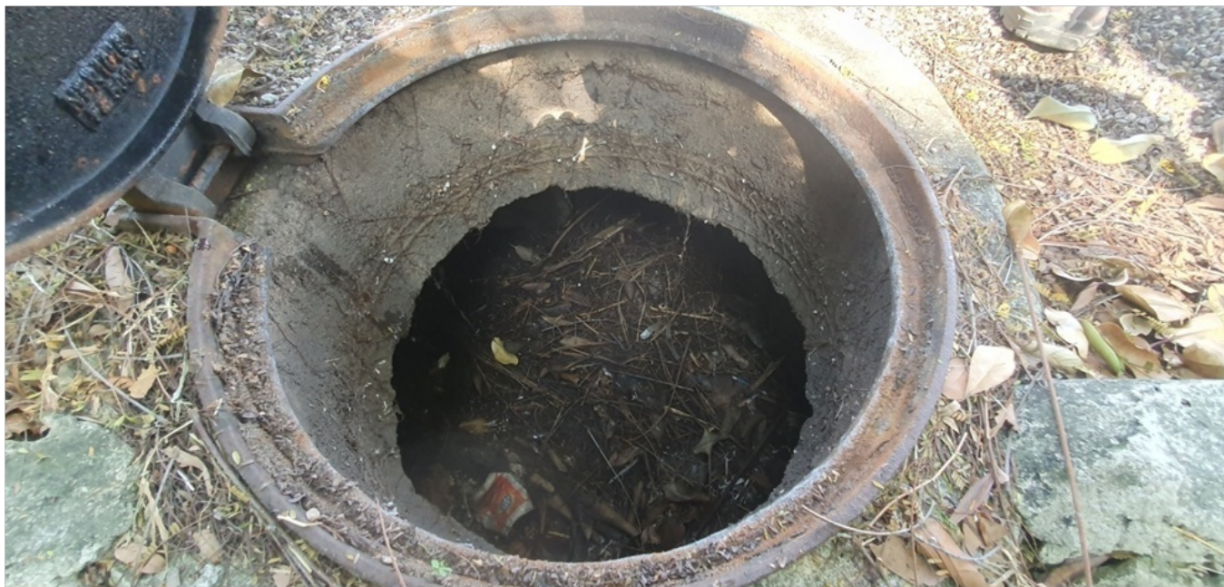
Foto 9 – Poço de visita da rede de drenagem sem fluxo de água.
