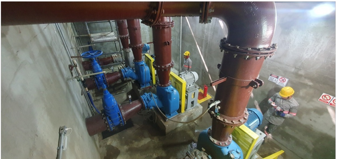
Foto 3 – Sala de bombas.
