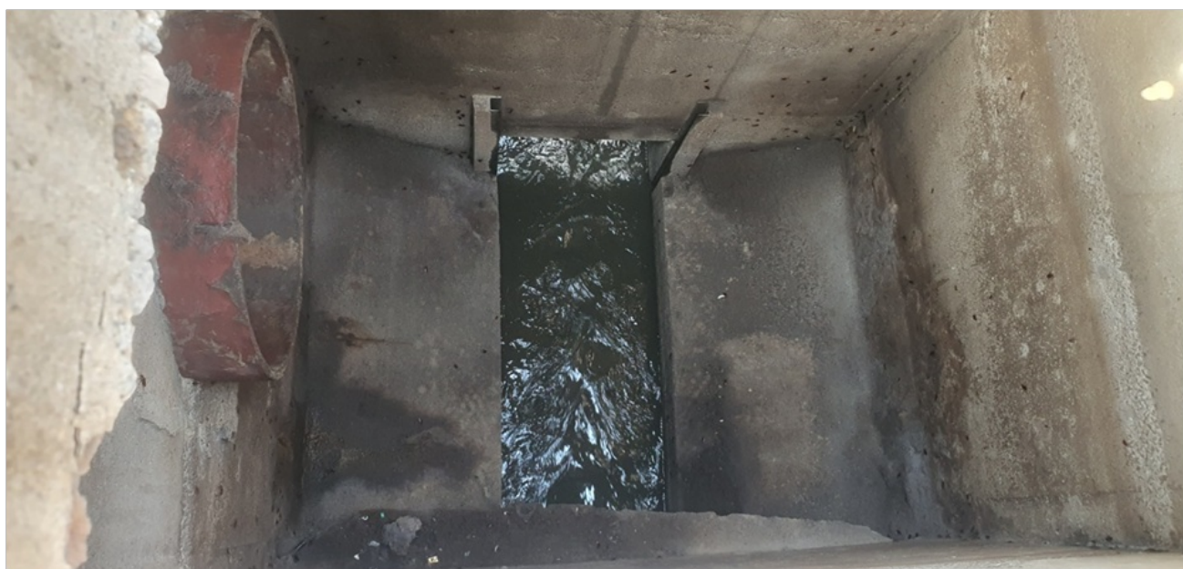
Foto 2 – Caixa receptora operando com nível baixo. Destaca-se extravasor à esquerda.
