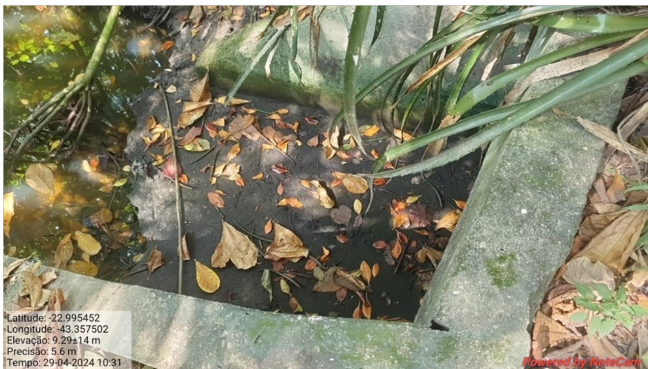
Foto 11 – Uma das saídas de galeria de drenagem em que não havia fluxo de água.
