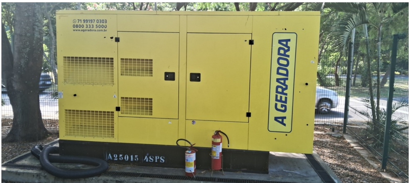
Foto 5 – Gerado de energia elétrica da estaca.
