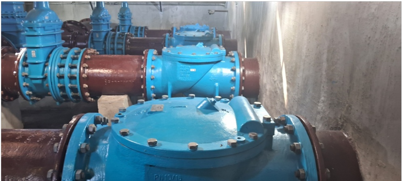
Foto 4 – Barrilete de recalque, destaca-se as válvulas de retenção.
