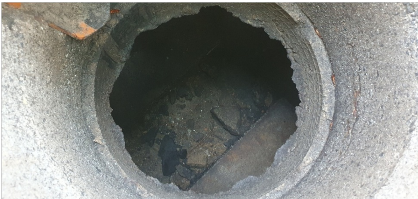
Foto 8 – Poço de visita da rede de drenagem sem fluxo de água.
