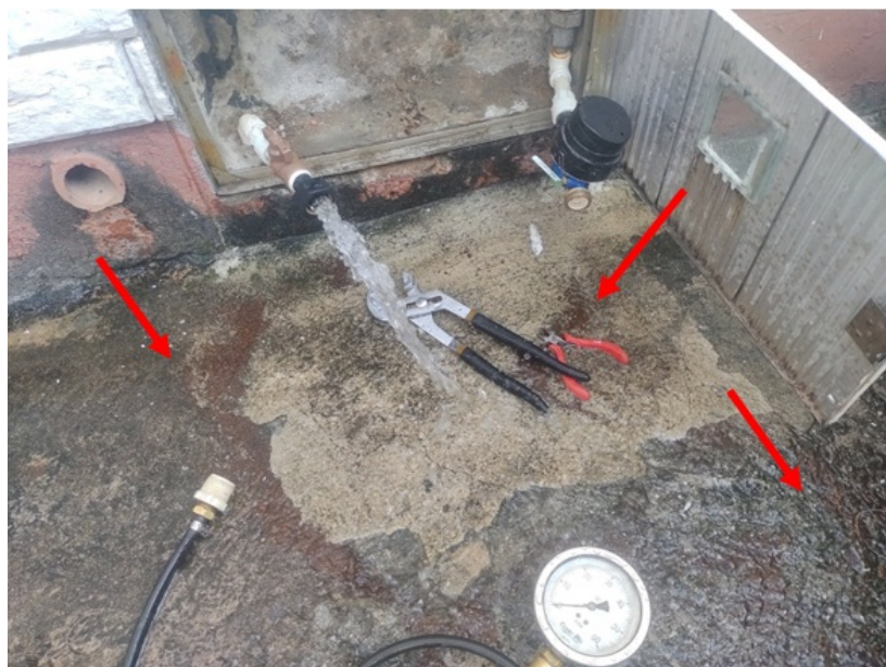
Foto 7 – Tubo de entrada Casa 11 Rua Pereira Soares, em evidência as impurezas
