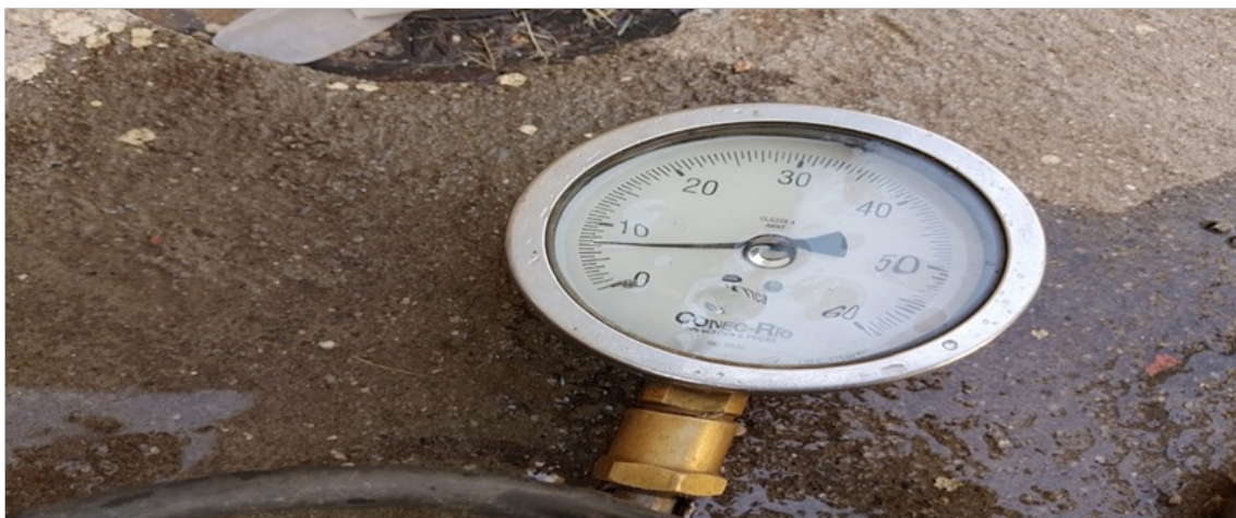
Foto 4 - Pressão de 7 mca aferida na casa nº 8 da Vila.
