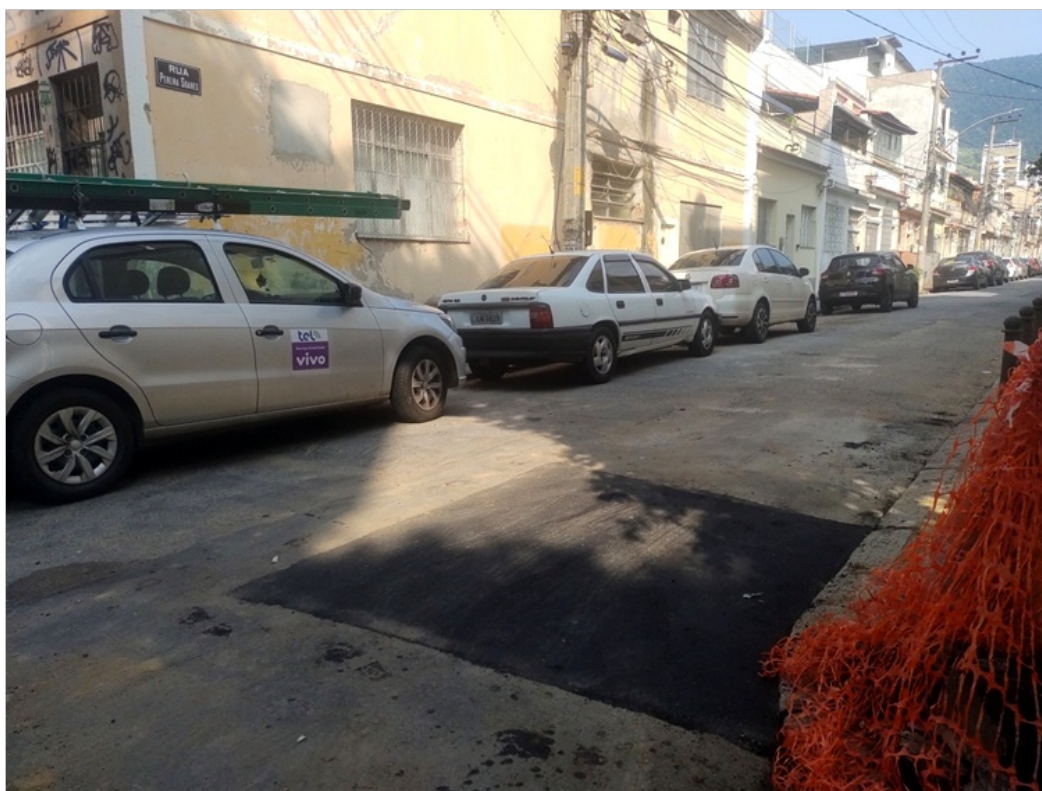
Foto 8 - Marcas de reparos na esquina da rua Pereira Soares com rua Senador Muniz Freire
