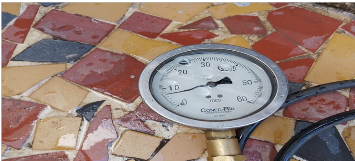
Foto 2 - Pressão de 7 mca aferida na casa nº 12 da Vila.
