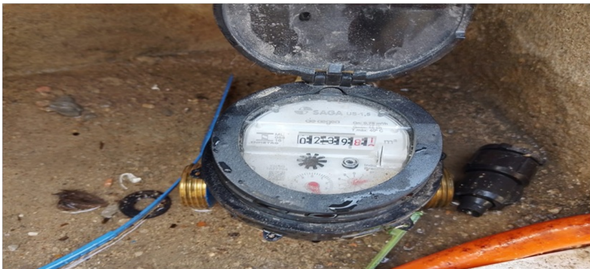
Foto 3 - Leitura de 239 metros cúbicos no Hidrômetro da casa nº 12 da vila.
