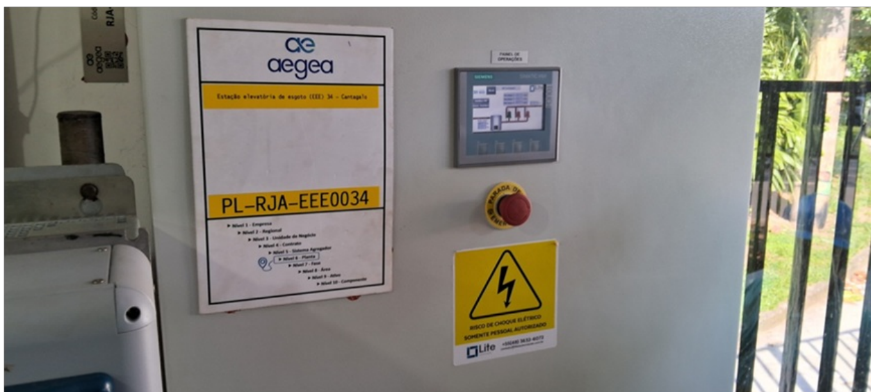
Foto 4 – Painelel eletrônico de monitoramento do nível do poço e do funcionamento das bombas
