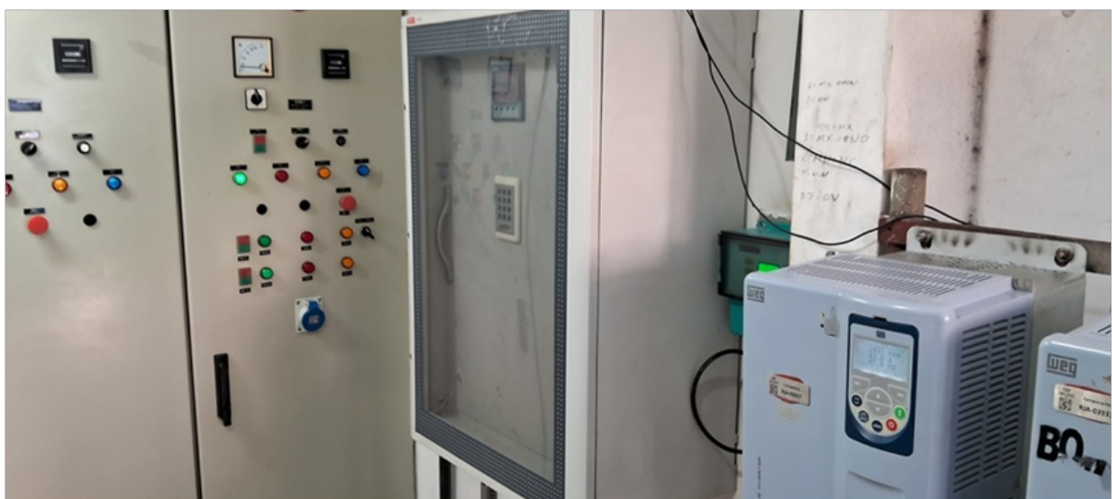
Foto 3 – Painéis de controle e inversores de frequência da estação
