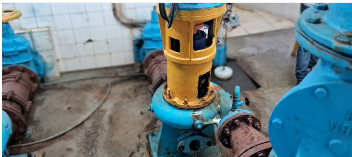
Foto 11 – Conjunto moto-bomba com vazamento
