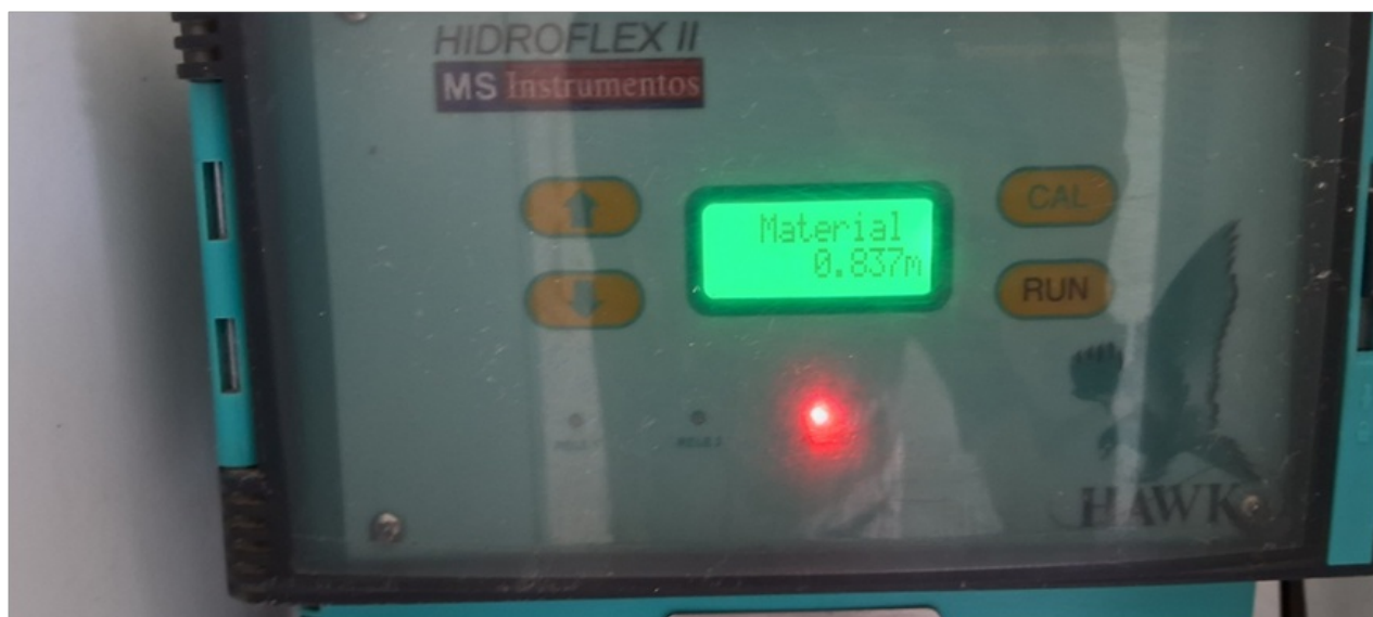
Foto 6 – Painelel de monitoramento do nível de esgoto no poço de sucção
