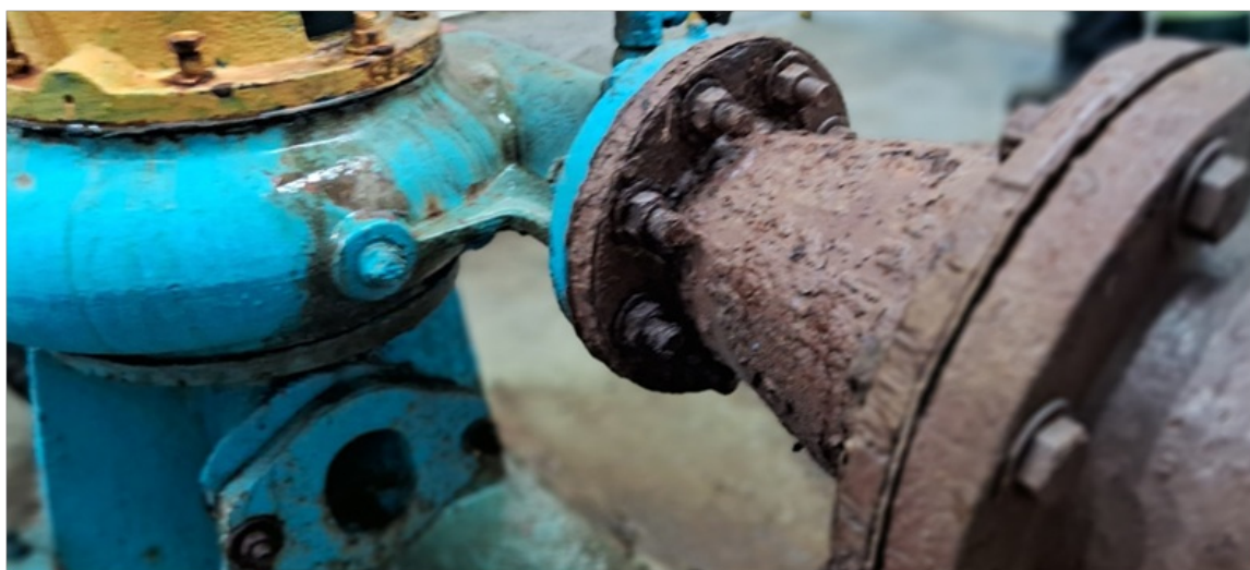
Foto 12 – Marcas de corrosão na união da tubulação de recalque
