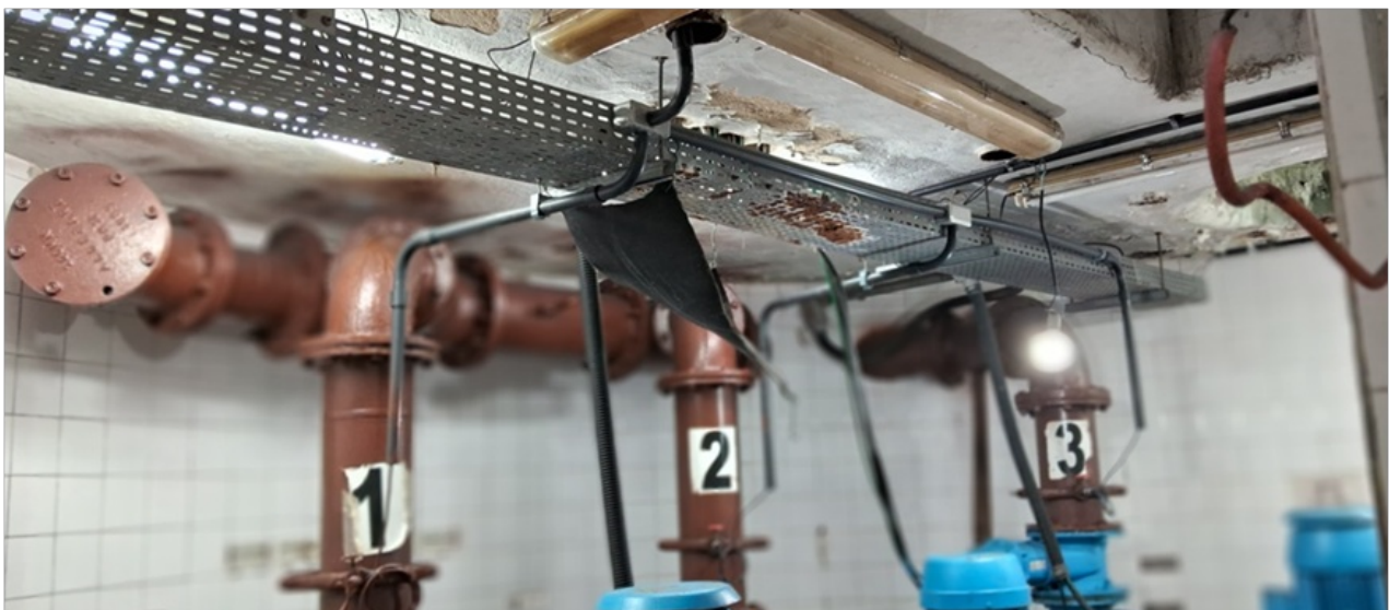
Foto 9 – Vista do poço dos conjuntos moto-bombas.
