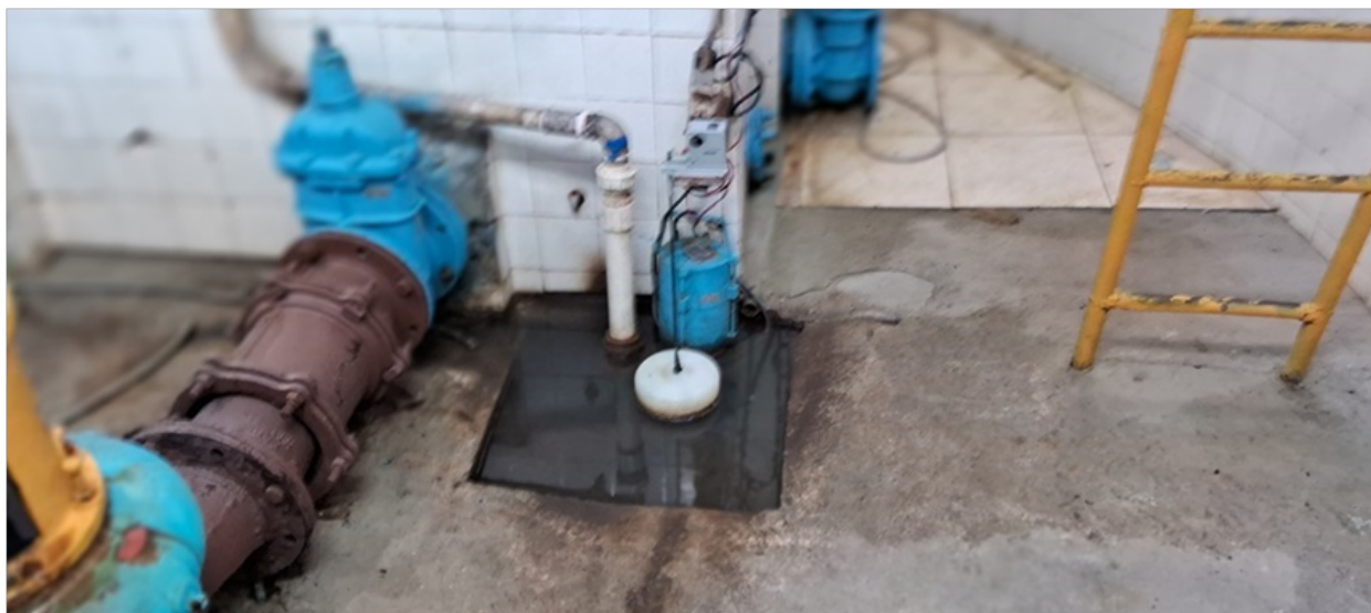
Foto 10 – Bomba dreno utilizada para retirar vazamentos e infiltrações no poço das bombas
