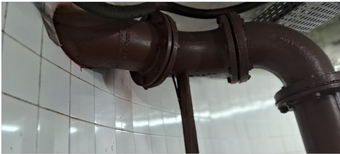
Foto 13 – Tubulação de recalque apoiada por tábua de madeira
