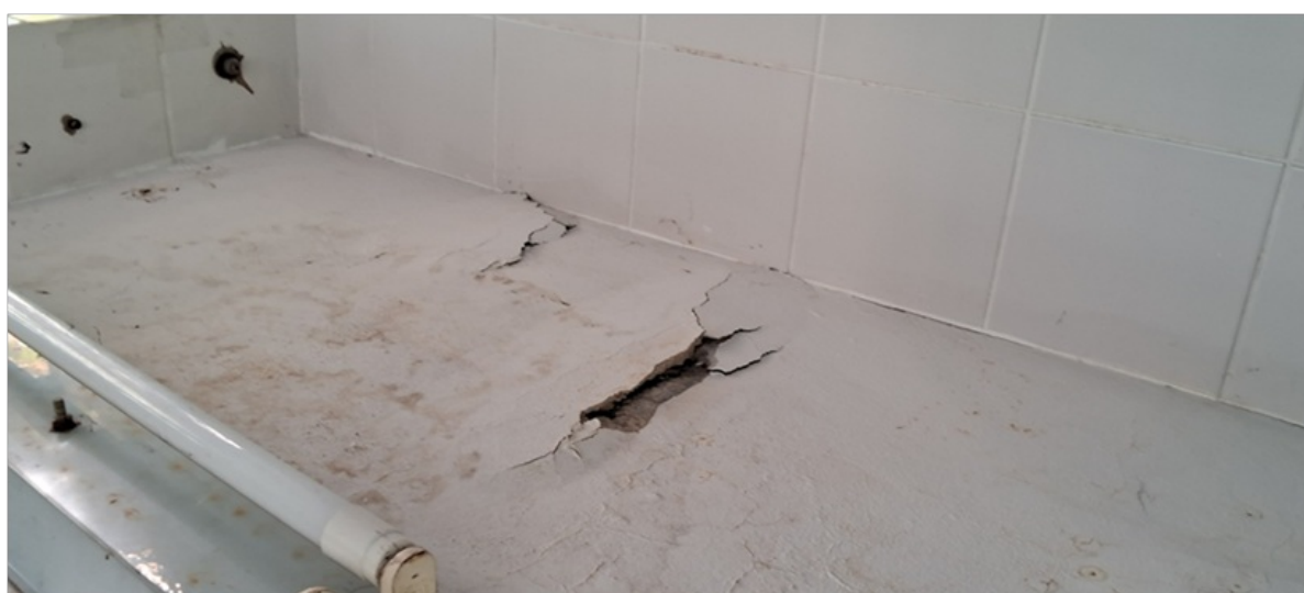
Foto 5 – Marcas de infiltração no teto e deslocamento da laje do teto
