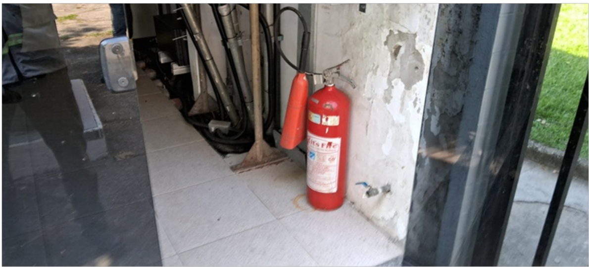
Foto 8 – Extintor de incêndio na entrada da sala dos painéis elétricos
