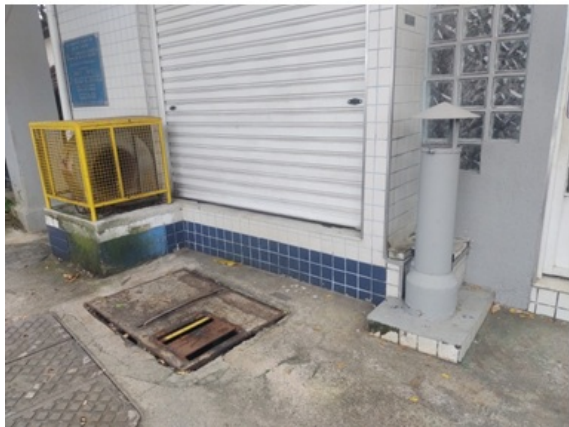
Foto 3 – Exaustor abrigo das bombas
