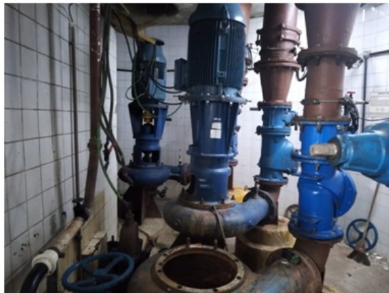
Foto 4 – Conjunto motores bombas
