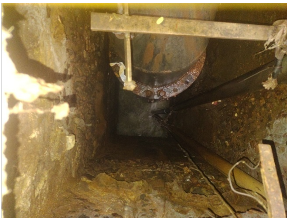
Foto 11 – Poço de sucção
