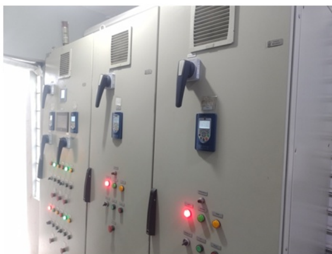
Foto 7 – Quadros elétricos de comando
