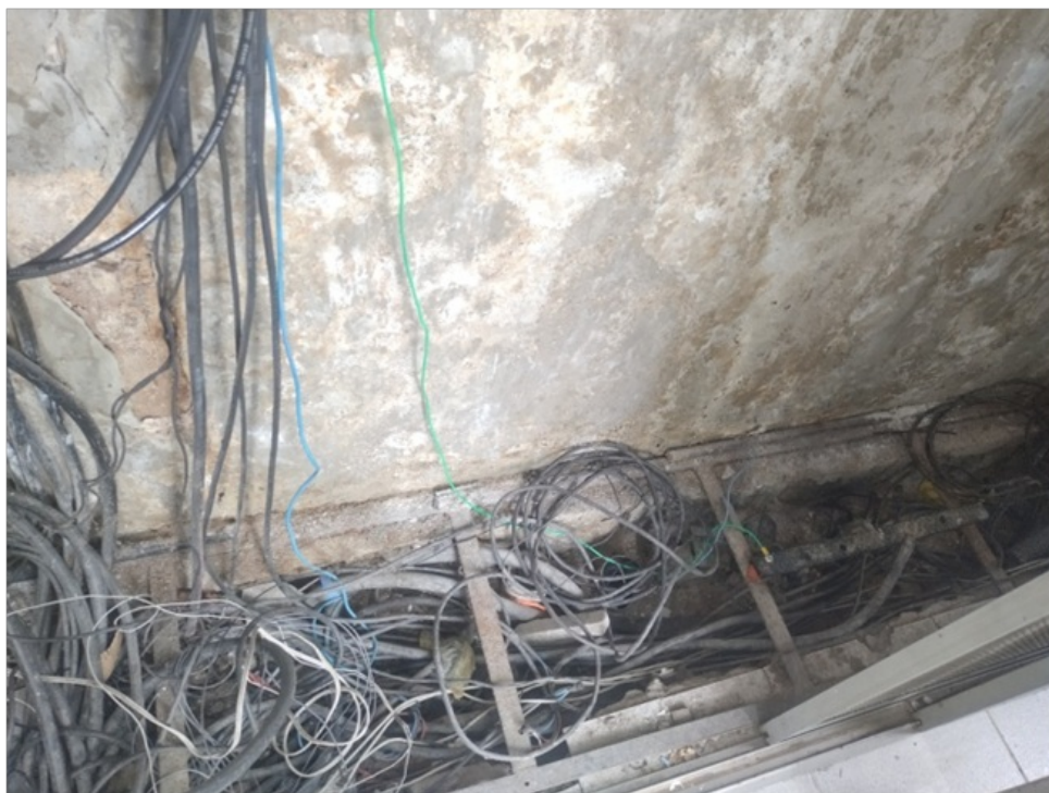
Foto 13 – Fiação próxima ao quadro de elétrica
