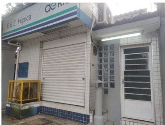
Foto 6 – Abrigo quadros elétricos de comando
