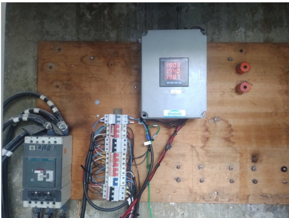
Foto 12 - Quadro de Energia Elétrica
